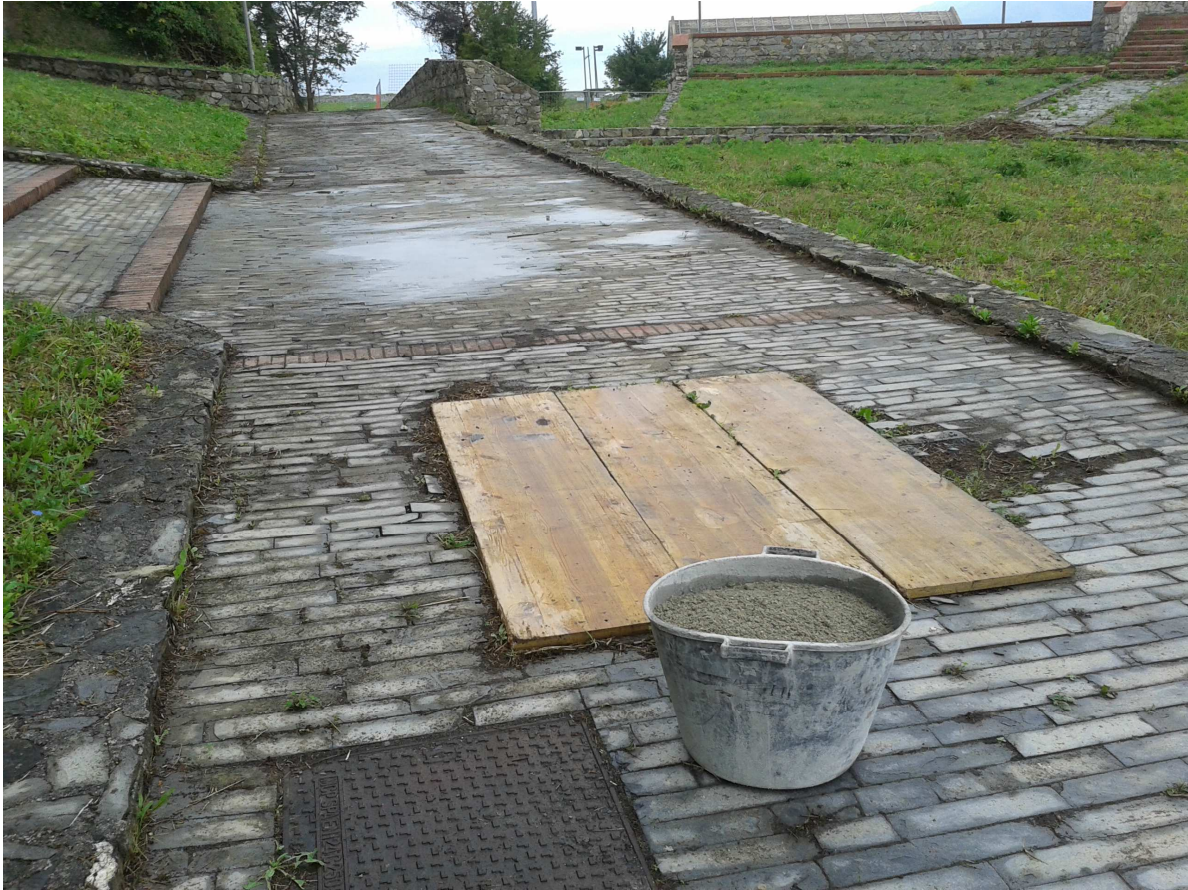
Messa in sicurezza di pozzetti scoperti con assi provvisorie — prima dei lavori
