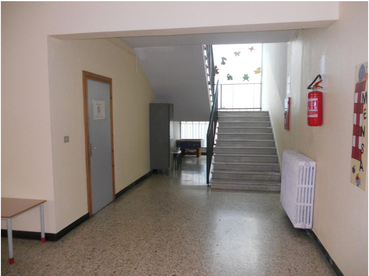
Foto n. 5 – Vista della prima rampa della scala che dovrà diventare a prova di fumo: la porta a sinistra dovrà essere sostituita con porta REI 60 e, a fianco, aperto un nuovo passaggio
