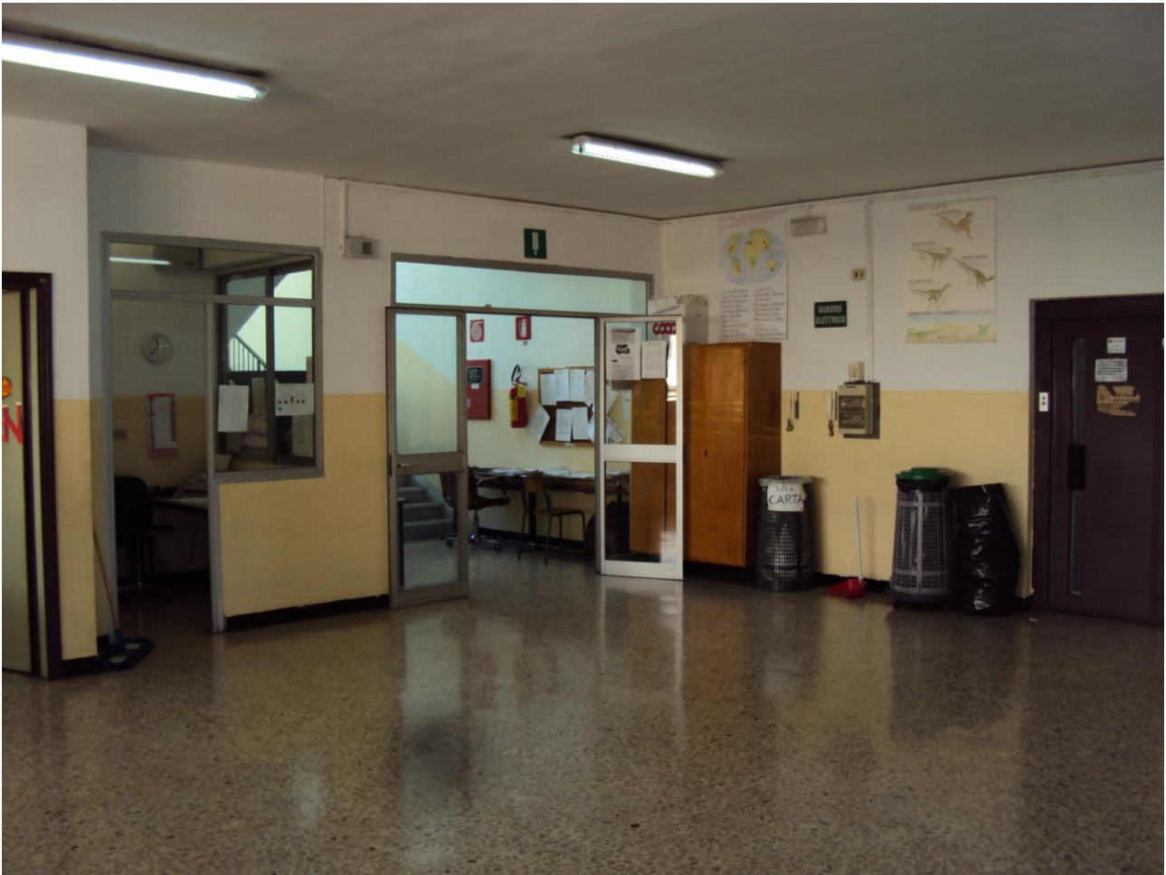
Foto n. 6 – Vista dell'atrio ai piani correnti: il serramento della scala deve essere rimosso e realizzato un filtro in muratura con porte REI 60; le vetrate del locale del personale prospicienti la scala chiuse con parete REI 60.
