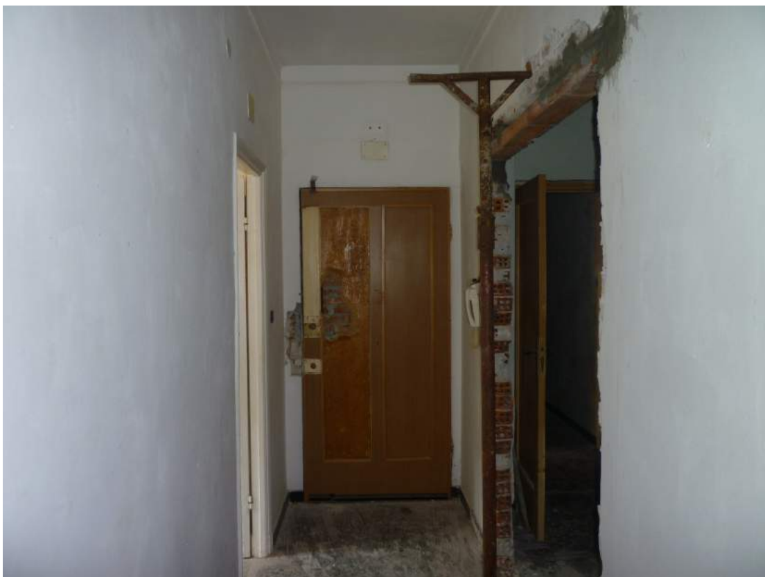
Locale 06 – l'ingresso murato dell'interno 13 e il collegamento temporaneo di cantiere tra le due unità
