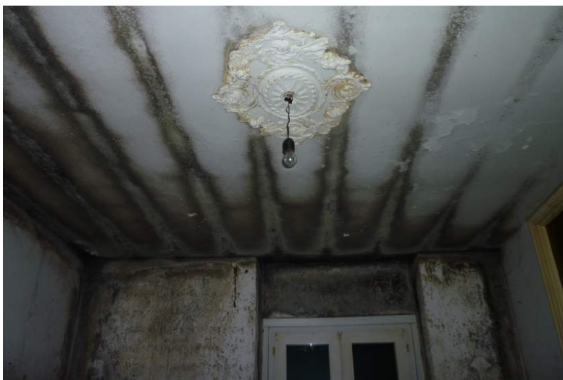
Locale 01 - lo stato di degrado sia a parete che a soffitto del soggiorno
