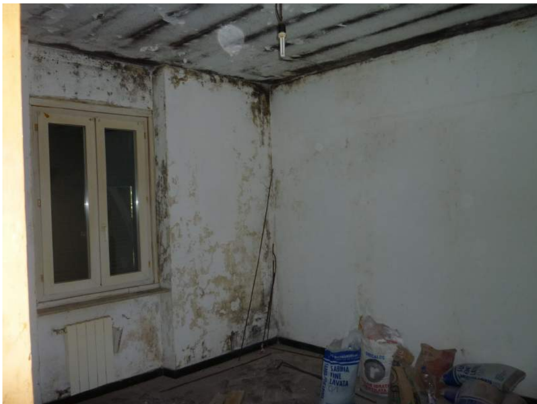
Locale 05 – la camera con evidenti segni di muffa a soffitto e parete
