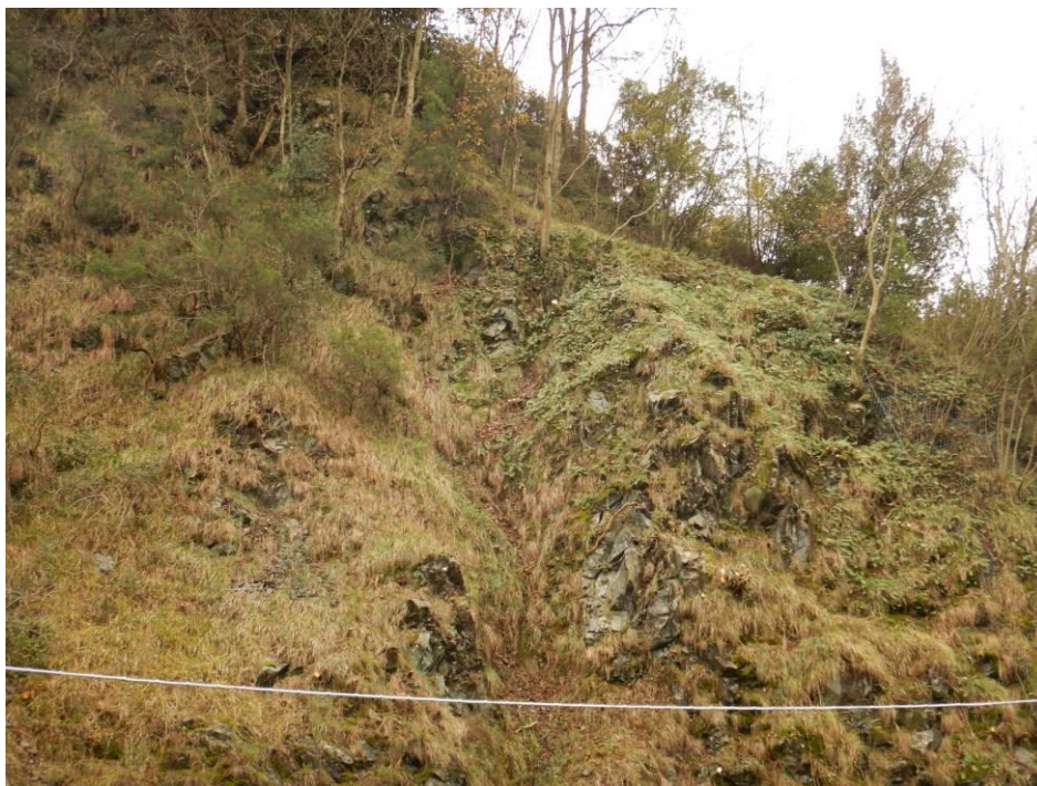
Foto 2 – Nel primo settore verso sud il versante si presenta con pareti rocciose sub-verticali (foto dopo pulizia e disgaggio)
