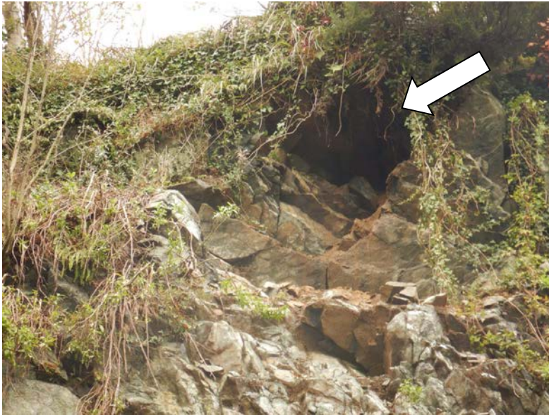
Foto 2 a-e- Foto sopralluogo del 6/7 nov. 2018 che mostrano (indicata con freccia) la zona di distacco della massa lapidea crollata dalla parete rocciosa in fregio alla strada nel settore più settentrionale del tratto in esame. Nelle foto c-d è indicata con freccia la stessa porzione di fronte individuata nel corso dei rilevamenti condotti in Val Varenna nel settembre 2017 in cui si nota ancora in posto la massa lapidea poi franata in questa occasione
