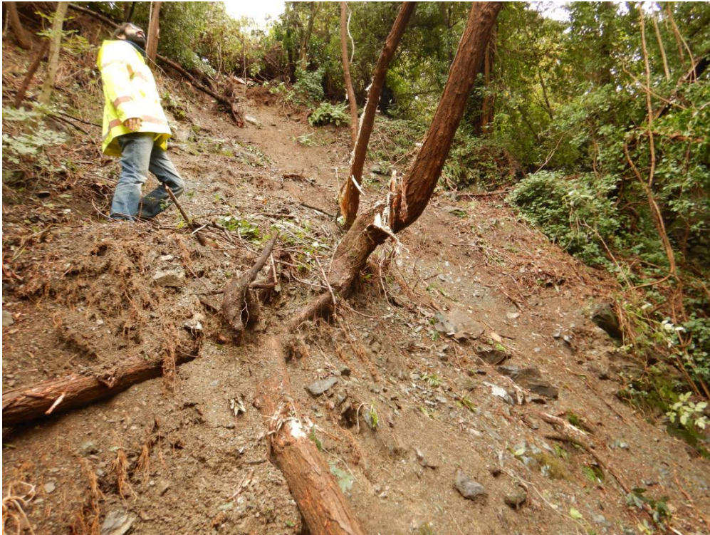
Foto 6 – Lizza di frana e ciglio di distacco nella parte apicale del settore di versante in frana a monte della strada
