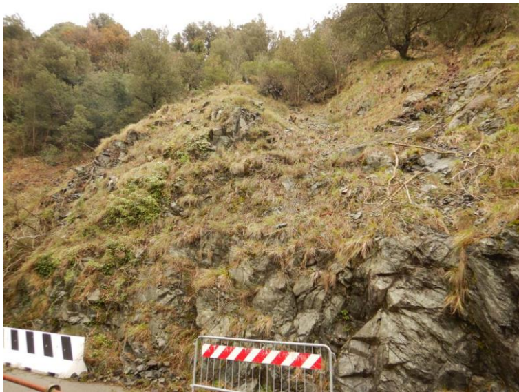
Foto 3 a-b– Poco oltre le pareti sub-verticali lasciano il passo a versanti relativamente meno acclivi, ancora in dissesto e con tratti a strapiombo a ridosso della strada (foto dopo intervento di pulizia e disaggio)
