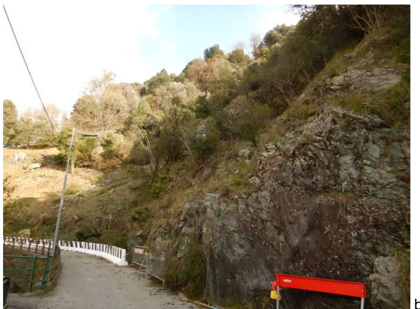
Foto 4 a-b – Il settore centrale a monte della strada (dopo pulizia e taglio vegetazionale) dal quale si sono staccati i massi di Foto 1
