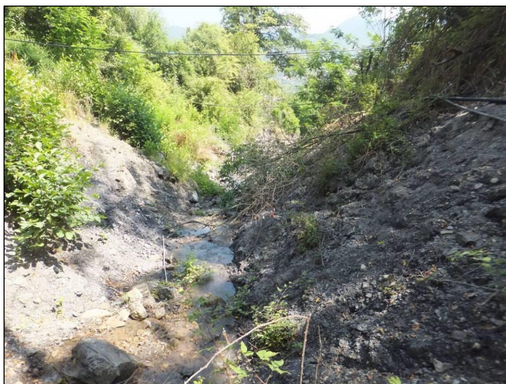
Foto 19: dalla progr. P0 verso valle. Sponda dx in dissesto.
