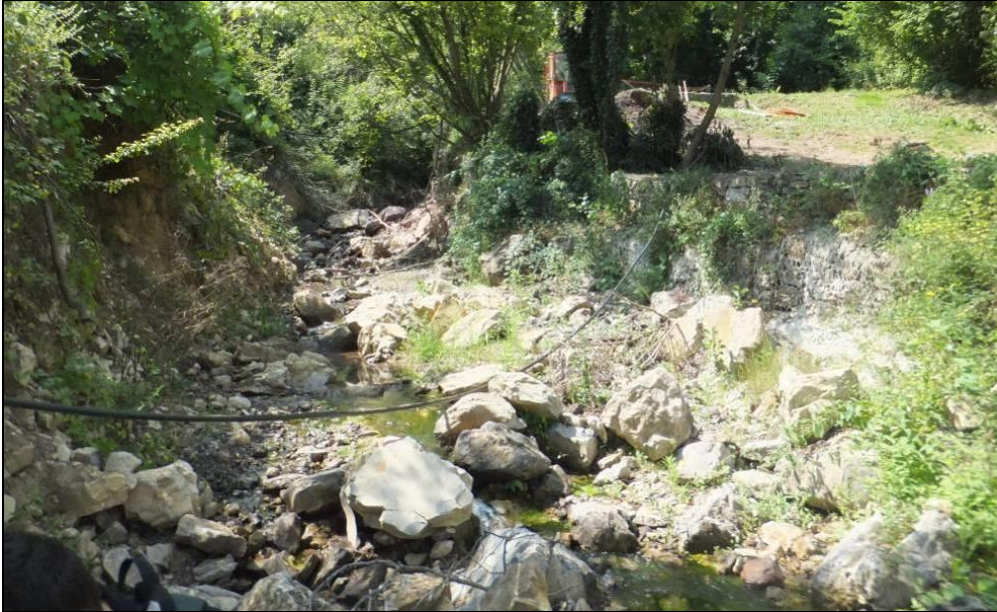
Foto 14: da progr. 93 verso monte. Persiste dissesto in sponda dx e sovralluvionamento
