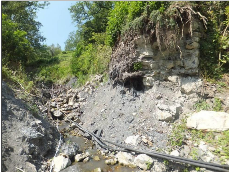
Foto 22: da progressiva 70 m verso monte. Struttura relitta in sponda sx. Probabile resti di una briglia distrutta dall'evento alluvionale.
