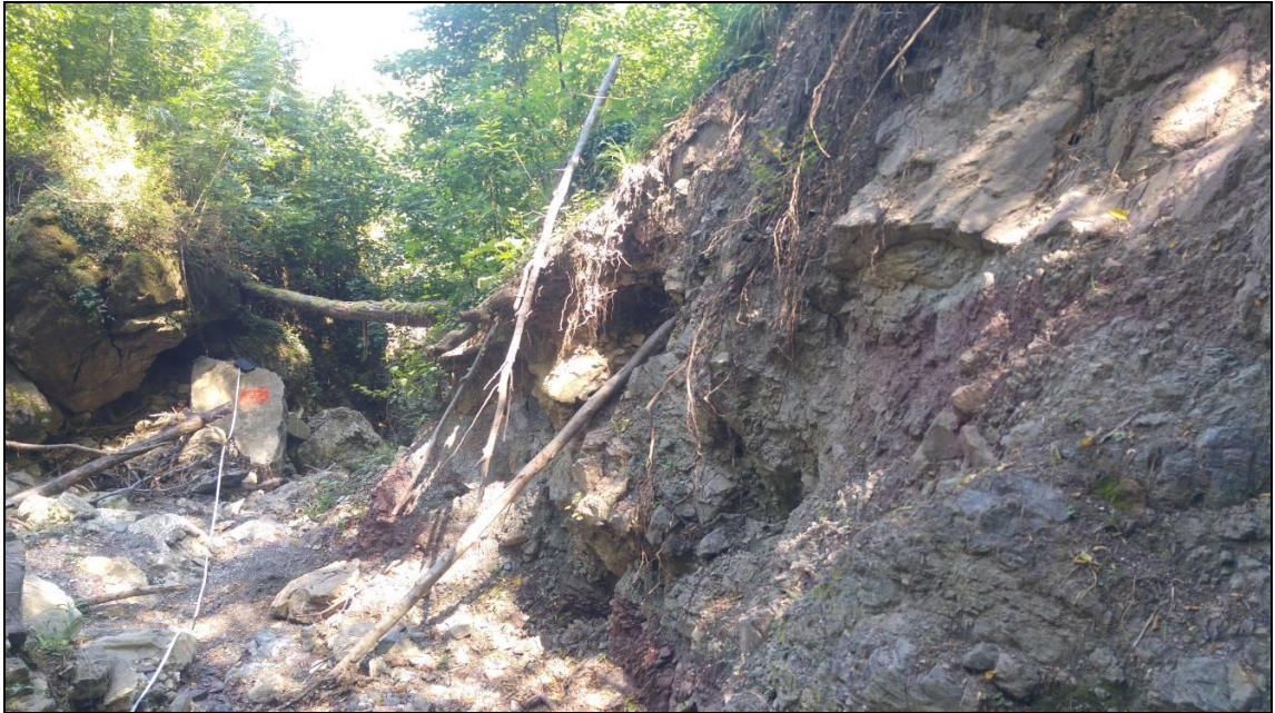
Foto 5: da progr. 116 verso valle – sponda dx in dissesto/erosione
