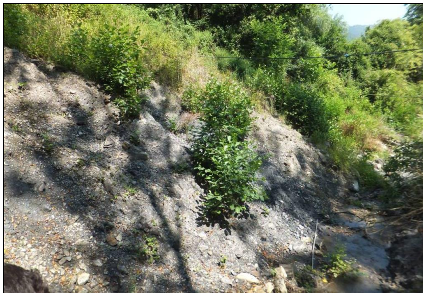
Foto 18: dalla progr. 74 verso valle. Sponda sx in dissesto.
