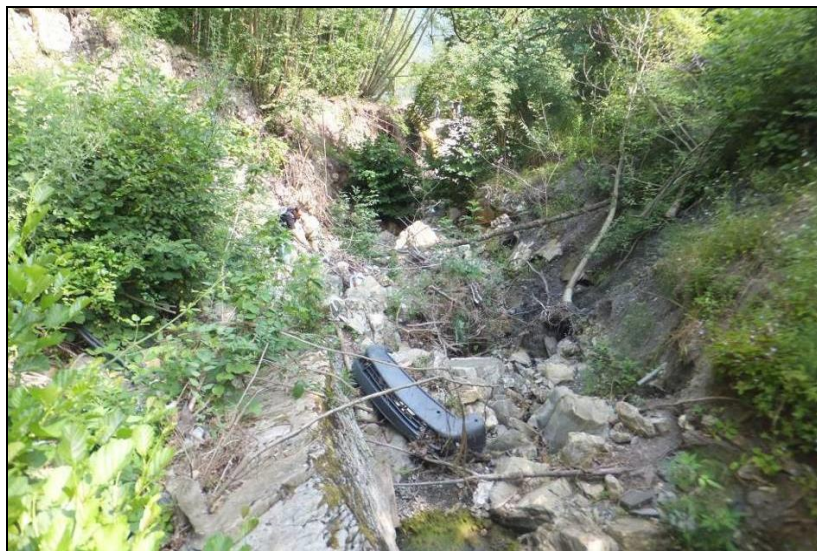
Foto 11: Sponde in dissesto ed alveo sovralluvionato
