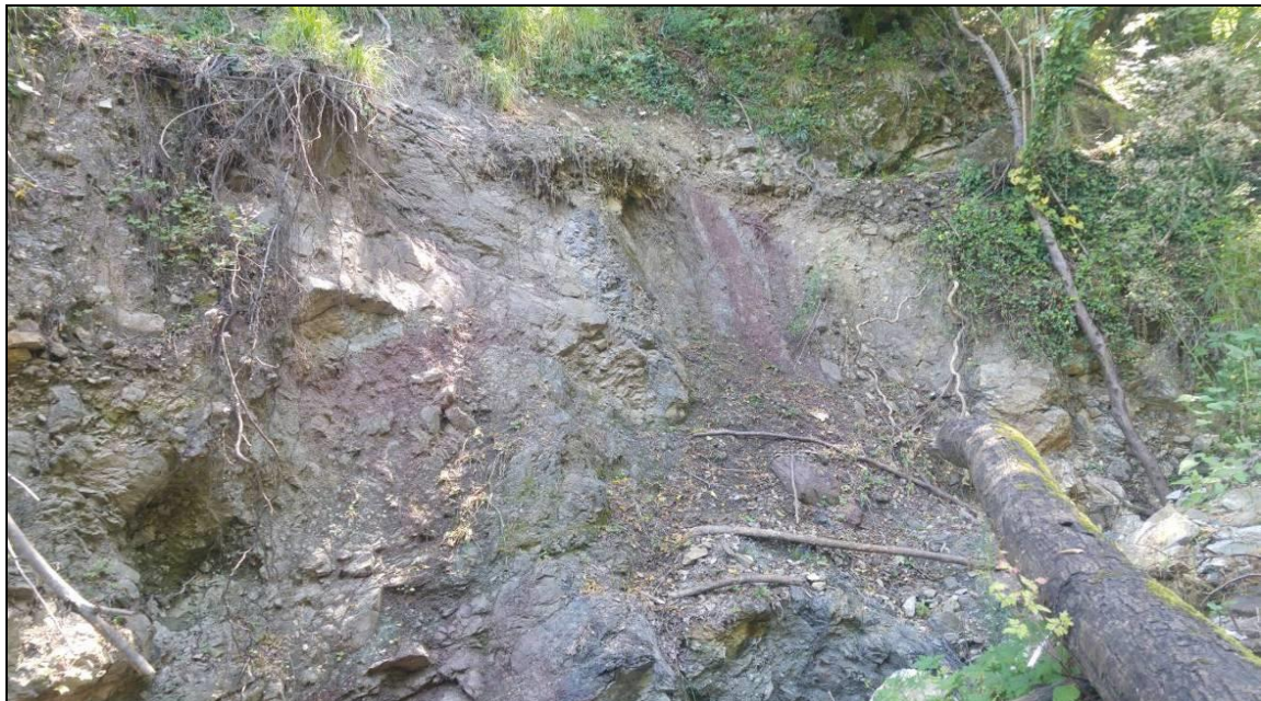
Foto 4: tra progr. 116 e 125 m. Sponda dx in frana. Affioramento di Argilliti alterate
