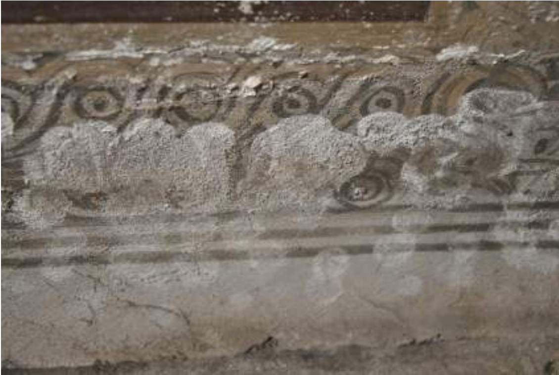
Img. 16 – DSC_0625: efflorescenze saline secondo forme circolari nell'angolo sud-ovest.
