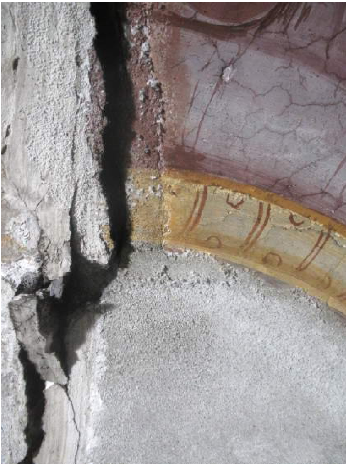
Img. 18 – IMG_0002: angolo nord-ovest, rifacimento dell'ovale con malta simile a quella utilizzata per la stuccatura n.3. Inoltre, è visibile la stuccatura n.2 sopra al rifacimento e sopra alla stuccatura n.3.
