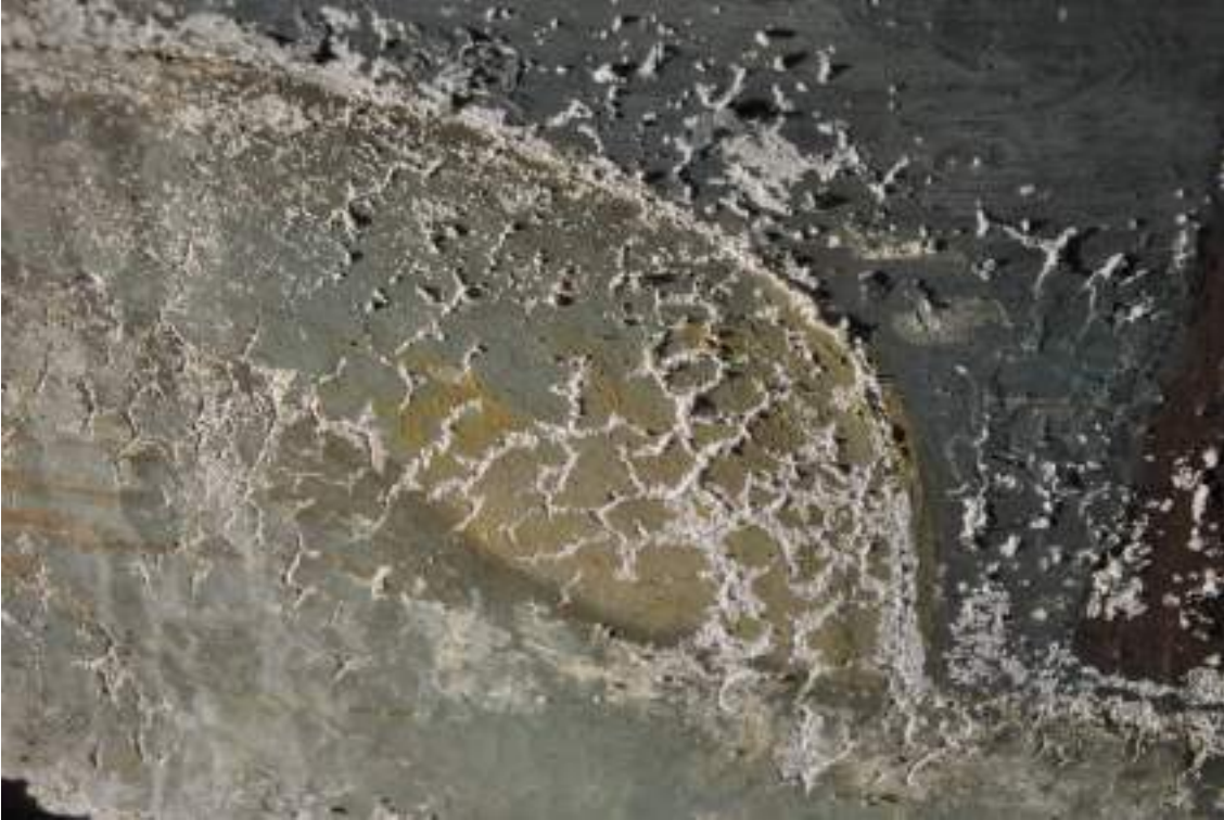
Img. 14 – DSC_0605: efflorescenze in corrispondenza della crettatura.
