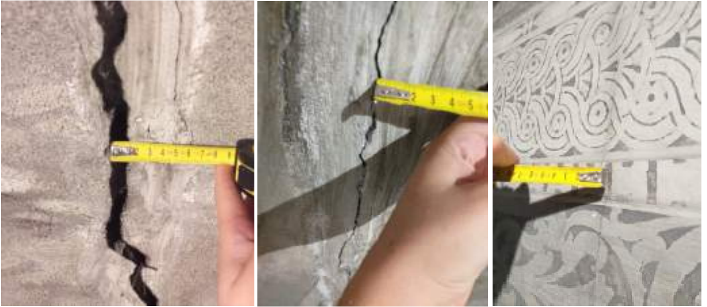
Imgg. 1, 2, 3 – foto_01, foto_02, foto_03: da sinistra a destra fotografie dell'ampiezza decrescente delle fessurazioni: ampia, media, sottile.
