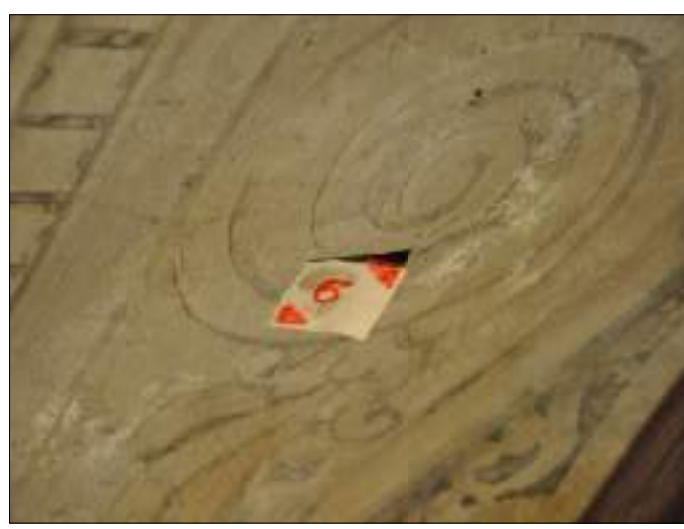
2 DSC_0655: angolo sud-ovest, i sali sono puntiformi e sono visibili sollevamenti della finitura (sub-efflorescenza) (campione n.6)
