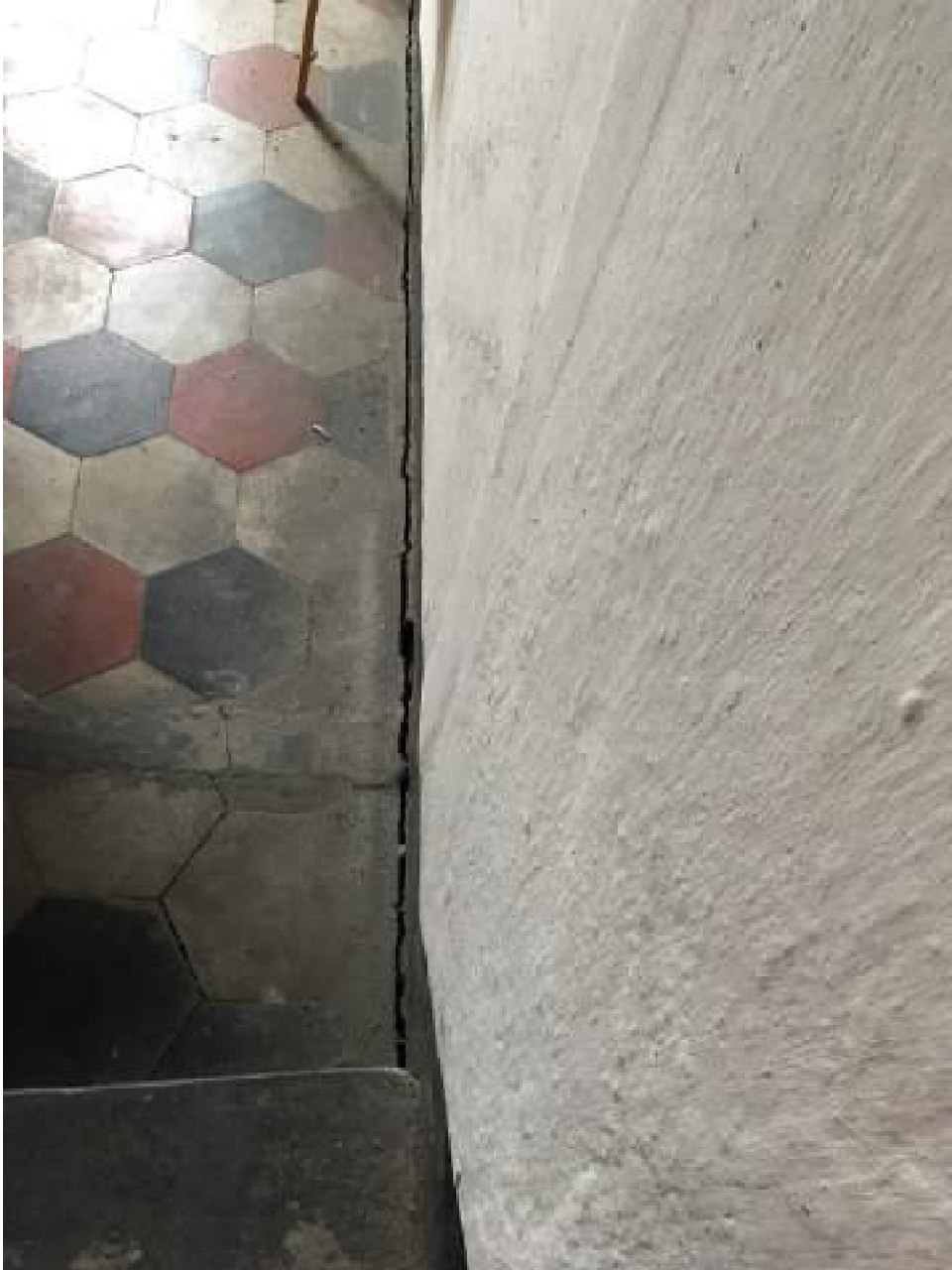
Img. 22 – IMG_6185: piano sottotetto, locale sovrastante il salone nobile, sconnessione del pavimento
