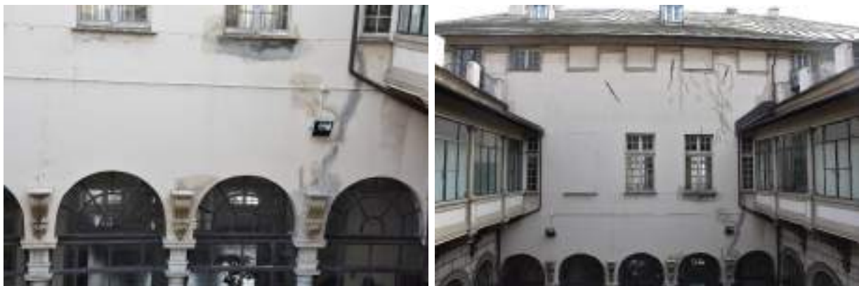
Figura 8. Viste dal cortile interno della parete sul retro dell'edificio storico e del suo quadro fessurativo
