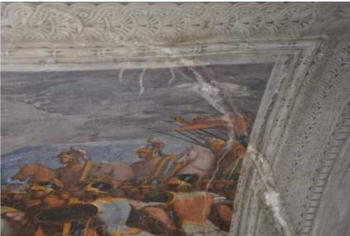
Img. 17 – DSC_0723: colature e efflorescenze saline dovute a pregresse infiltrazioni nella specchiatura nord.
