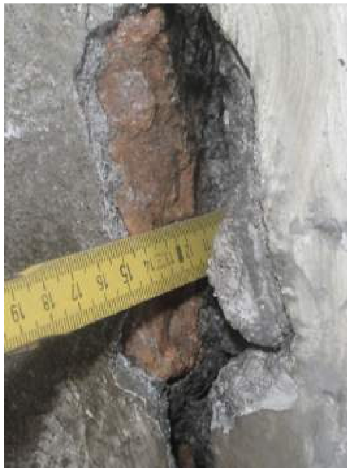
Imgg. 4 – DSC_0032: ampia e profonda fessurazione nell'angolo sud-est. Sono visibili mattoni di riempimento, forse frutto di un intervento di rifacimento.
