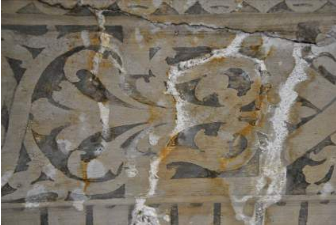
Img. 20 – DSC_0717: cornice superiore alla specchiatura nord, fessurazione, efflorescenze saline, colature e macchie da colatura di tannino.
