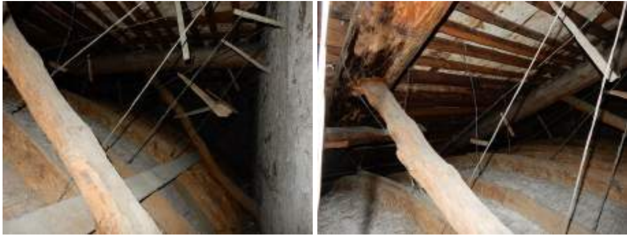
Figura 11. Immagini dell'estradosso della volta in canniccio del Salone Barabino e dell'orditura lignea del solaio soprastante
