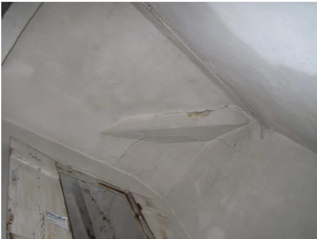
Figura 45. Lesioni del controsoffitto in corrispondenza di trave cantonale.
