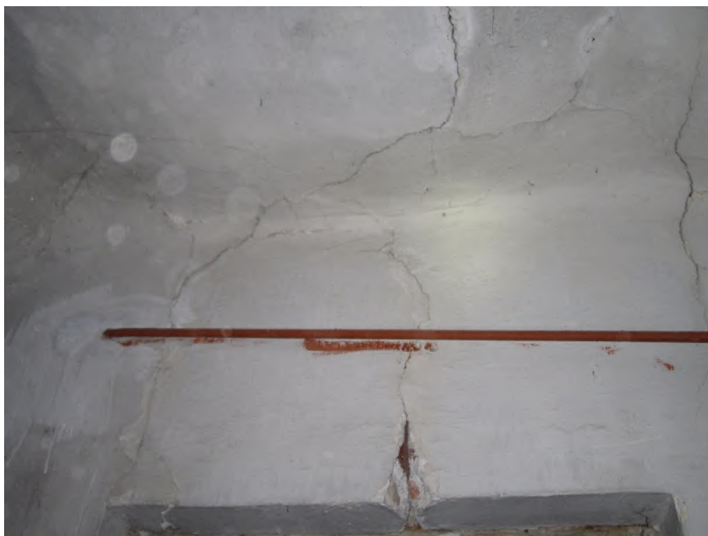
Figura 47. Lesioni nel controsoffitto diffuse.
