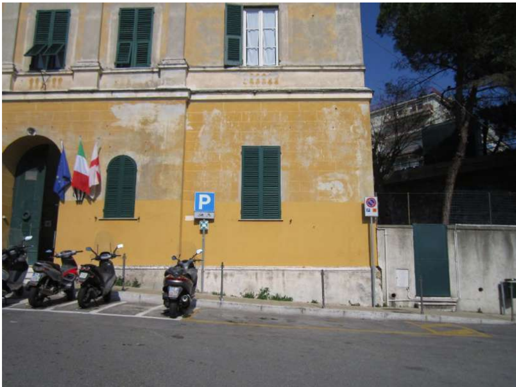
Figura 5. Particolare muro esistente a destra della facciata principale a delimitazione del giardino privato.
