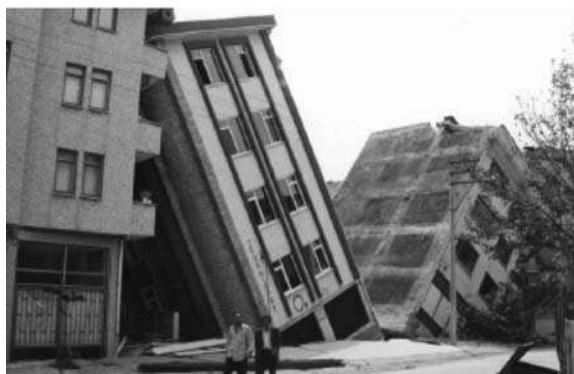
FIGURA 1. ESEMPI DI ROTTURE PER SUPERAMENTO DELLA CAPACITÀ PORTANTE DI FONDAZIONI SUPERFICIALI AD ADAPAZARI
