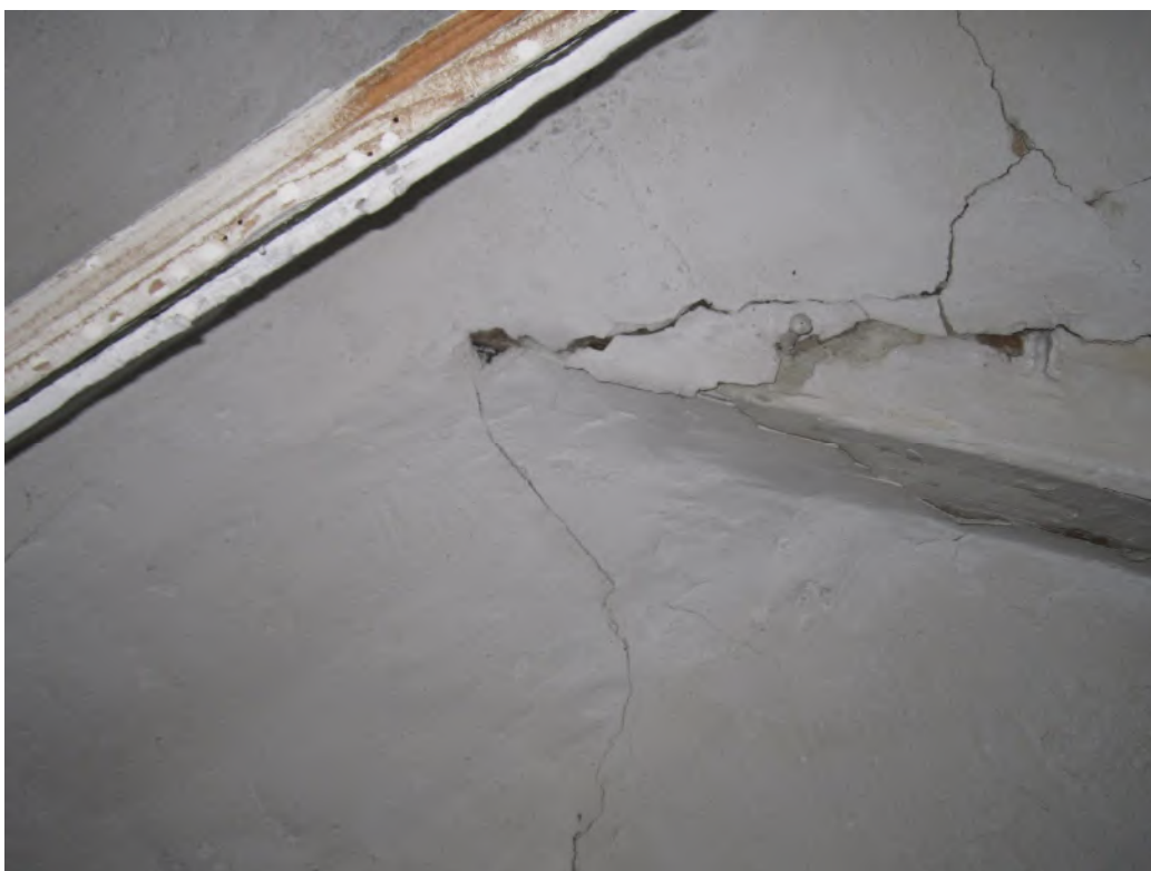
Figura 46. Particolare di lesioni del controsoffitto in corrispondenza di trave cantonale.
