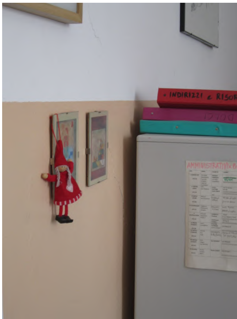
Figura 39. Lesione su parete portante centrale piano primo lato uffici, andamento inclinati inferiore
