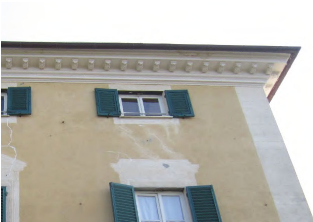
Figura 49. Evidenziazione di macchie di umidità nel cornicione.
