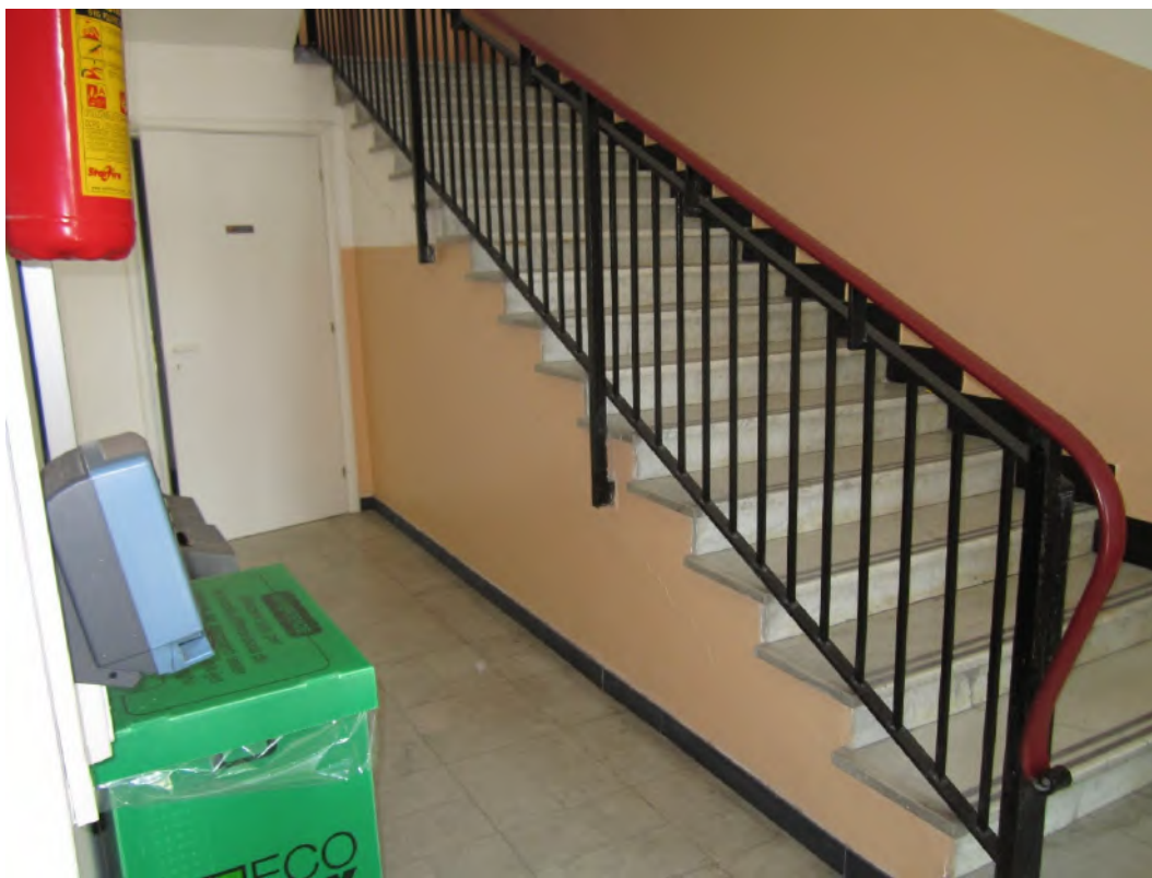
Figura 33. Lesione scala parallela alla soletta in cls armato della rampa.
