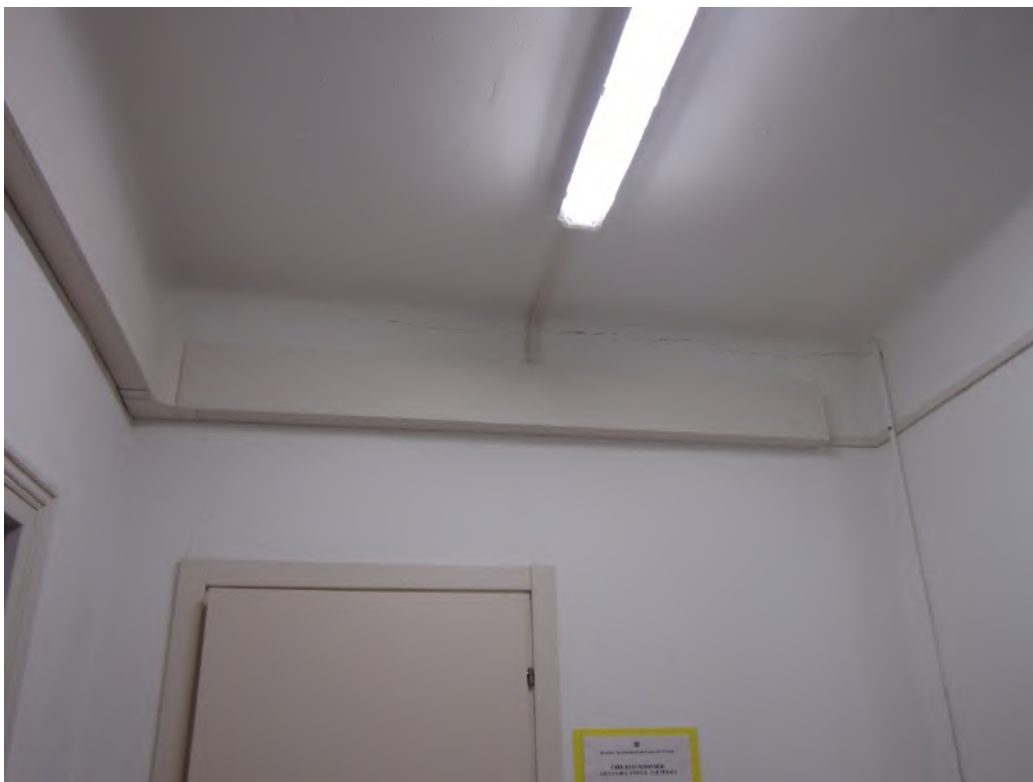
Figura 40. Particolare lesione perimetrale a soffitto
