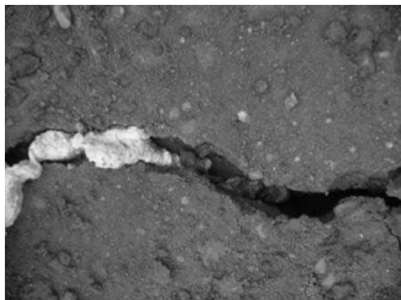
FIG. 19: TERRENO CON CREPE A SEGUITO DELL'ESPANSIONE DEL MATERIALE D'INIEZIONE
