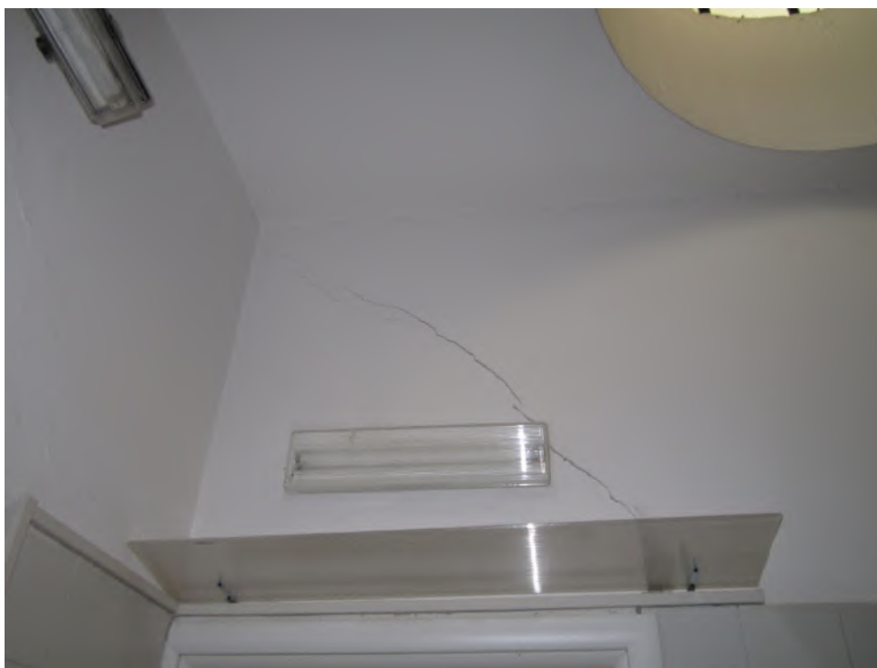
Figura 31. Lesione piano terra interno ai servizi igienici (11E - passante) su architrave di tamponamento
