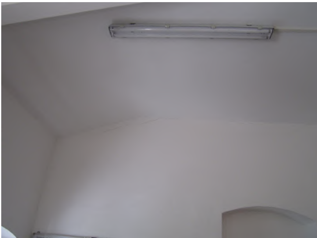
Figura 42. Particolare lesioni a soffitto perimetrali.
