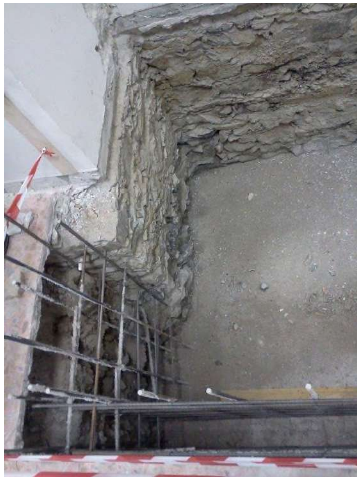
Fotografia particolare relativo allo scavo eseguito per l'esecuzione della fossa dell'ascensore, da cui si può vedere la tessitura muraria portante in pietra
