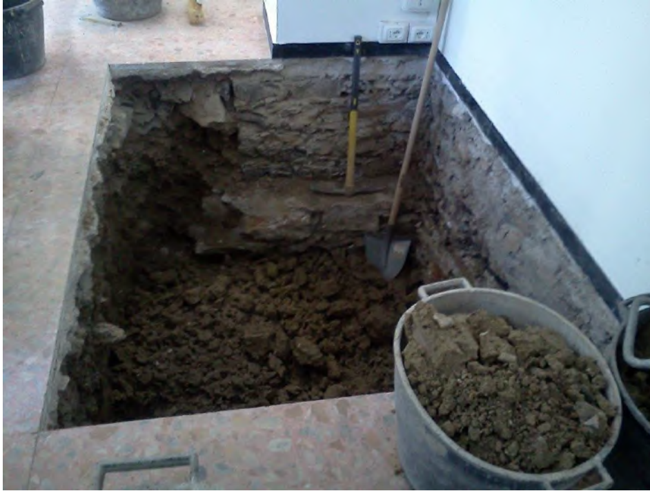
Figura 10. Fotografia relativa allo scavo eseguito per l'esecuzione della fossa dell'ascensore, da cui si può vedere la tessitura muraria portante in pietra
