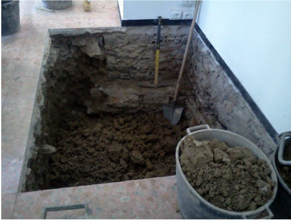
Fotografia relativa allo scavo eseguito per l'esecuzione della fosse dell'ascensore, da cui si può vedere la tessitura muraria portante in pietra
