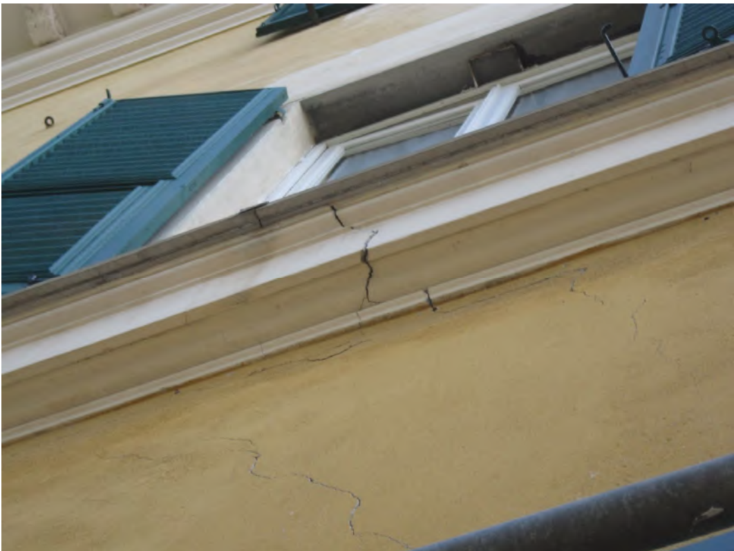
Figura 20. Lesione stuccata inclinata sull'architrave sul prospetto sud-ovest.
