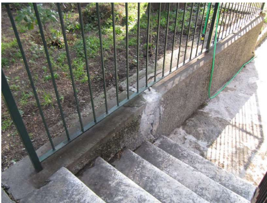
Figura 26. Apertura giunto tra scala e muro.
