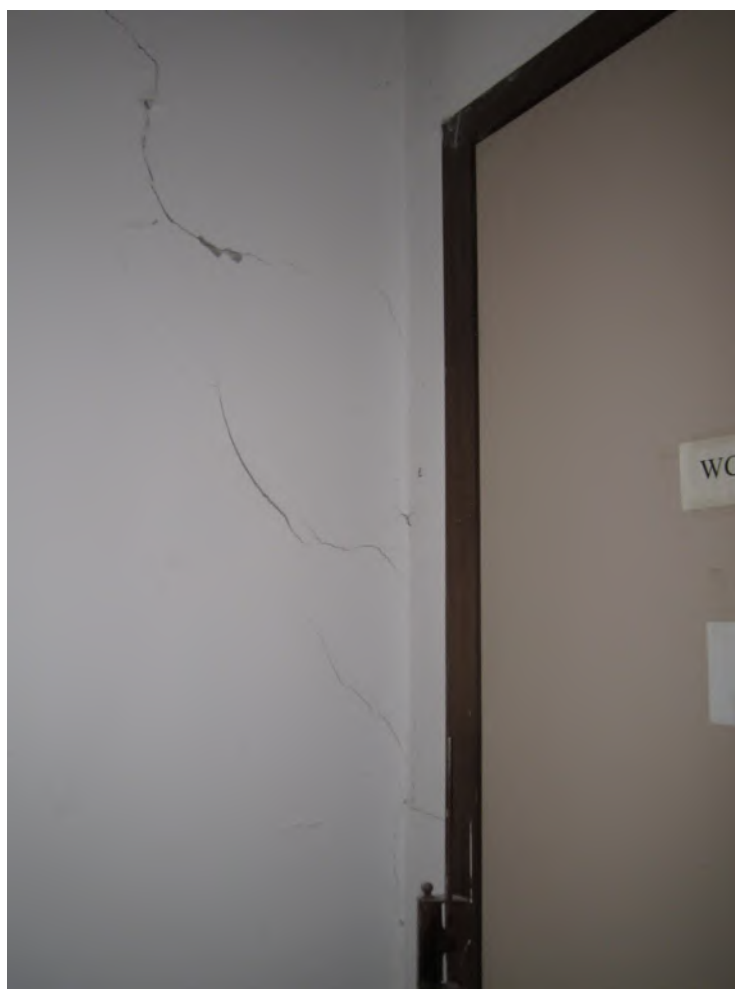
Figura 32. Lesione piano terra interno ai servizi igienici (10E) su tamponamento.
