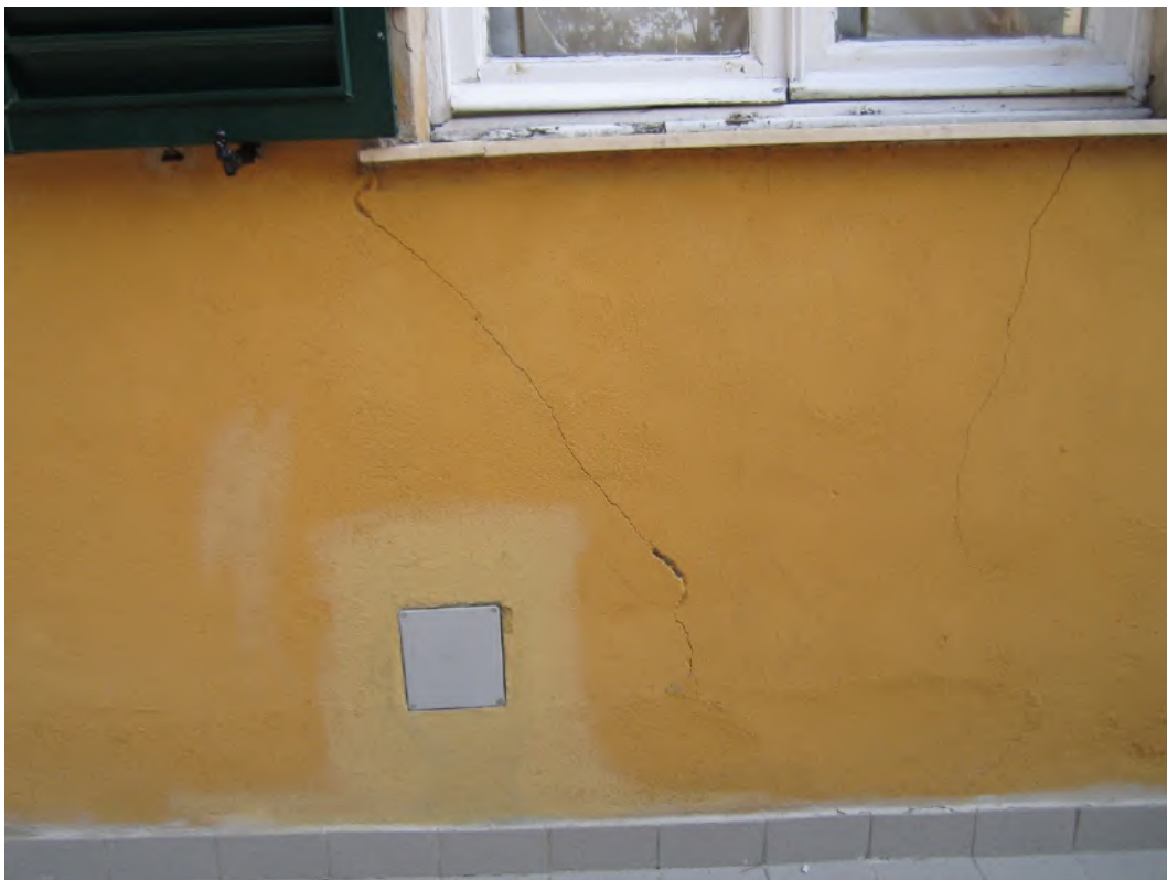
Figura 21. Lesione inclinata sul parapetto di bucatura sul prospetto sud-ovest.
