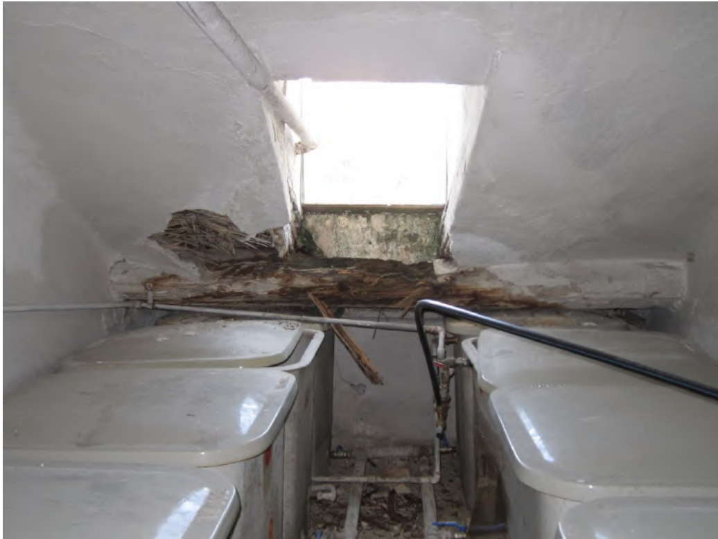
Figura 48. Degrado di elemento portante in legno della copertura.
