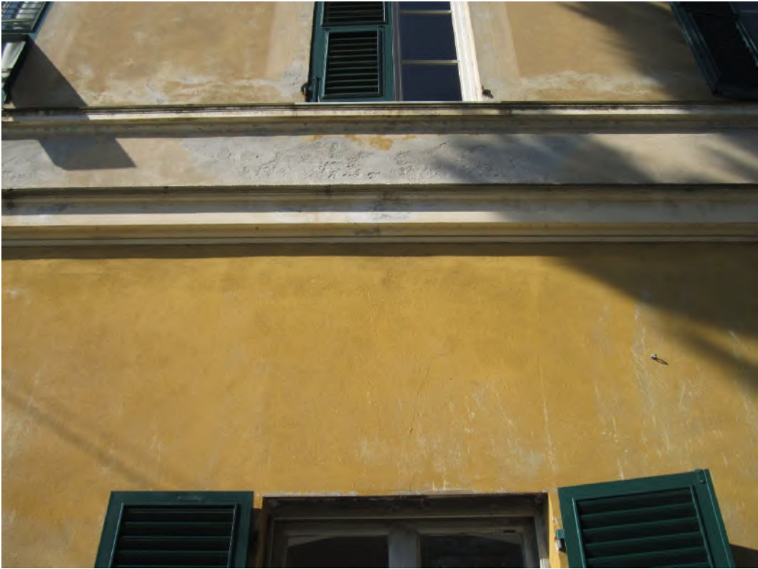
Figura 19. Lesione inclinata sull'architrave sul prospetto nord-est.
