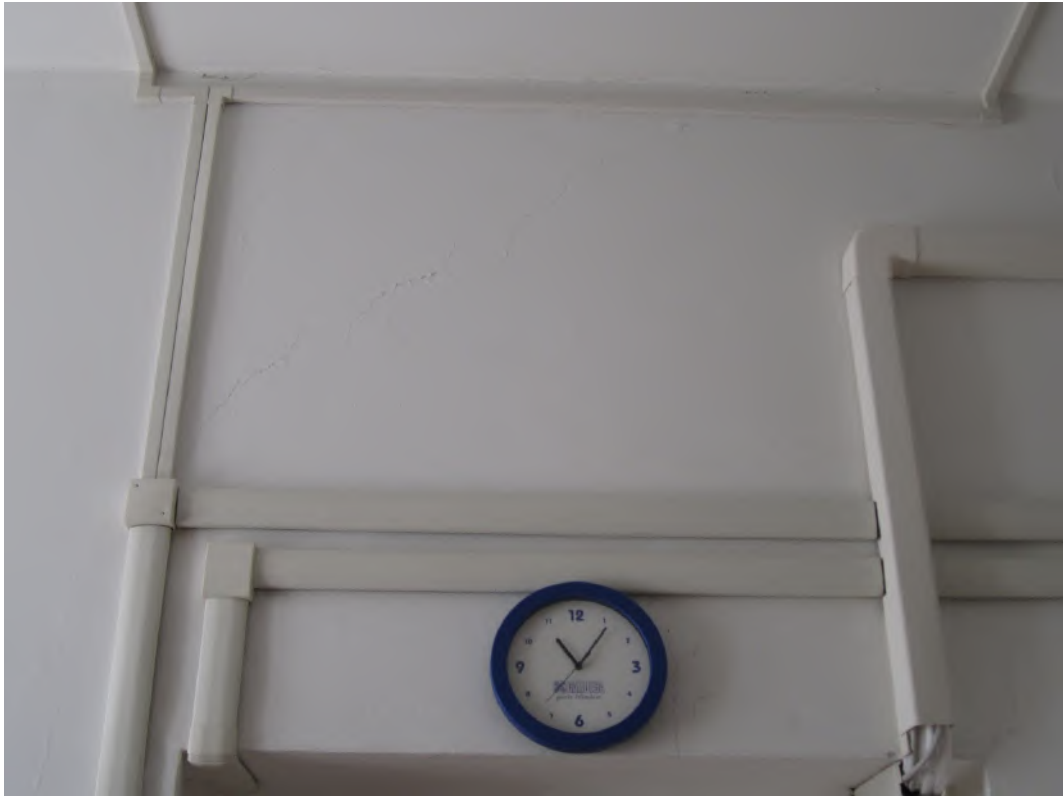
Figura 36. Lesione piano primo (5F) su architrave in muro portante.
