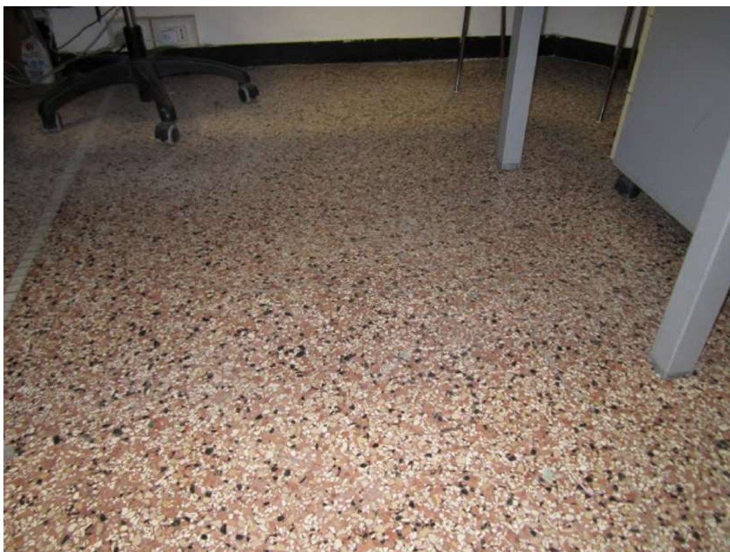
Figura 34. Particolare lesioni pavimentazione.
