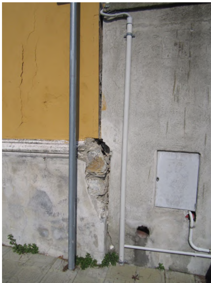
Figura 24. Apertura del giunto tra muro esterno ed edificio.
