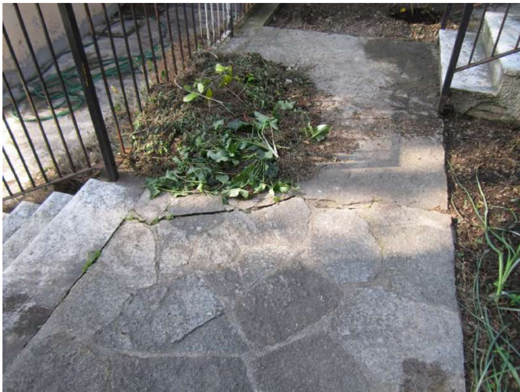
Figura 25. Lesione disallineata nella pavimentazione esterna
