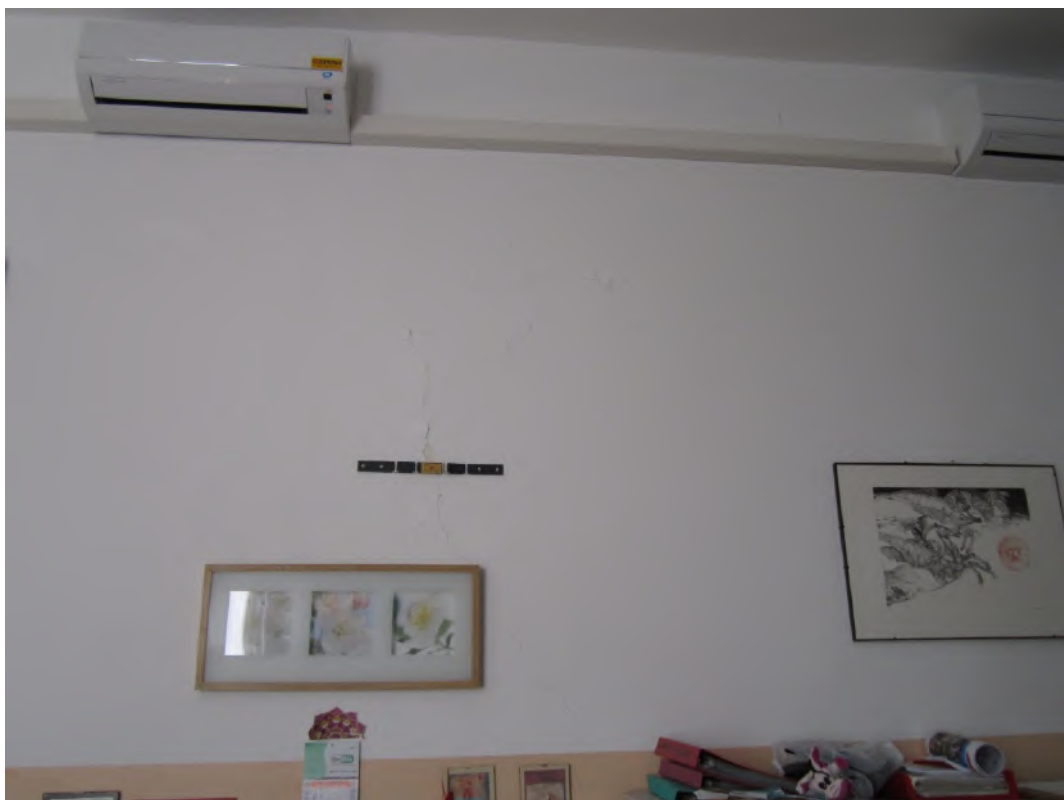
Figura 38. Lesione su parete portante centrale piano primo lato uffici
