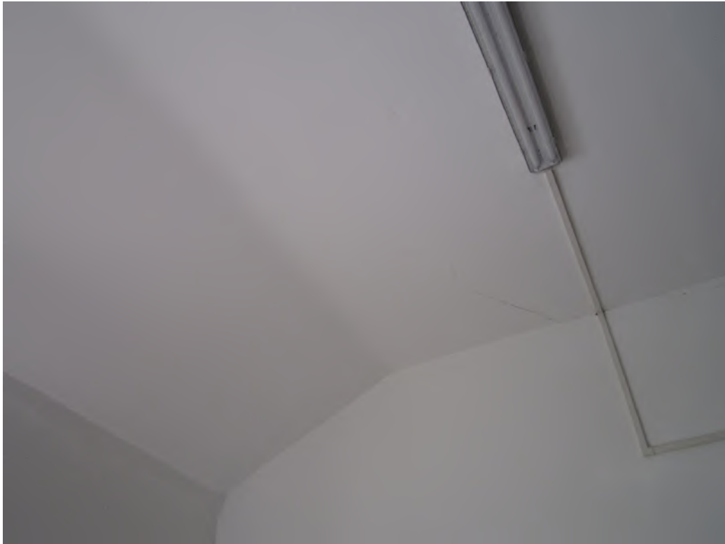
Figura 41. Particolare lesione a soffitto.
