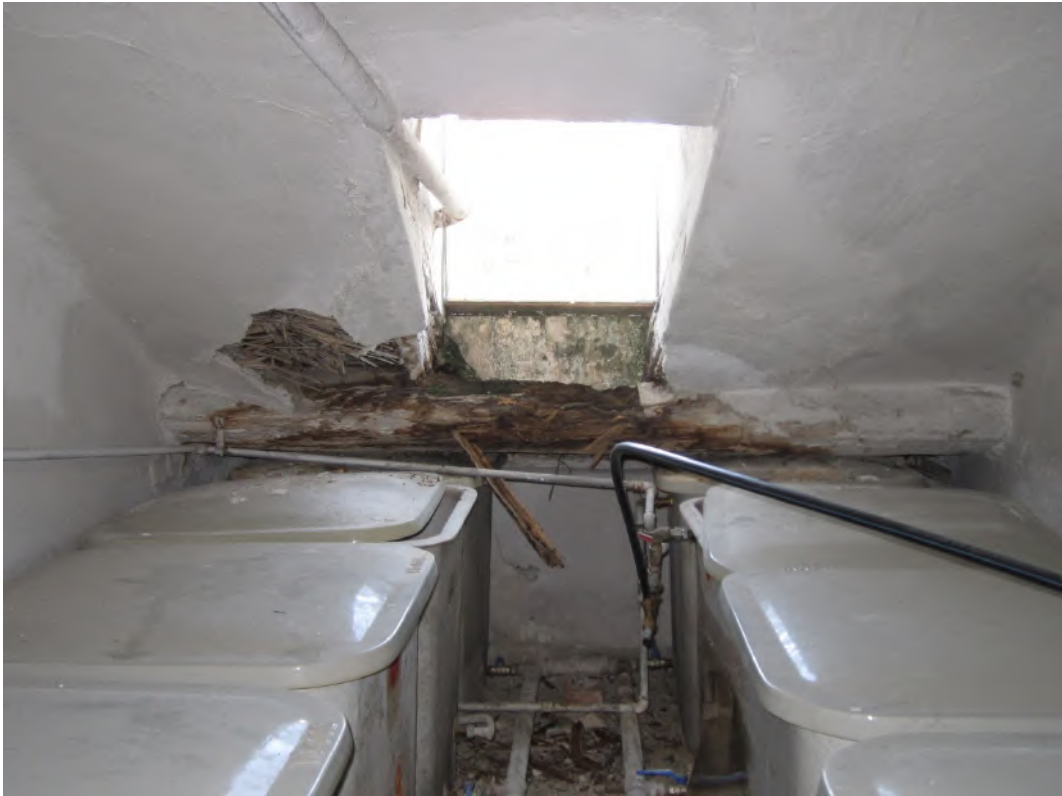
Figura 16. Particolare stato di conservazione della struttura in legno della copertura in corrispondenza di uno dei due abbaini presenti lato nord-ovest, la quale risulta molto danneggiata da infiltrazioni d'acqua
