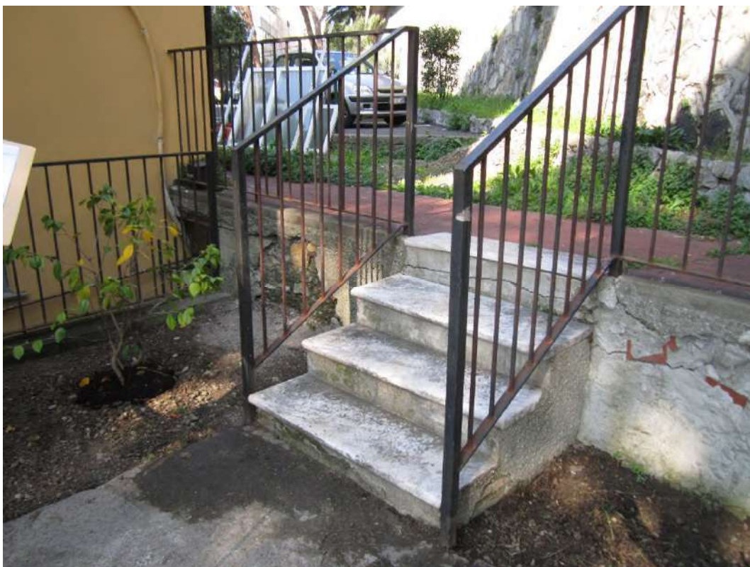
Figura 28. Lesioni muretto di contenimento.
