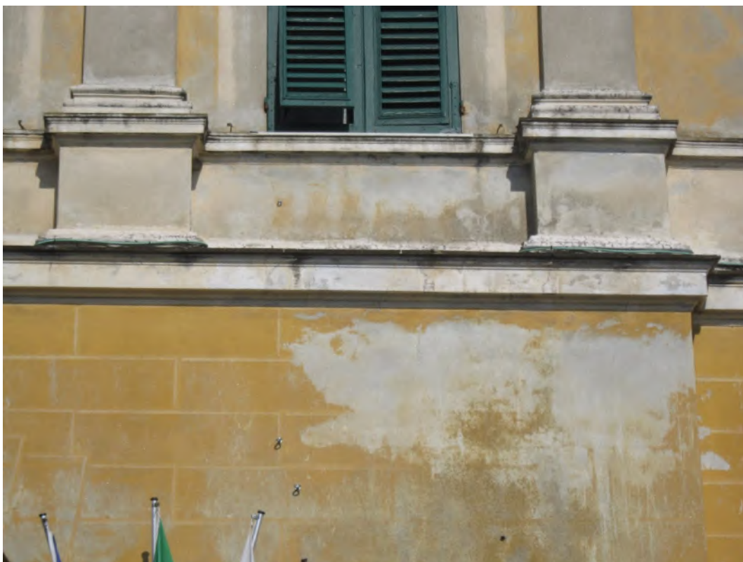
Figura 22. Lesioni inclinate ramificate su architrave sul prospetto sud-est.
