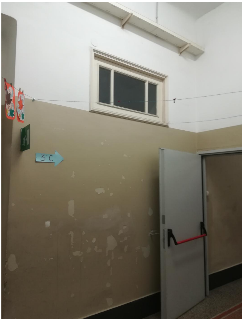
Foto n. 6 – Filtro a prova di fumo lato levante secondo piano: finestra alta da rimuovere e tamponare con muratura EI 90.
