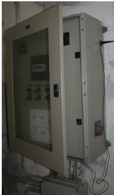
Fig. 3.3.2 – quadro elettrico interno centrale termica.
