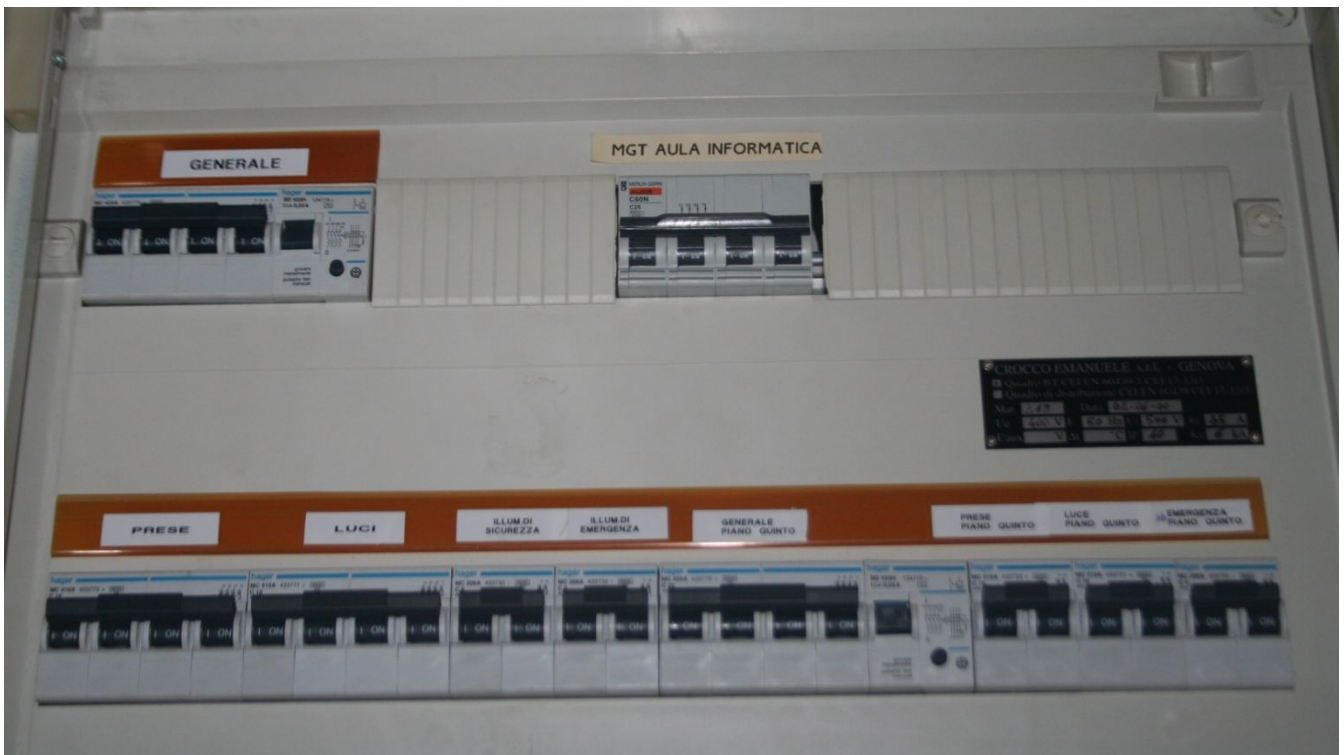
Fig. 3.1.1 – Tipico quadro elettrico di piano con protezione differenziale generale e derivati magnetotermici.
