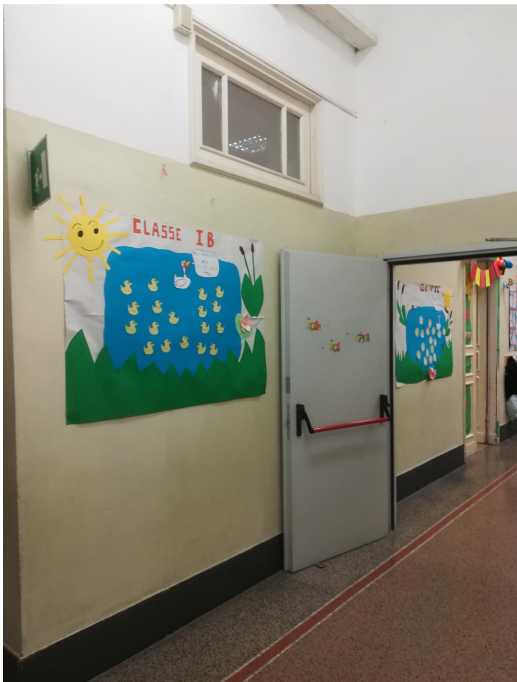
Foto n. 7 – Filtro a prova di fumo lato levante terzo piano: finestra alta da rimuovere e tamponare con muratura EI 90.
