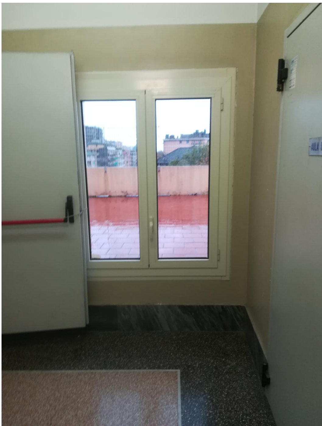
Foto n. 8 – Finestra nel filtro al quarto piano da sostituire con serramento asservito all'impianto di rilevazione incendi
