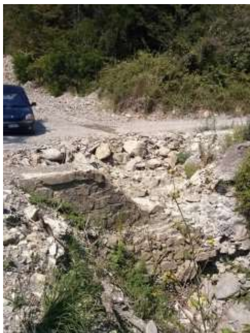
Foto 16 – Briglia erosa in prossimità della confluenza nel Rio Maggiore e dove si prevede la realizzazione della tombinatura, vista da monte (prima degli interventi del lotto 1) e da valle (stato attuale)
