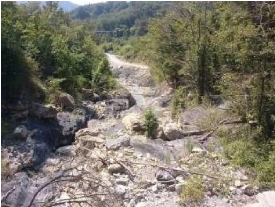
Foto 2 – Rio Maggiore nel tratto a valle della grossa briglia di quota 110. Il corso d'acqua risulta inciso localmente incassato con affioramento del substrato roccioso in argilloscisti.
