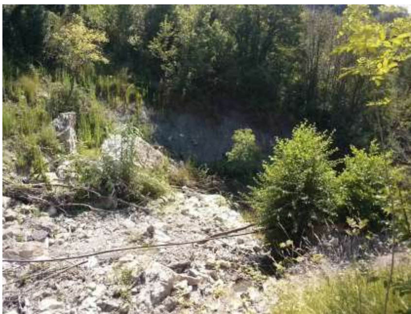
Foto 15 – Sezione in corrispondenza della grossa briglia parzialmente demolita soprattutto in sinistra con il coronamento coperto di detriti e monconi di muri in pietra e malta di dimensioni ciclopiche .
