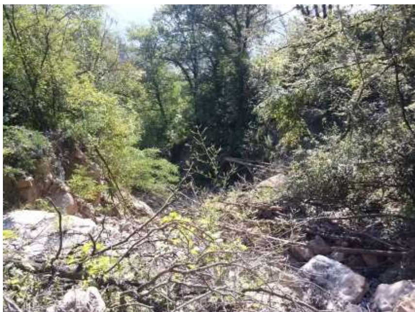
Foto 18 – Il Rio Bastia nella parte alta del tratto oggetto di intervento, in evidente stato di degrado e invasione della sezione idraulica con materiale detritico anche di grande pezzatura.
