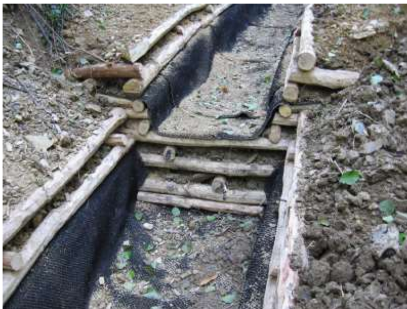
Tipo sezione solco di corrivazione con correnti laterali e trasversali di rinforzo
