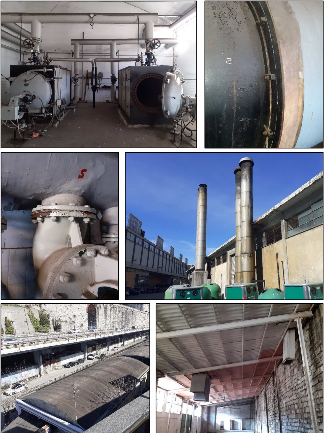
Figura 5. foto esemplificative della tipologia di materiali potenzialmente contenenti amianto
