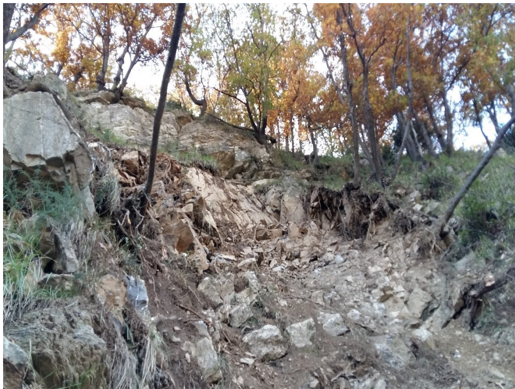
Foto 8 – Nicchia di distacco della frana, con blocchi ancora dislocati e instabili.
