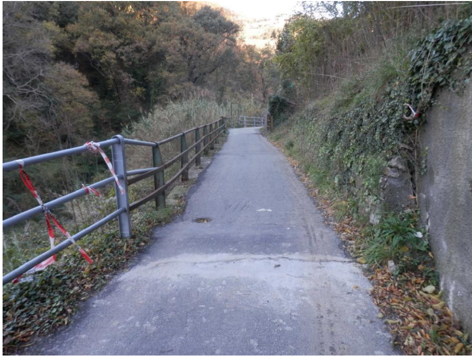
Foto 1 – Cedimento in corrispondenza del lato Sud dell’Intervento 1
