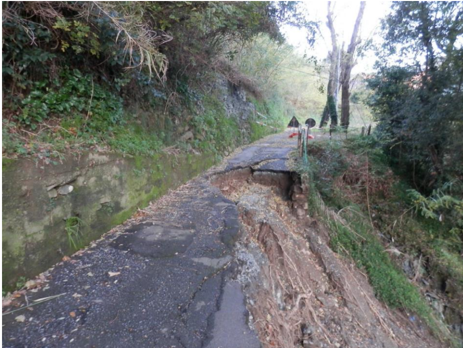
Foto 5 – Particolare del franamento della sede stradale - Intervento 2
