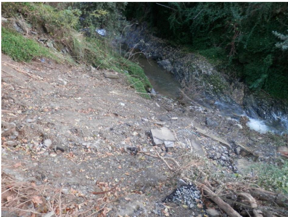
Foto 6 – Corpo di frana sul versante con al piede il Rio San Pietro - Intervento 2
