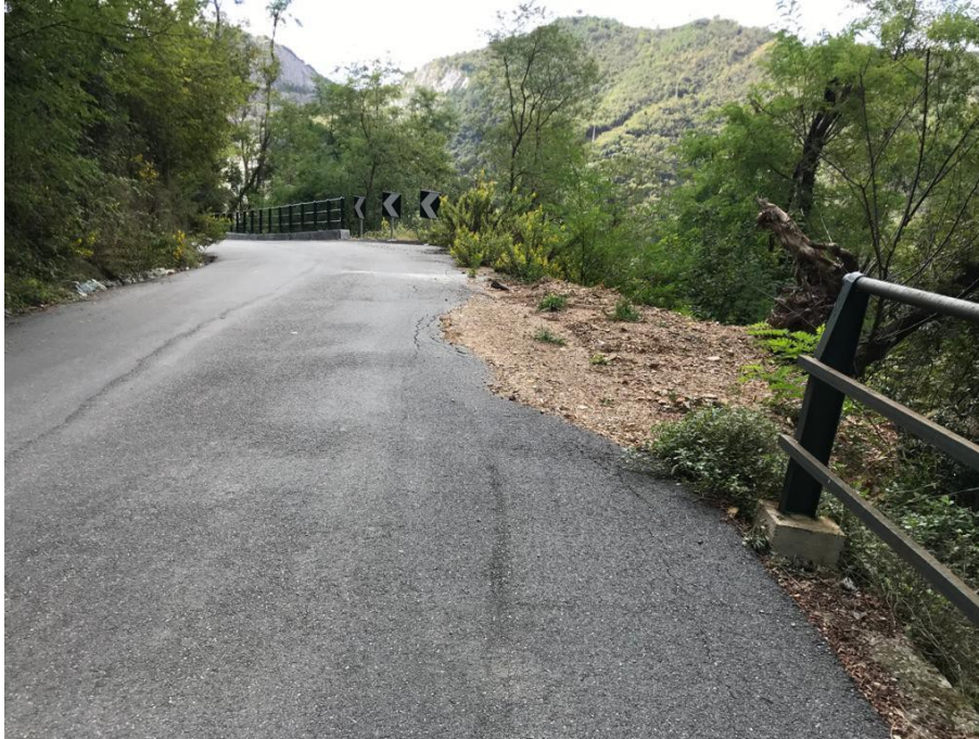
Foto 5: porzione con cedimenti a valle del tratto oggetto di intervento
