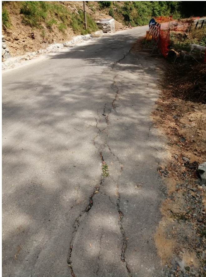
Foto 3: Ulteriori lesioni in carreggiata suggeriscono necessità di prevedere estensione degli interventi a progetto
