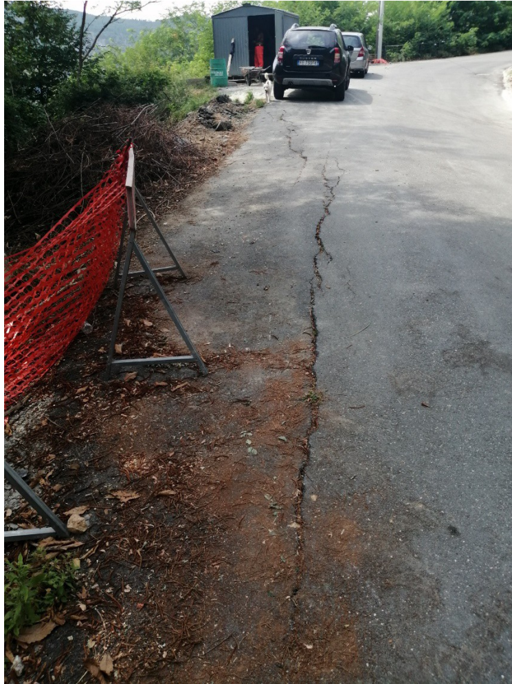
Foto 4: le lesioni proseguono anche a monte del tratto oggetto di intervento
