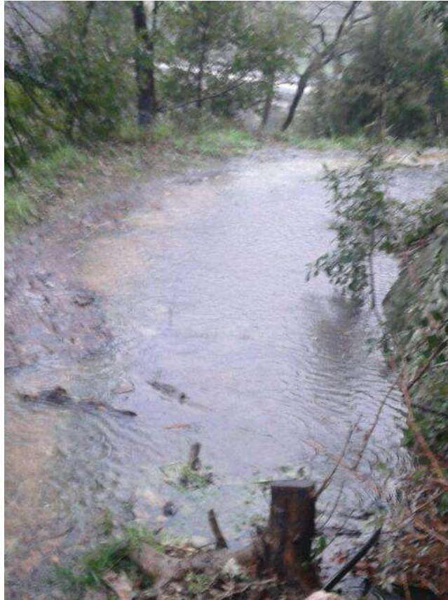
Foto 8 - ristagno di acqua nella condotta a seguito dell'interruzione del canale da parte della frana..
