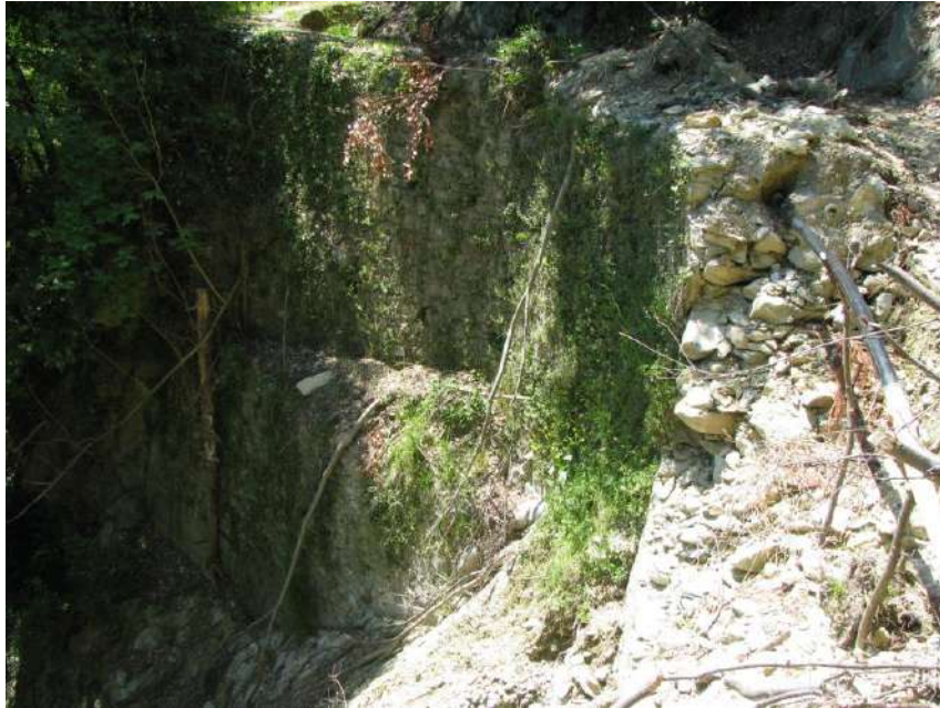
Foto 5 - il due muri di sostegno in pietrame a valle del sentiero / condotta che hanno subito crolli in seguito alla colata detritica.
