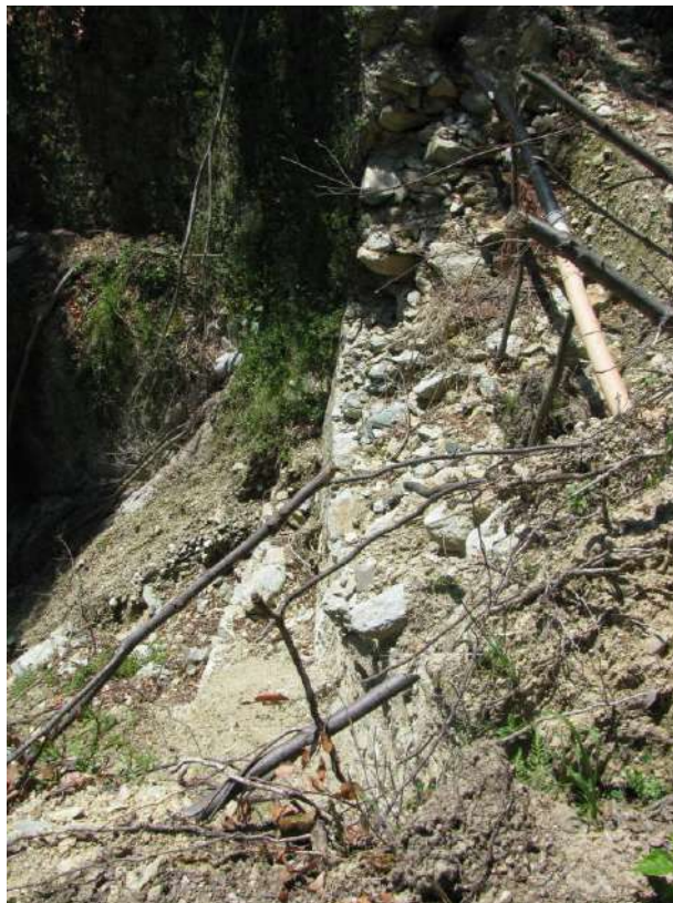
Foto 6 - dettaglio della base dei muri crollati in seguito al passaggio della colata detritica.
