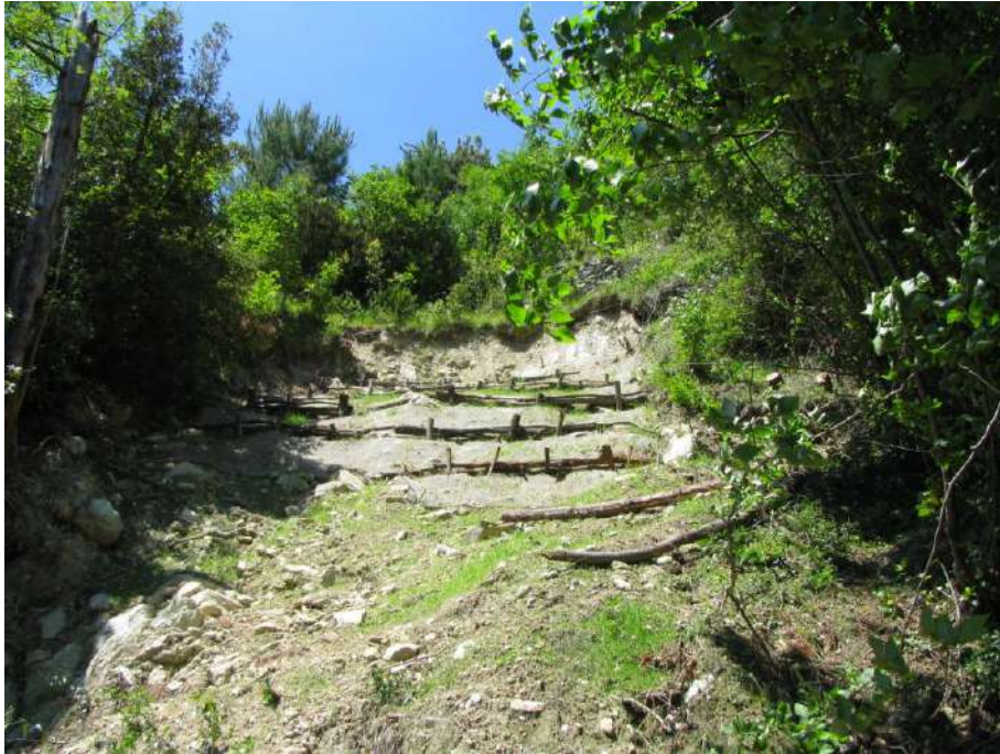
Foto 1 – la nicchia di frana a quota 201 e la frana in coltre detritica tra le quote 201 e 187
