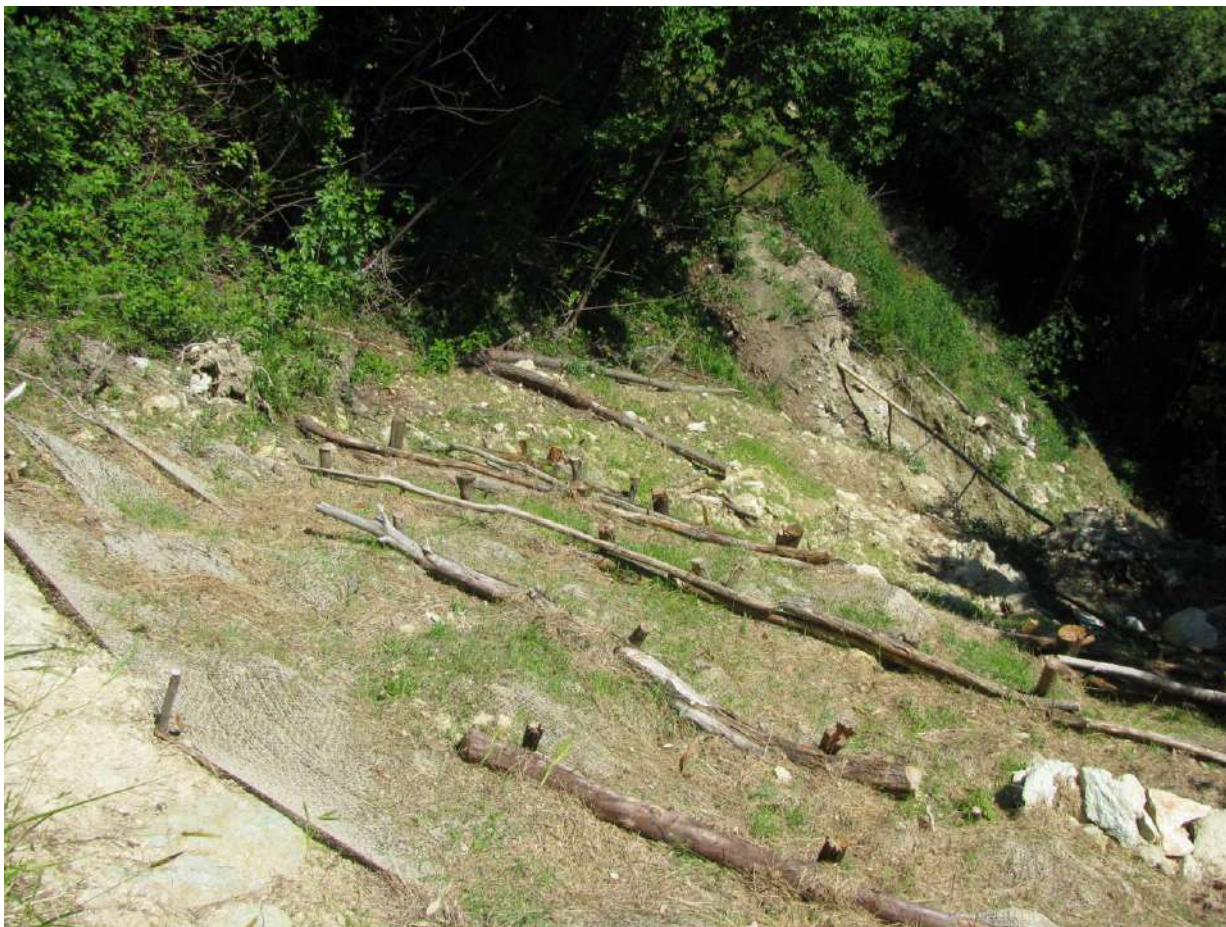
Foto 2 – la stessa porzione di frana tra le quote 201 e 187 vista dall’alto.
