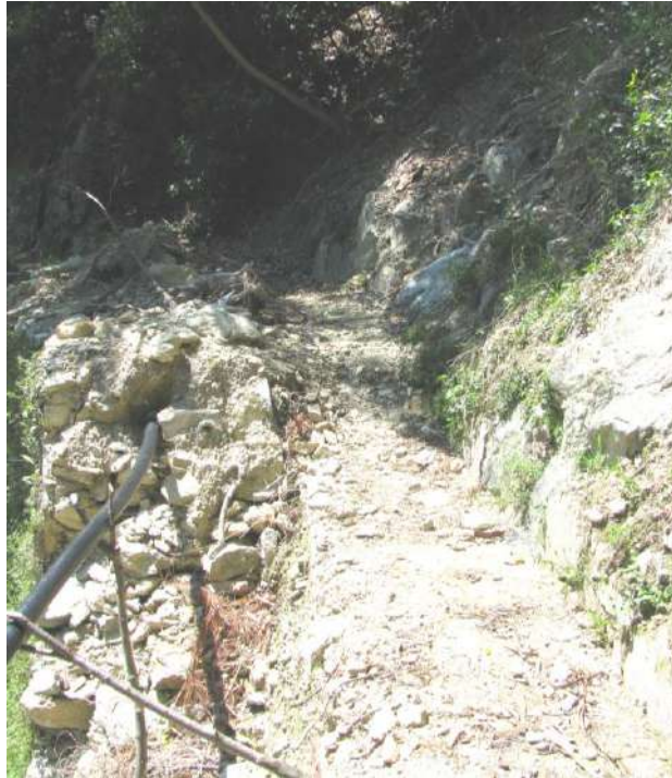
Foto 3 - il sentiero a quota 187, dove passava la condotta idrica distrutta dalla frana.
