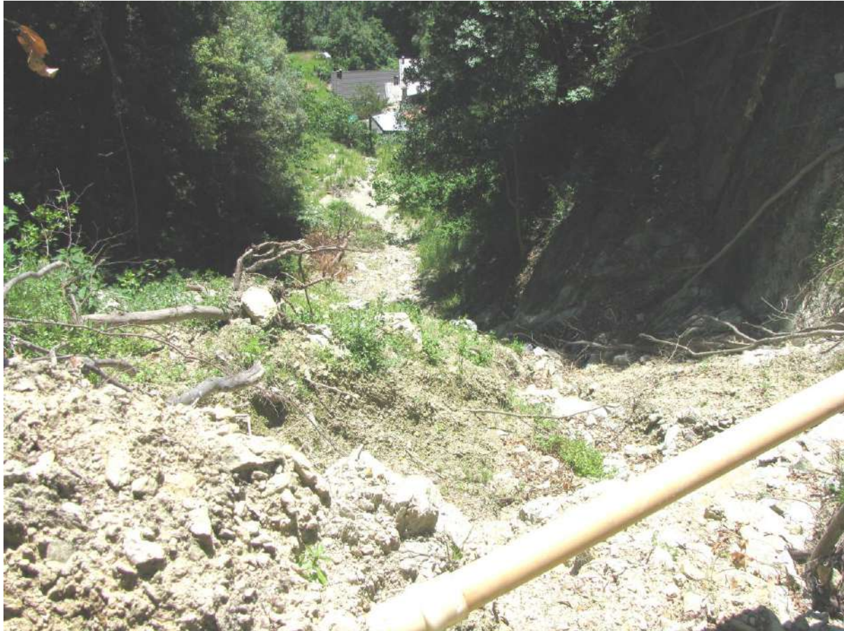
Foto 7 - accumulo di frana sotto il sentiero - condotta tra le quote 155 e 179.
