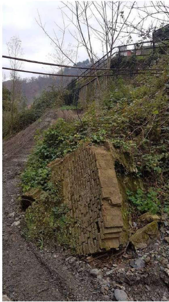
Foto 5 – parte del ponte crollata in alveo
