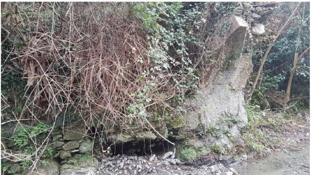
Foto 6 – Spalla sinistra con tratto di arginatura sottoescavata
