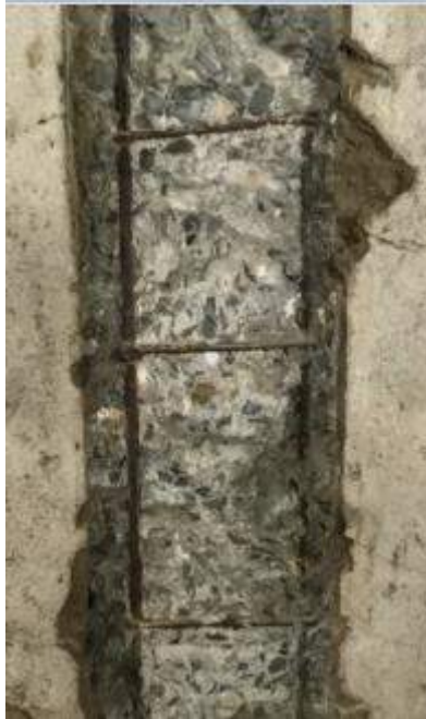
Foto 14: Pilastro c.a. e armature
