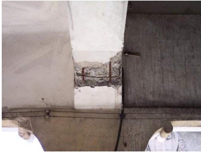
Foto 17: Espulsione del copriferro e corrosione armatura
