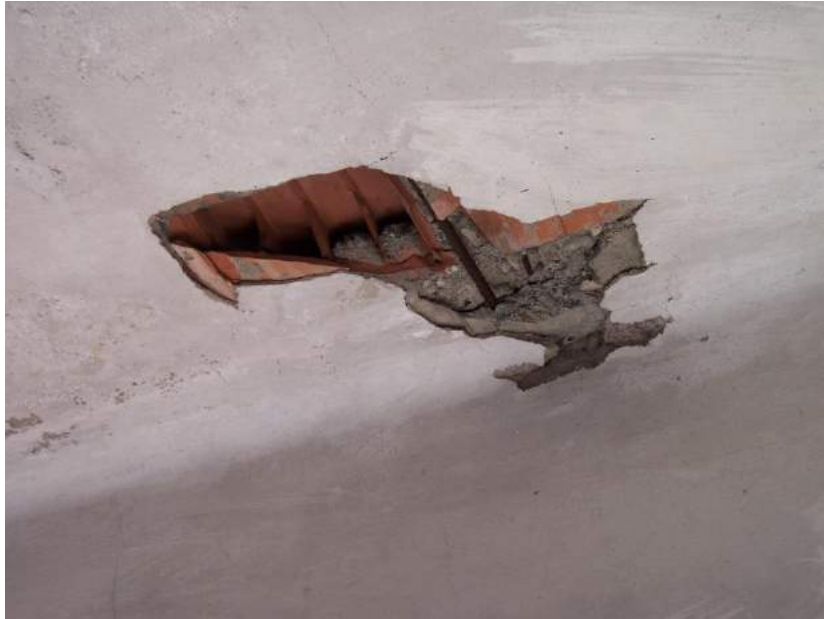
Foto 18: Espulsione copriferro e rottura di laterizio in un solaio
