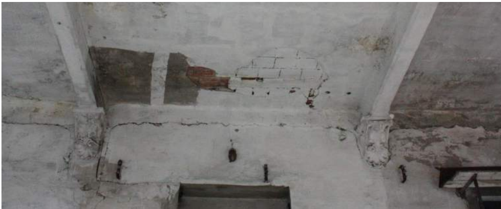
Foto 19: Mancanza di ammorsamento trave-pilastro e tamponamento
