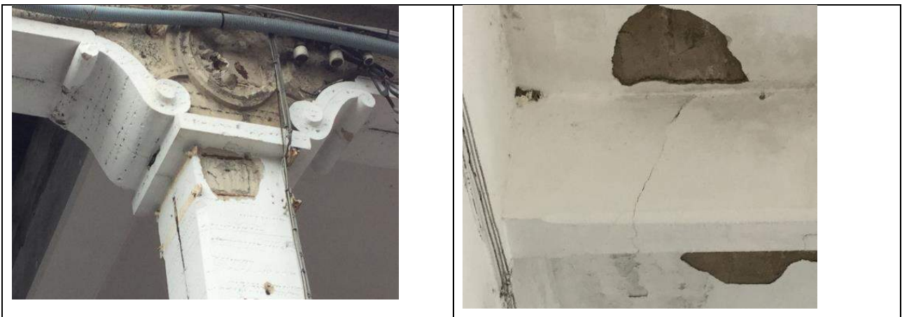
Foto 20: Espulsione del copriferro e lesione su trave
