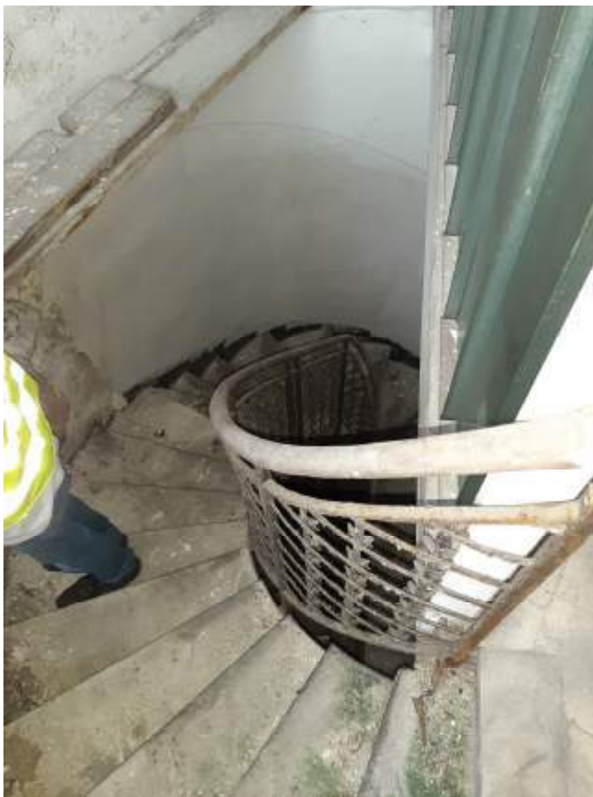
Foto 6 – interno edificio uffici, scala di collegamento tra piano terra e primo piano
