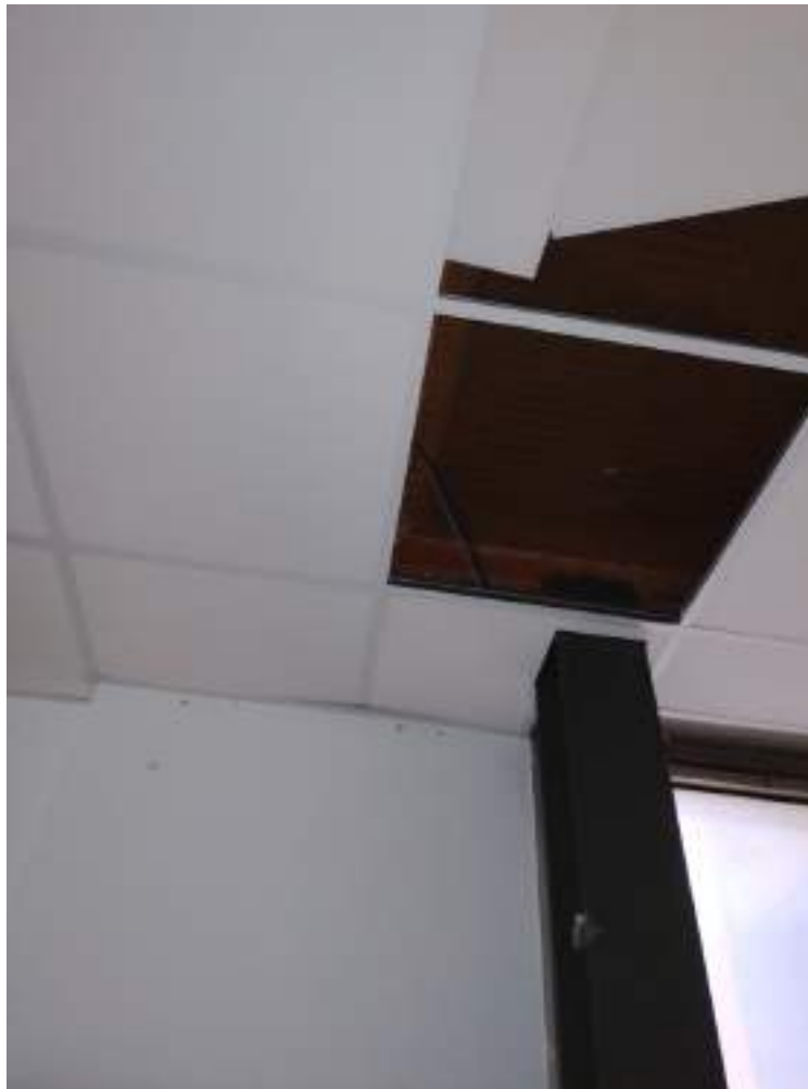
Figura 3. Particolare del saggio interno a soffitto piano primo nella zona dove sarà inserita nuova piattaforma elevatrice per verifica orientamento travetti solaio
