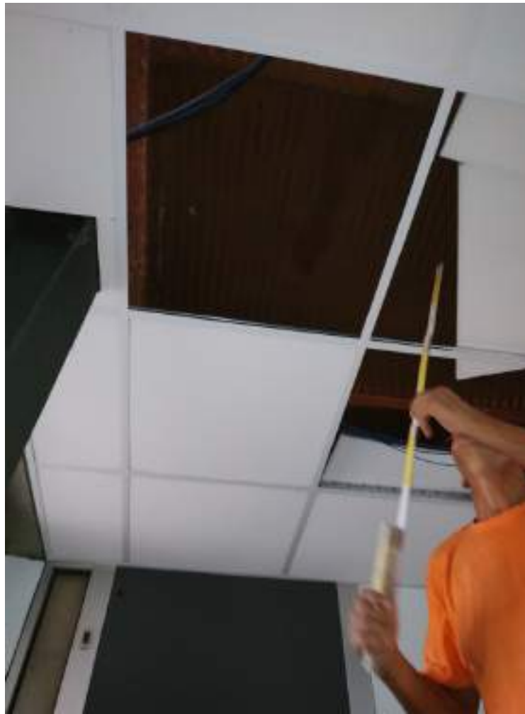
Figura 4. Ulteriore saggio interno a soffitto piano primo nella zona dove sarà inserita nuova piattaforma elevatrice per verifica orientamento travetti solaio
