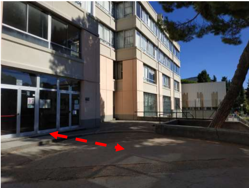
Foto 7: Foto Ingresso scuola su prospetto Sud – quota piazzale e soglia ingresso scuola da adeguare
