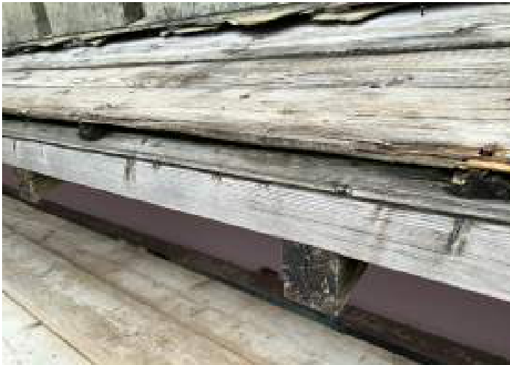
Fotogramma 5) Dettaglio sporto di gronda prospetto Sud-Est in evidenza stato di marcescenza dell'orditura secondaria e minuta
