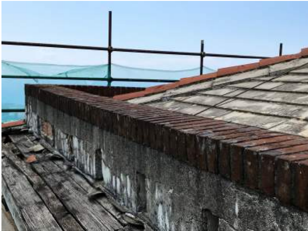
Fotogramma 3) Dettaglio sporto di gronda prospetto Nord-Est in evidenza lo stato di marcescenza del tavolato ligneo, fessurazioni e stacchi del muretto d'attico
