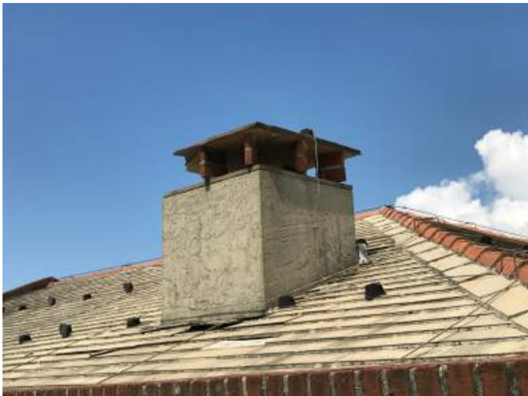
Fotogramma 4) Dettaglio camino in evidenza la lastra in ardesia parzialmente crollata e danni alla base
