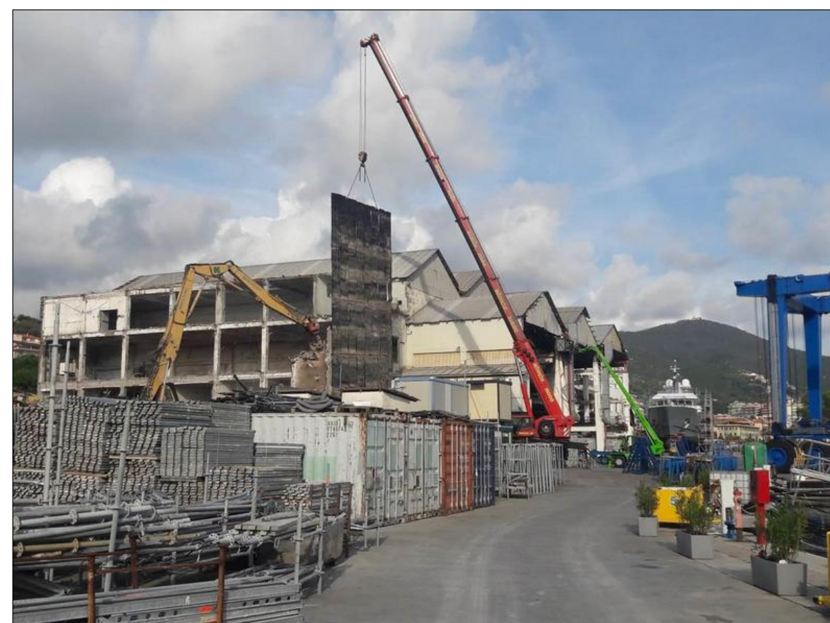
PROTEZIONE DELL'AMBIENTE CIRCOSTANZE DAI PROIETTI DOVUTI ALLE DEMOLIZIONI: LA PANNELLATURA MOBILE, SORRETTA DA UN'AUTOGRU, PERMETTERA' DI CONVOGLIARE I DETRITI AL PIEDE DELL'AREA DI DEMOLIZIONE.
