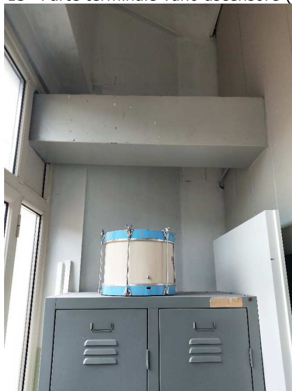
Foto 14 – Ventilazione vano ascensore (P.3°)
