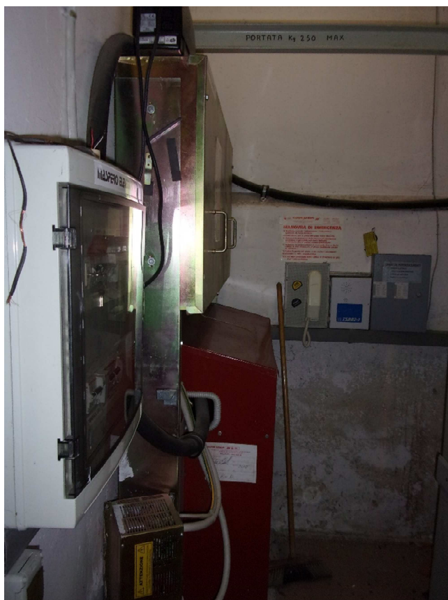
Foto 5 – Locale macchine ascensore (piano seminterrato)
