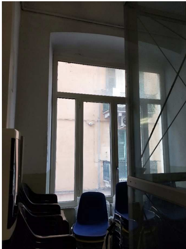
Foto 15 –Finestra tipo del filtro della scala a prova di fumo oggetto di modifica
