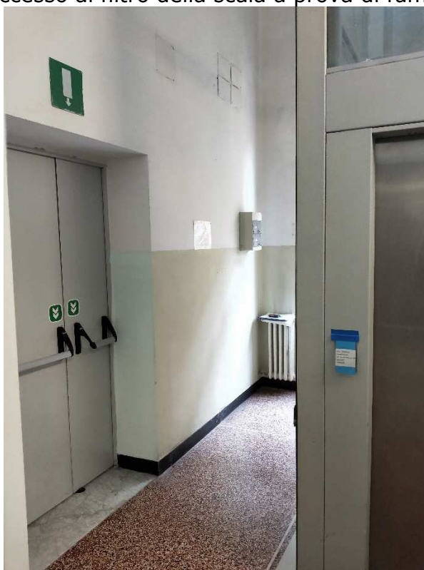
Foto 12 – Filtro a prova di fumo della scala e ascensore oleodinamico
