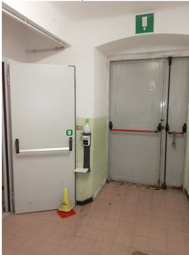
Foto 4 – Uscita di sicurezza 1 (piano seminterrato)
