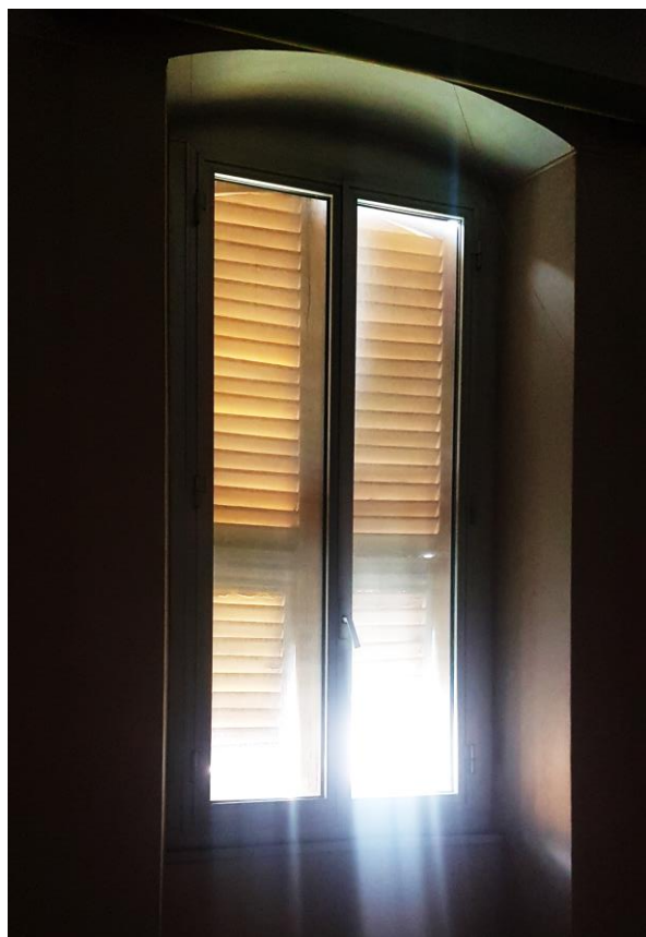
Foto 15 Serramenti esterni da rimuovere e sostituire
