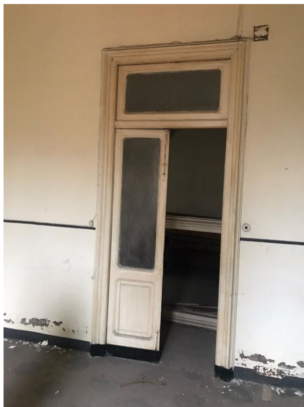
Foto 21 Porte aule da recuperare
