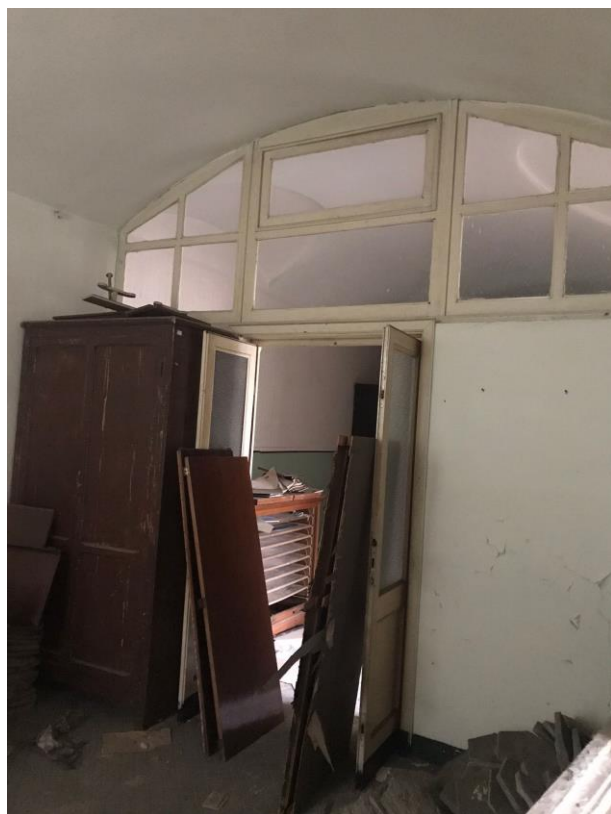
Foto 20 Aula A2, parete vetrata da recuperare
