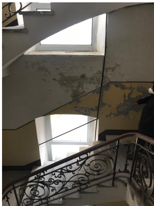
Foto 9 Vano scala - Necessari adeguamenti di sicurezza
