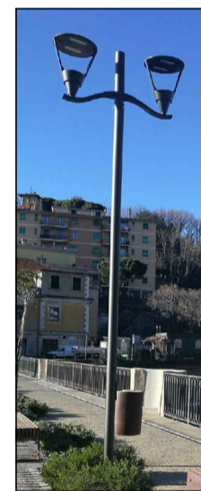
Fig.2- esempio di corpo illuminante per pubblica illuminazione, tipo KALOS LED (Cariboni Fivep), intervento già realizzato nello stesso Municipio V
