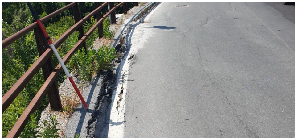
Figura 6 - Vista del cedimento del manto stradale a monte del muro di contenimento
