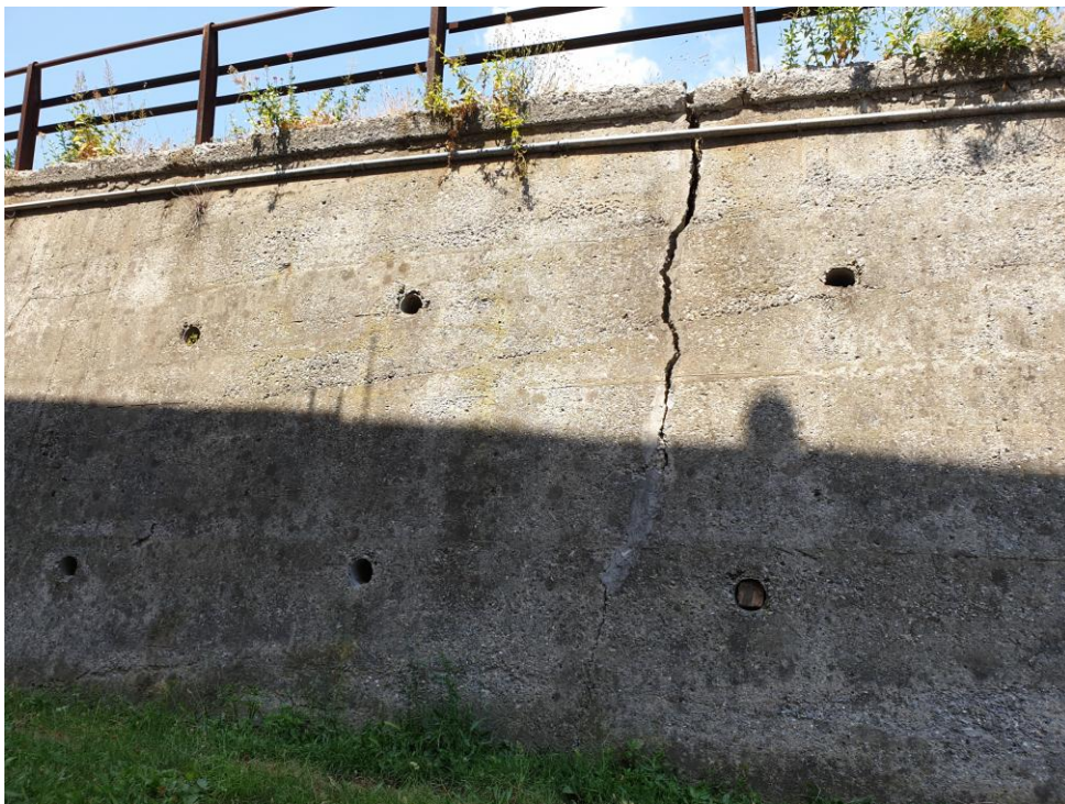
Figura 7 - Vista della lesione n.2 sul muro a valle dell'intervento Lotto 1
