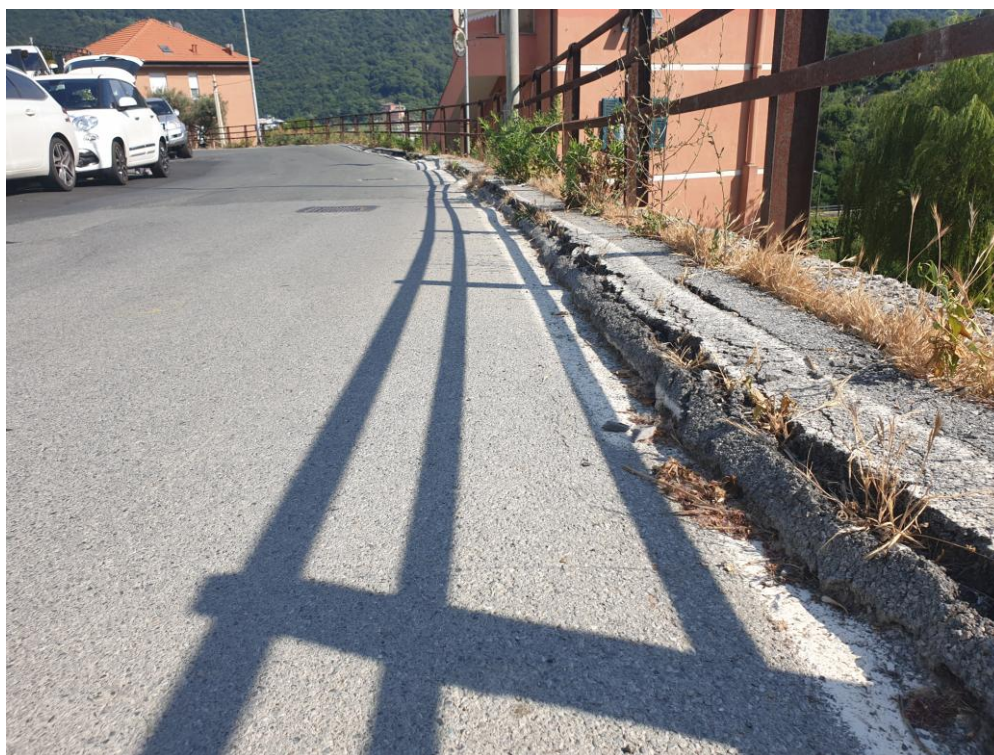
Figura 8 – Vista dei cedimenti del manto stradale in corrispondenza della sommità del muro
