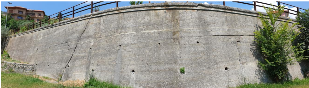
Figura 3 - Vista dello stato fessurativo
