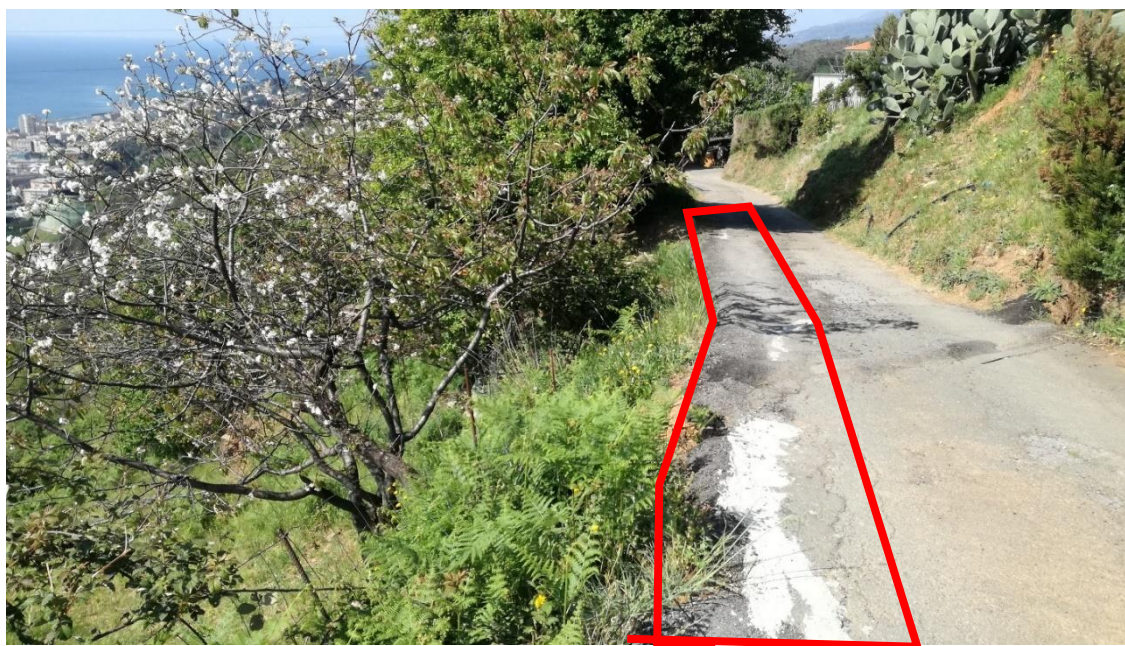
Figura 8 tratto di strada da ripristinare con pali a cavalletto e nuova protezione a valle
