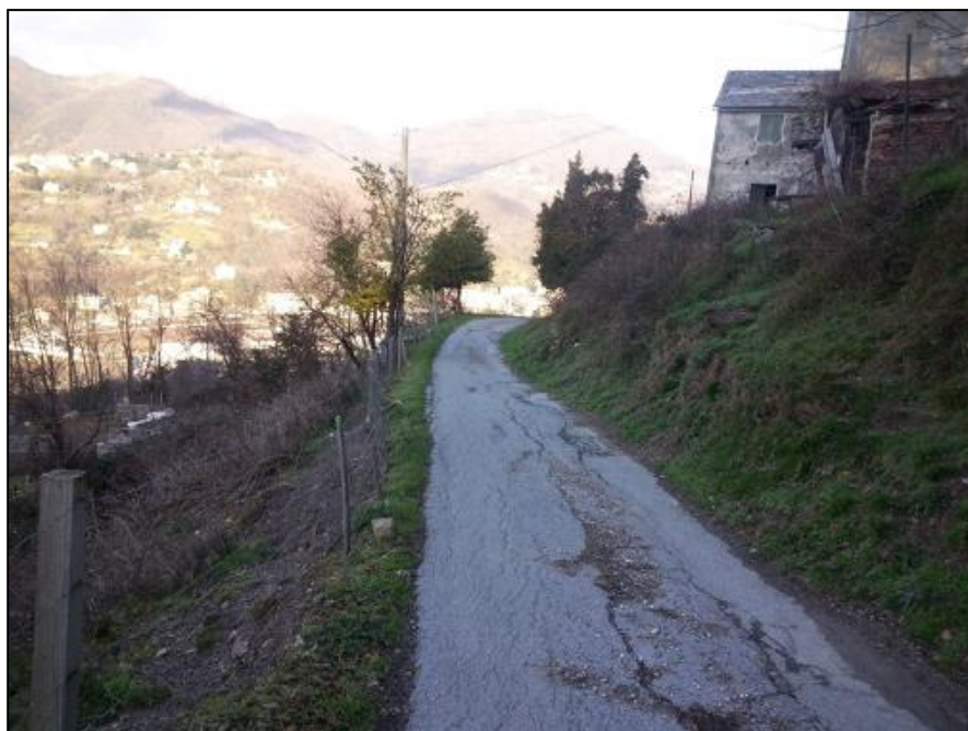
Figura 10 - Scarpata dilavata sotto strada
