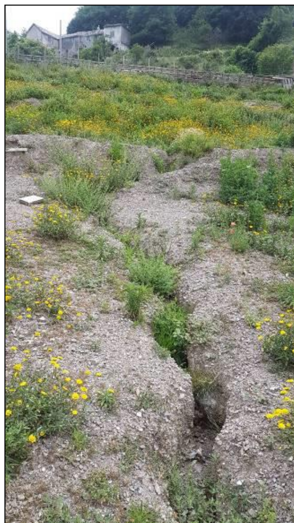
Figura 14 - Segni di dilavamento sulla scarpata
