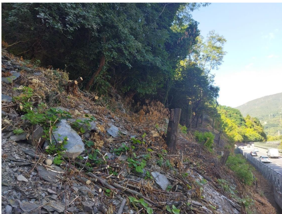
Foto 3: zona di accumulo del materiale crollato e piante già tagliate da Autostrade
