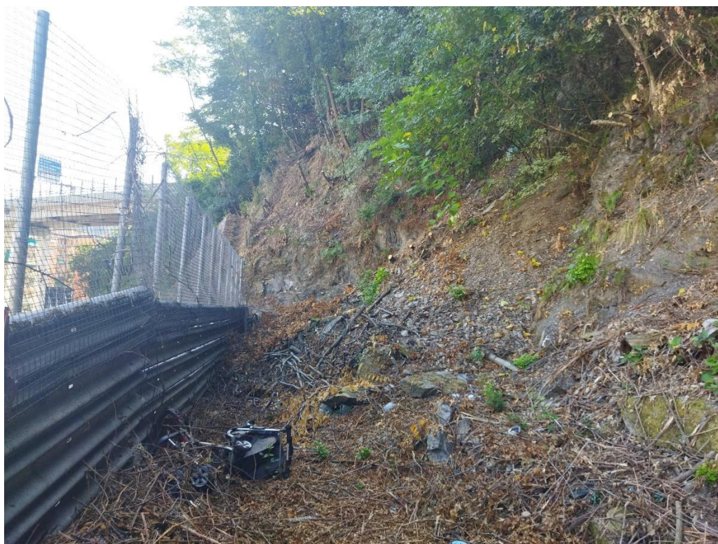
Foto 8: guard rail messi a protezione del materiale lapideo. Vari oggetti artificiali abbandonati
