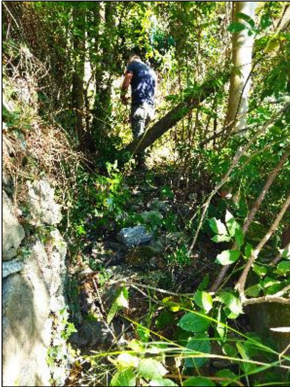
Figura 3: Canaletta in condizioni di degrado
