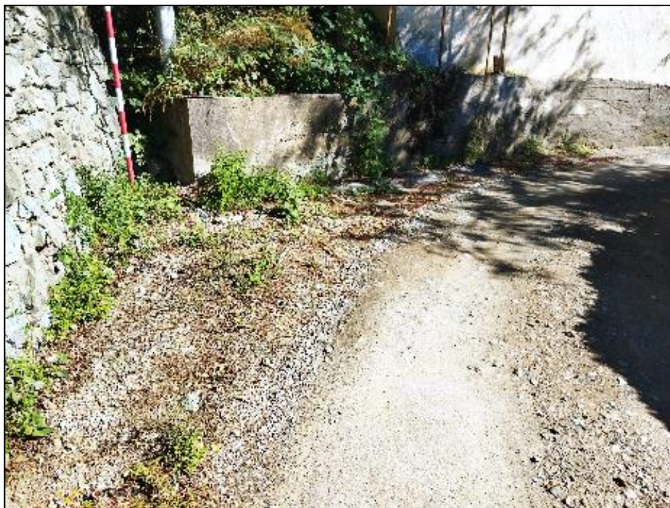
Figura 2: Area in esame, zona interessata da allagamento ed accumulo di detriti in caso di forti piogge.
