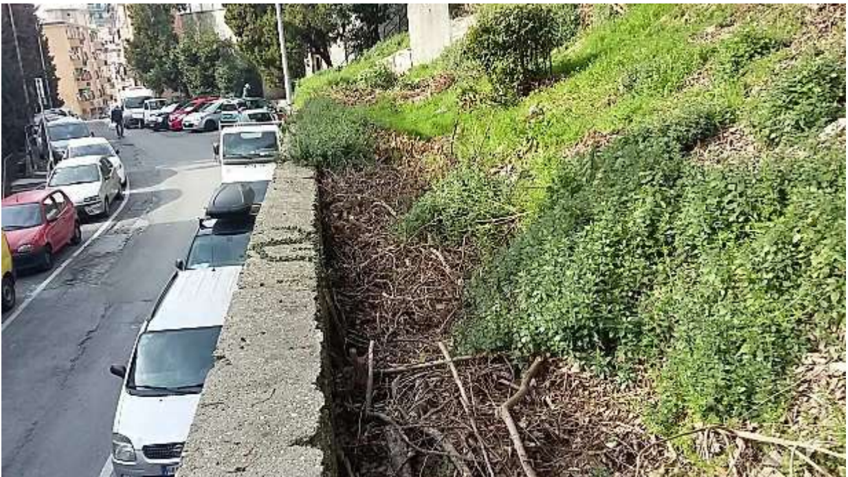
Foto 10 – Fosso a tergo del muro di confine, lato monte, con Via A. Robino, parzialmente o completamente riempito da materiale vario.
