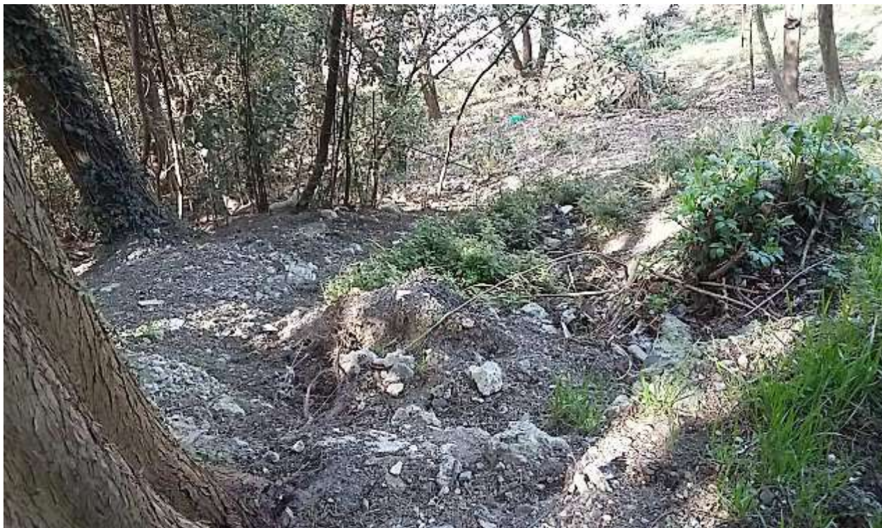
Foto 13 – Solchi di erosione all'apice dell'area in curva.
