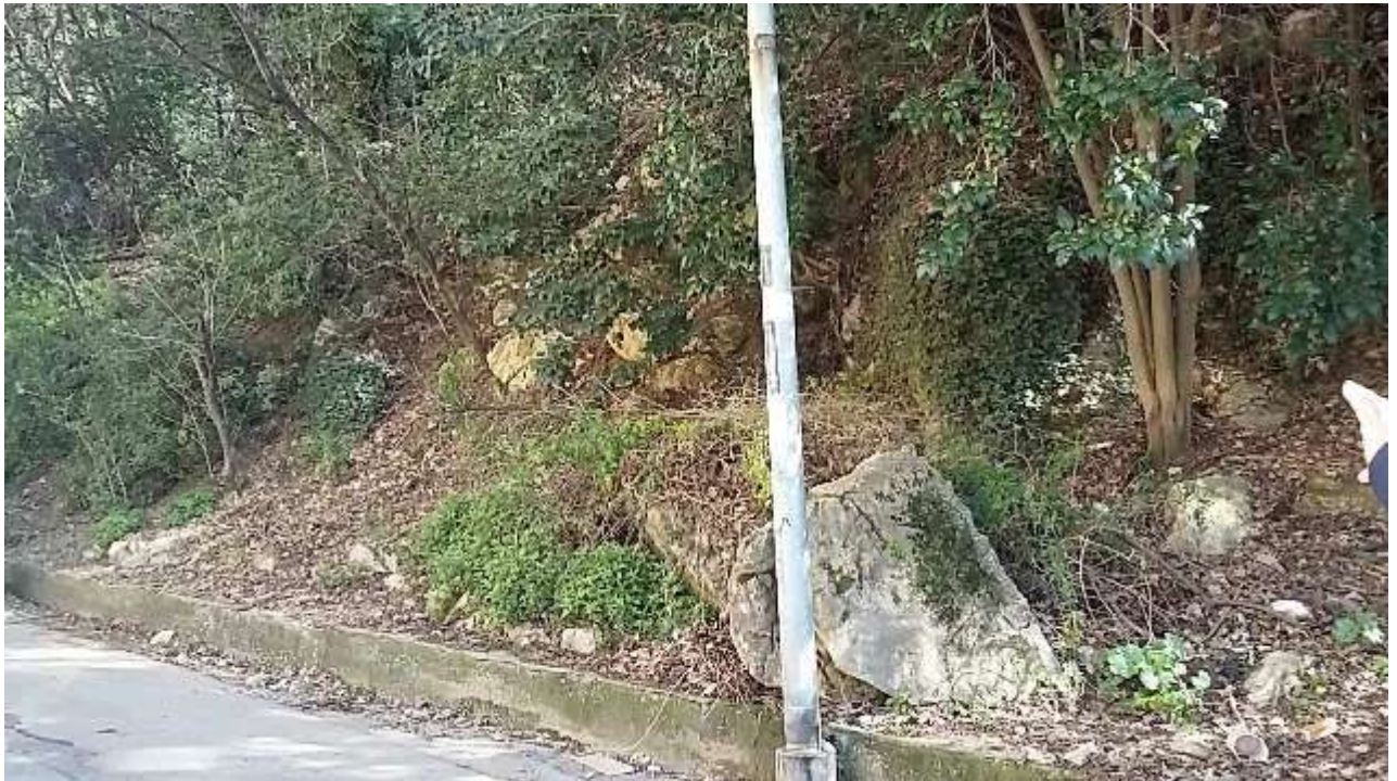
Foto 26 – Materiale terrigeno e lapideo, anche di grosse dimensioni, scivolato o rotolato verso la carreggiata di Via A. Robino, qui delimitata soltanto da un cordolo alto 20-30 cm.
