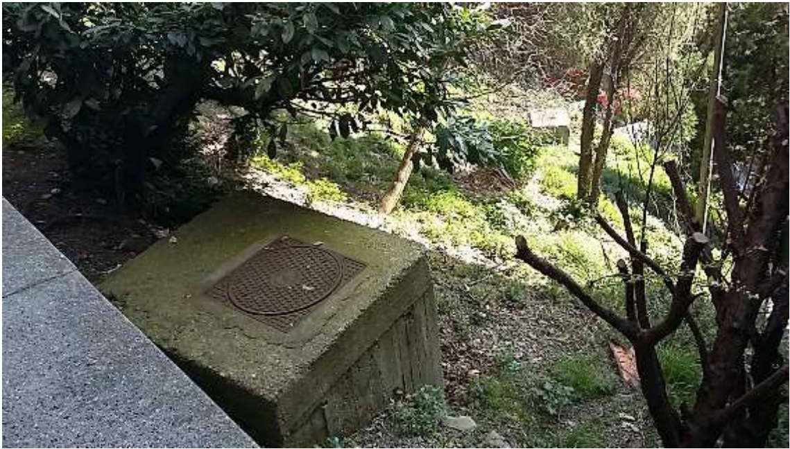
Foto 8 – Pozzetto presente all'apice della scarpata, limitrofo alla scalinata che porta in Via C. Emery.
