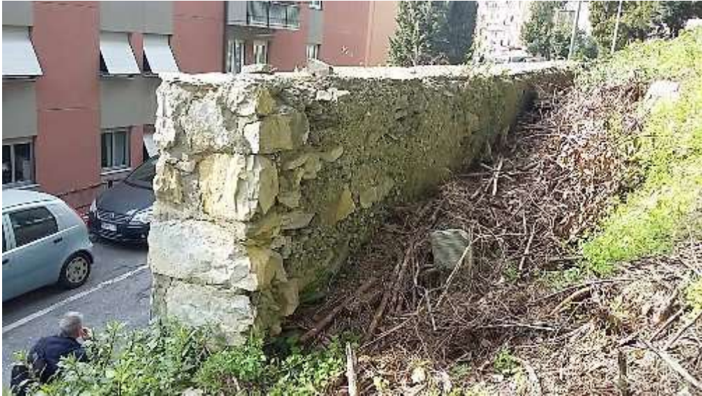
Foto 11 – Particolare del muro in calcestruzzo e cemento di foto 10. Si nota il fosso a tergo del muro, via via riempito di ramaglie, terra e resti lapidei.
