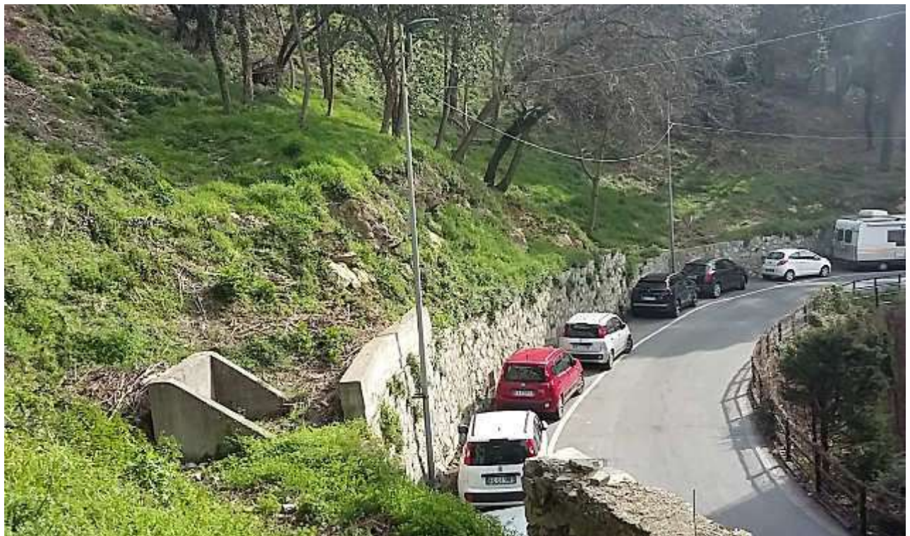
Foto 15 – Panoramica del tratto in curva di Via A. Robino. Si notano il manufatto in cui sembra confluire l'impluvio (in basso a sinistra), un piccolo tratto di muro in c.a., sovrapposto al muro originario in pietra e cls, la vegetazione che sormonta il muro stesso ed il substrato roccioso affiorante o sub-affiorante (parte centrale della foto).
