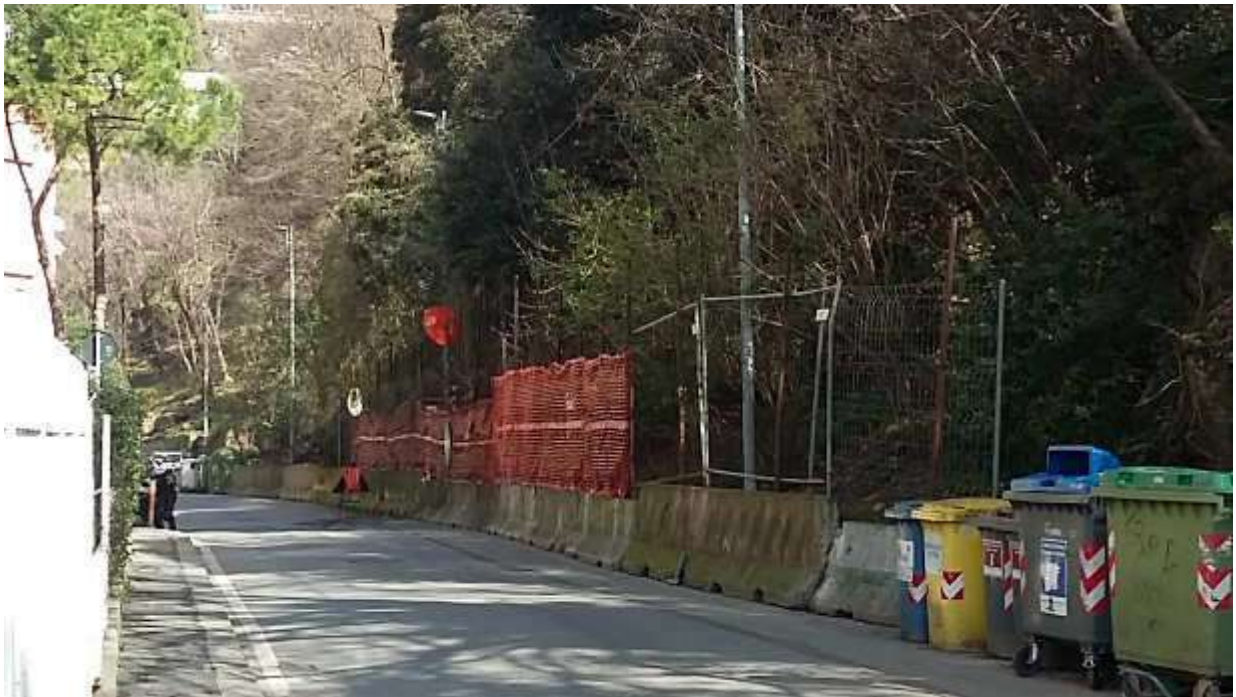
Foto 18 – Tratto in discesa di Via Robino tra il SETTORE 3 ed il SETTORE 4, già transennato.
