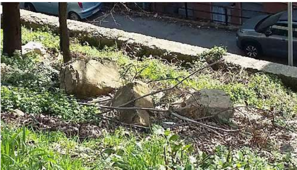
Foto 4 – Massi dislocati presenti lungo il versante, subito a tergo del muro di confine con Via A. Robino.
