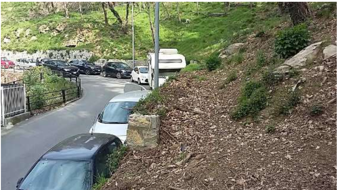
Foto 20 – Fosso a tergo del muro di contenimento, ormai completamente riempito da coltre e pietrame.
