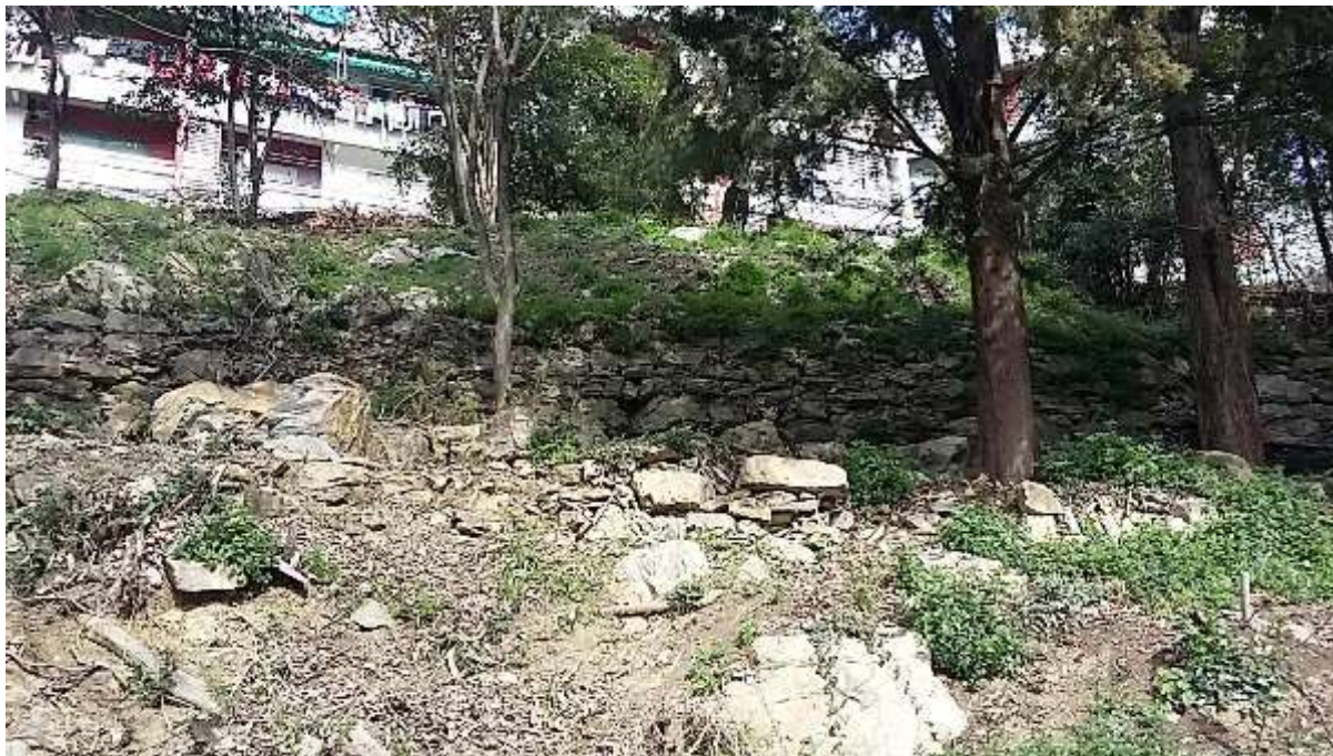
Foto 6 – Muri a secco soggetti a parziali crolli.
