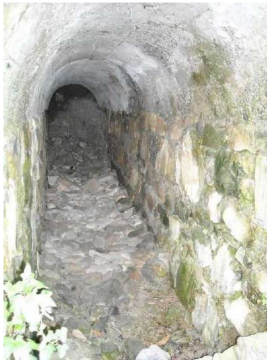
Foto 4 - Interno del tunnel di cui alla foto precedente in cui si nota l'occlusione lato monte
