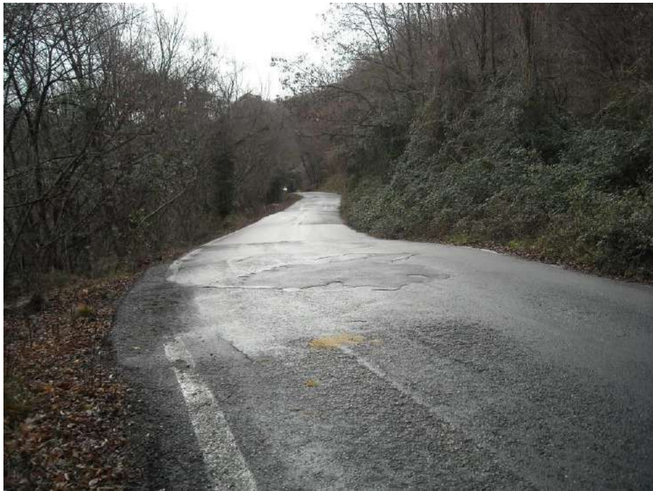
Foto 1 - a, b, c – Tratto di via Montelungo in dissesto con avvallamenti, ondulazioni e cedimenti oggetto di periodiche ricariche di asfalto
