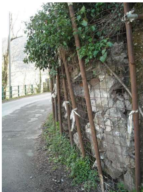
Foto 12 – Il muro in fregio alla via Montelungo a partire dal bivio per l'allevamento Antiga presenta precarie condizioni di conservazione, con spancamenti e perdita di verticalità, localmente tamponati con interventi posticci.
