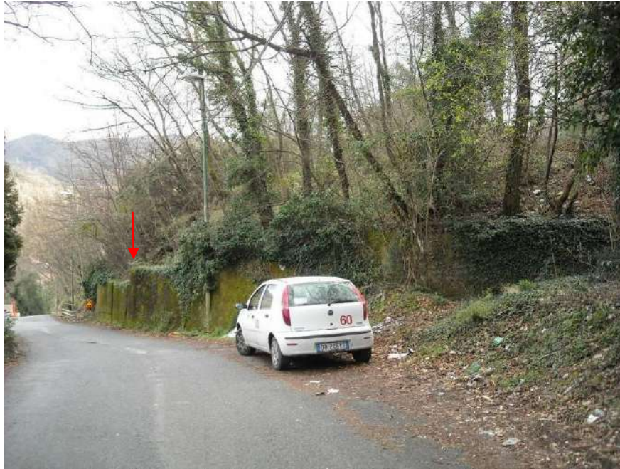
Foto 7 – Via Serino, con in evidenza il muro di contenimento lato monte che presenta alcune vistose lesioni a partire dal punto indicato dalla freccia per probabile richiamo verso valle (nella direzione lungo strada, verso il settore della strada stessa con i più marcati cedimenti - cfr intervento “C” del lotto I).
