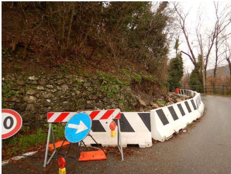
Foto 14 – Il muro di cui alla foto precedente recentemente crollato in parte (e successivamente ripristinato).
