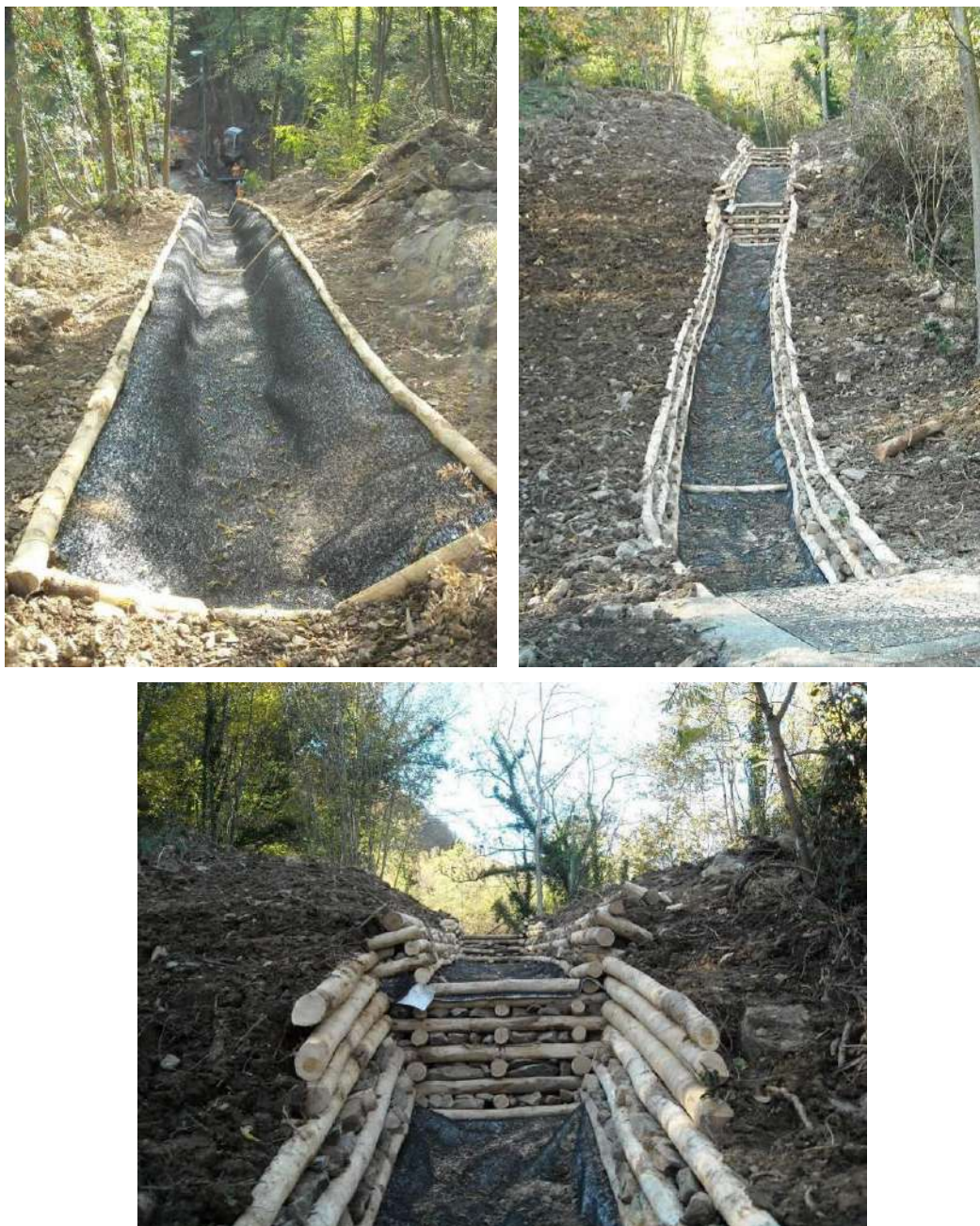
Tipo solchi di corrivazione semplici e con correnti laterali e trasversali di rinforzo già realizzati nell'ambito del primo lotto
