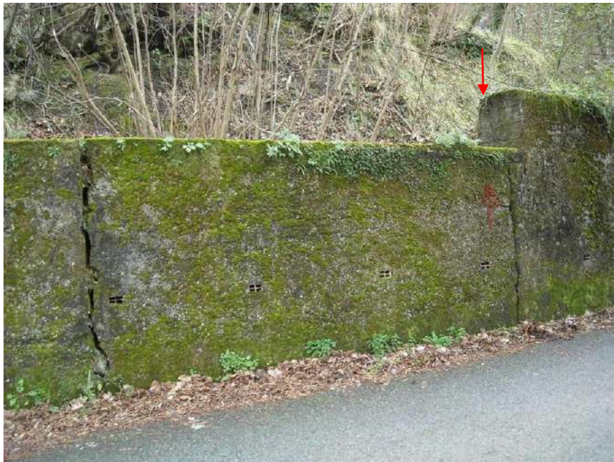
Foto 8 – Il muro lungo Via Serino di cui alla foto precedente vistosamente lesionato in particolare a partire dal punto indicato con la freccia (settore in cui il muro si riduce in altezza e sezione, da circa rispettivamente 2.3 e 0.70 (in testa) a destra della freccia, a circa 1.7 e 0.50 (in testa) a sinistra della freccia)
