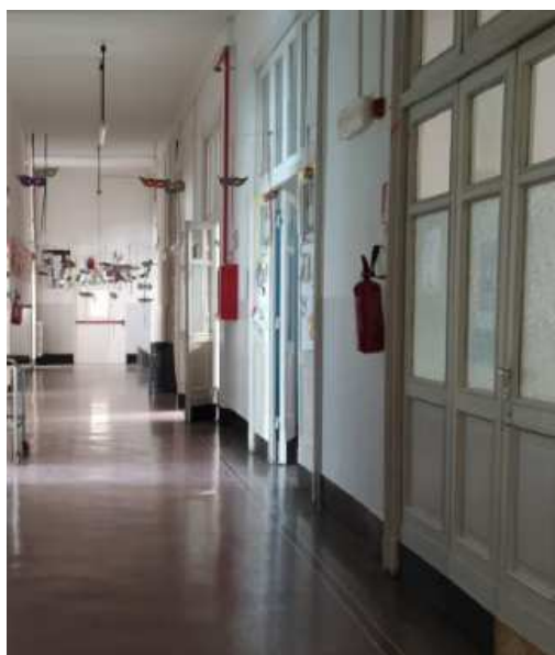
Gli estintori in adiacenza ad un vano scale
