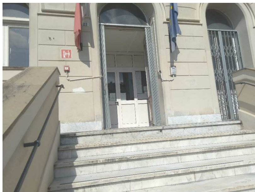
Ingresso su via Bobbio: pulsante di sgancio da sostituire
