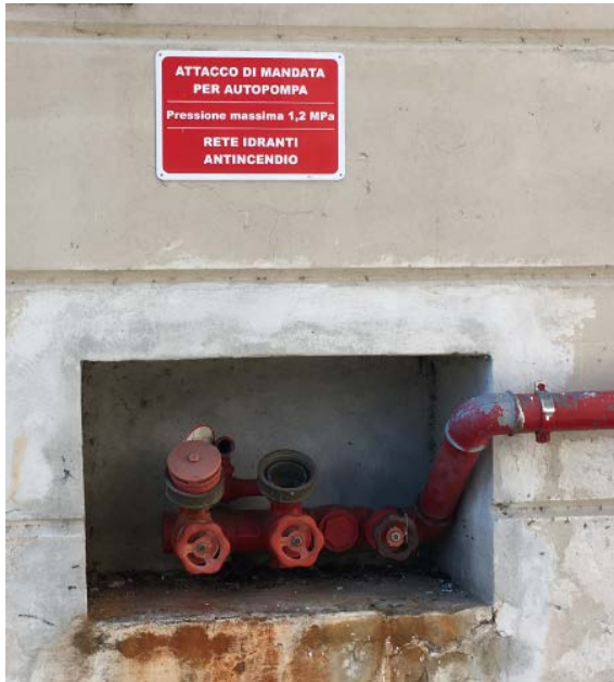
Figura 5 – Dettaglio attacco motopompa
