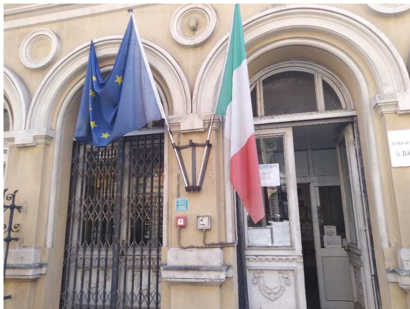
Ingresso su via Montaldo: pulsante di sgancio da sostituire
