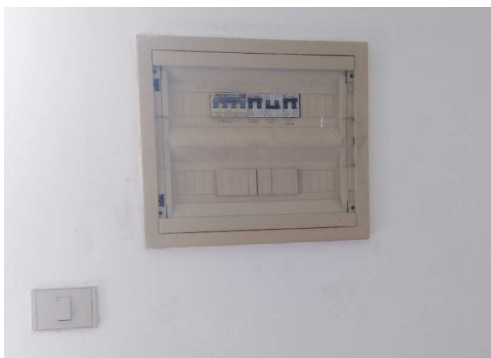
Quadro elettrico piano scuola primaria (da adeguare e rifare)
