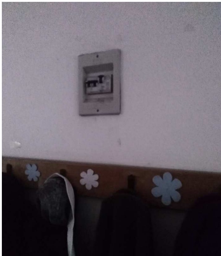
Quadro elettrico piano prima scuola primaria (da adeguare e rifare)
