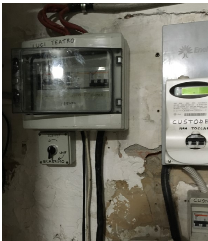
Figura 14 - Quadro elettrico piano terra (da adeguare)
