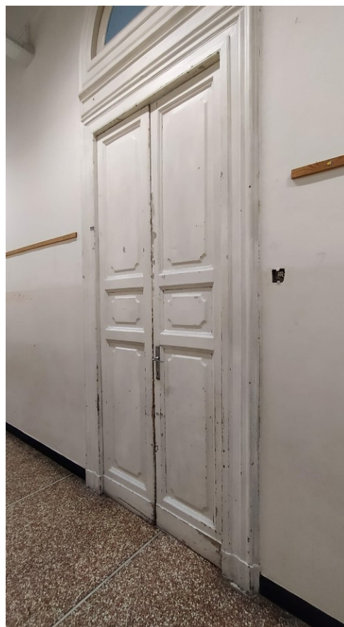
Figura 13 –Esempio porta lato Sud
