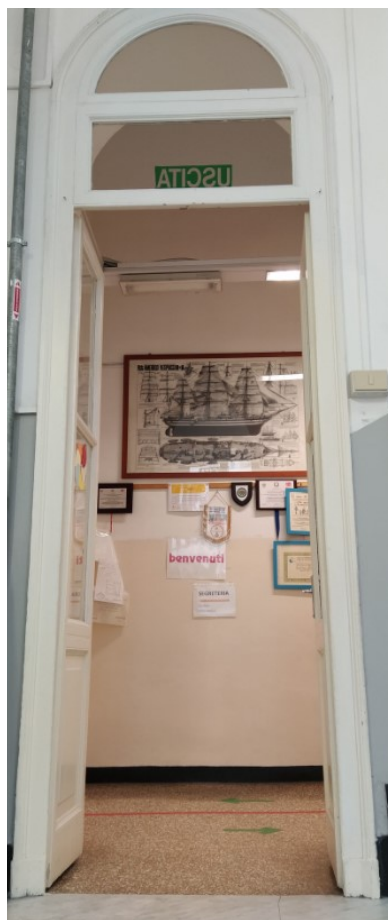
Figura 5- Porta su vano scala da sostituire con porta REI 60
