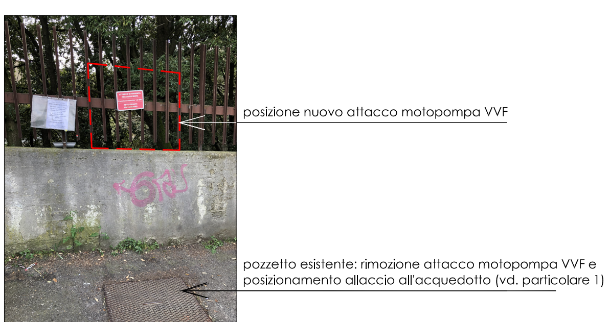
FOTO 1: POSIZIONE NUOVO ATTACCO VVF
