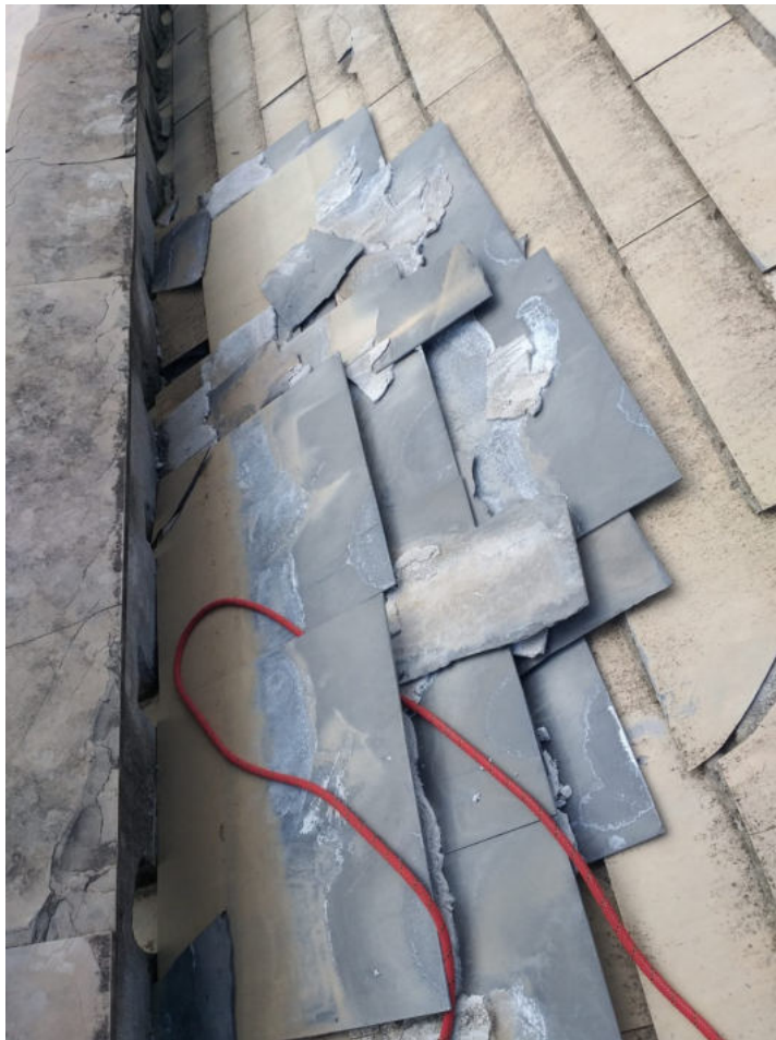
Foto 02 ( lastre scivolate sul muretto d'attico )
