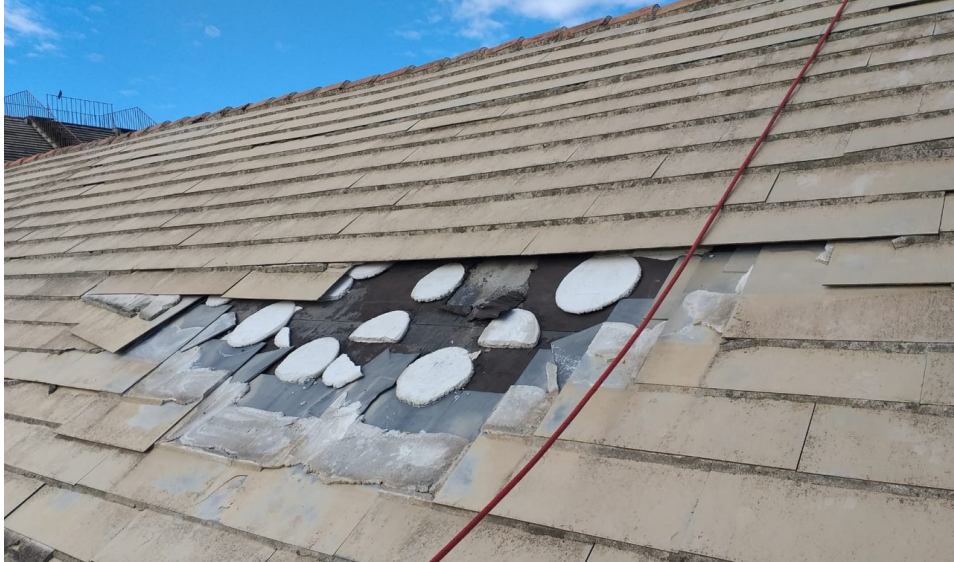
Dettaglio falda Est: parziale scivolamento degli abbadini, si evidenzia il supporto costituito da panetti in cls su guaina catramata.
