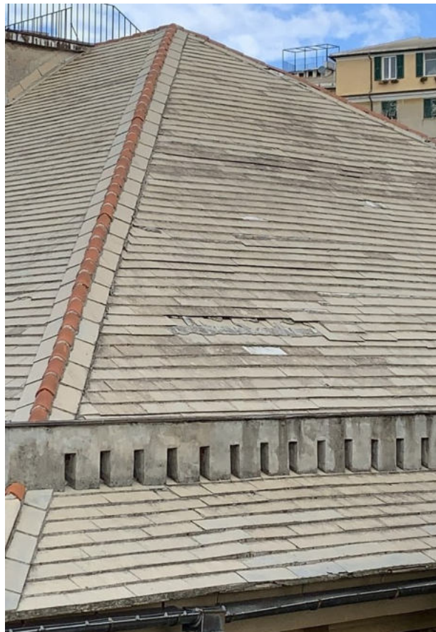
Foto 10 ( muretto attico e falda – corpo principale levante )
