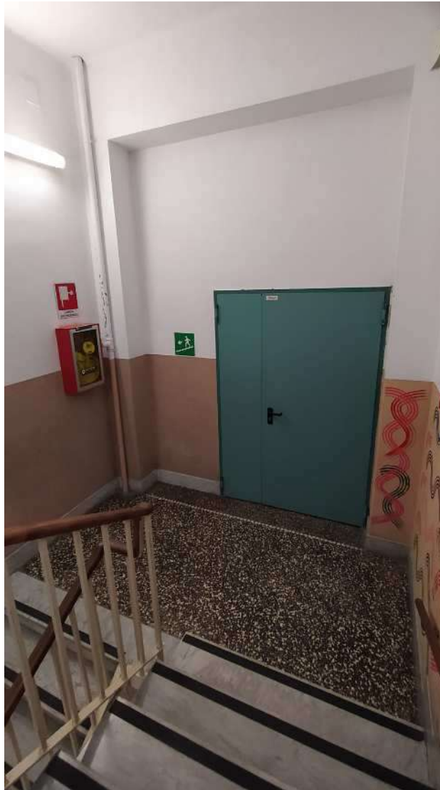
Foto 4. Piano terzo (piano tipo). Stato attuale L'idrante posizionato nel corpo scala .
