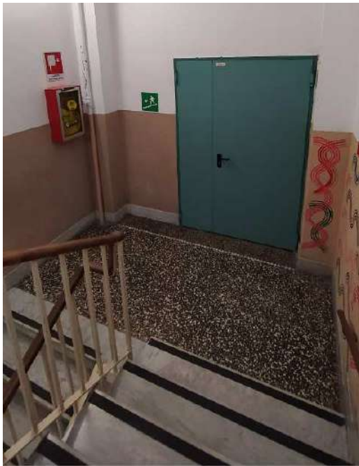
Piano terzo (piano tipo). Stato attuale L'idrante posizionato nel corpo scale .
