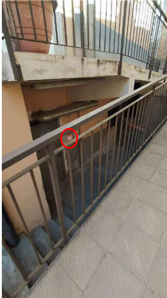
Fotoinserimento 1. L'accesso alla centrale termica Il nuovo pulsante di sgancio andrà inserito ove indicato
