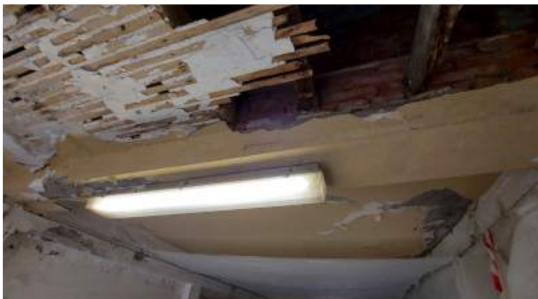
Vista della trave in c.a. porta muro lievemente inflessa
