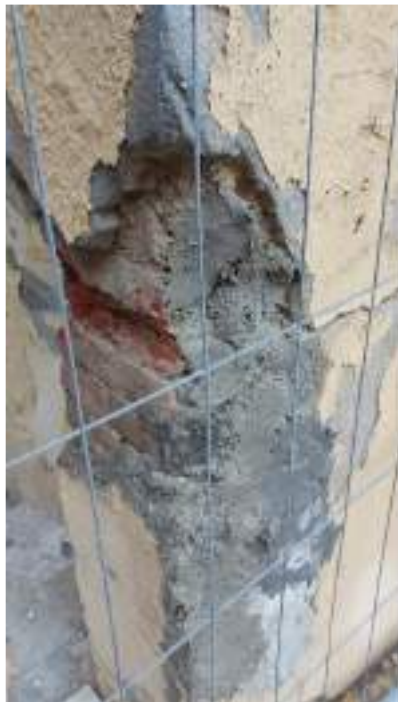
Fig. 17 – Porzioni di intonaco distaccati dalle muratura
