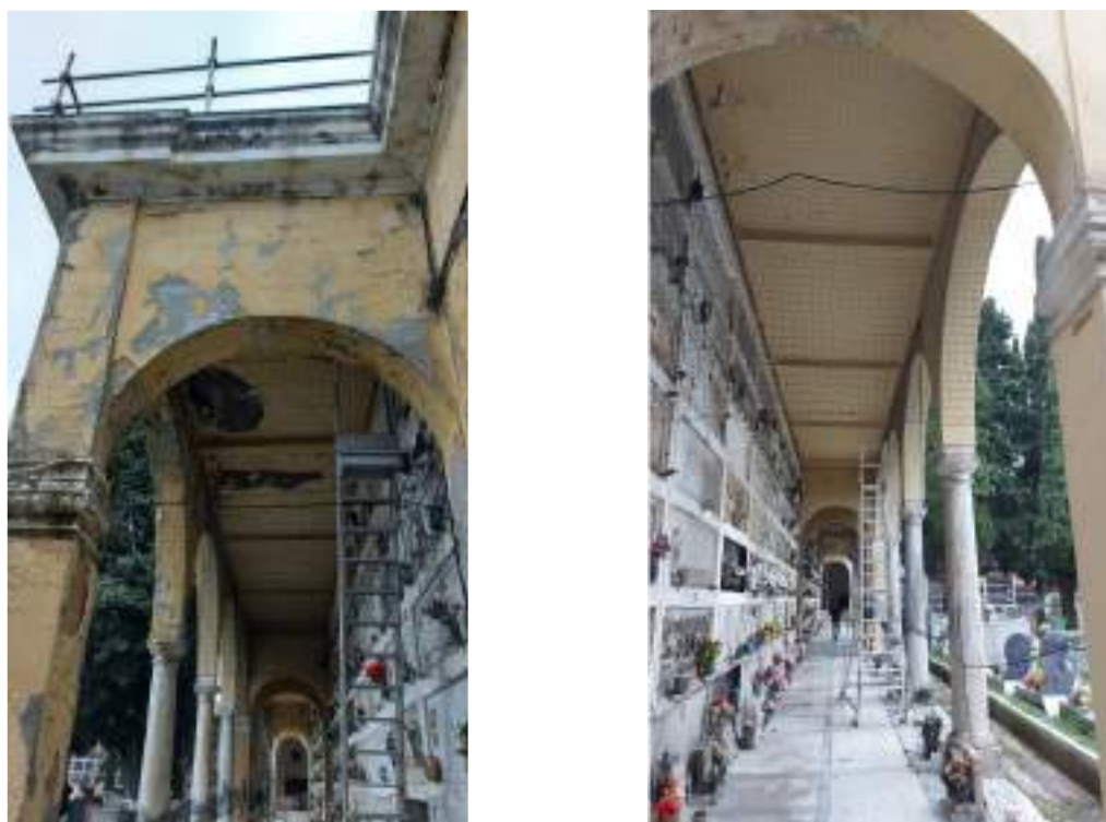
Fig. 11 – Loggiati esterni gallerie con evidenti fenomeni di distacco di intonaco murario e dalle solette di copertura
