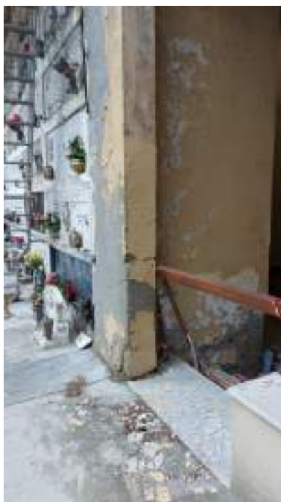
Fig. 18 – Accesso alla galleria interna lato sinistro ingresso dall'esterno del loggiato ala sinistra con vistosi fenomeni di distacco dell'intonaco
