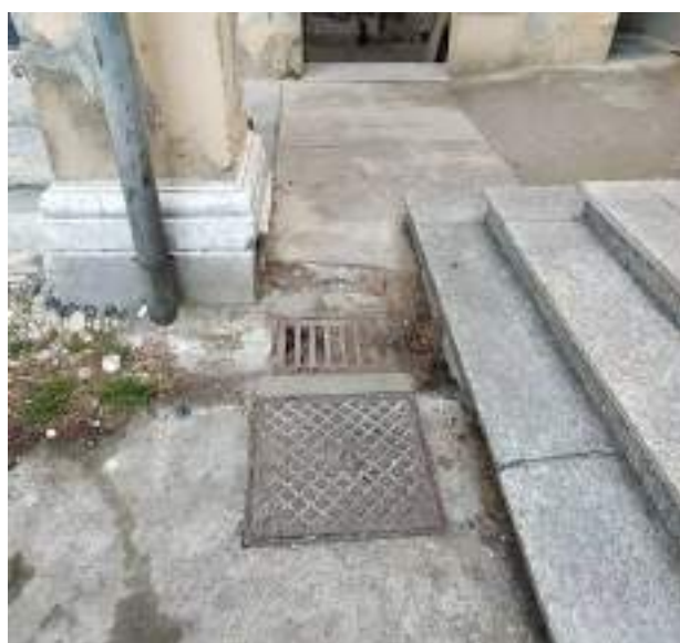
Foto 47, 48 e 49: Dettagli degrado pavimentazione tra Porticato e Campi
