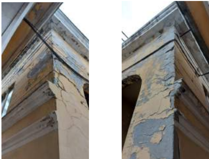
Fig. 10 – Loggiato esterno galleria lato destro con continui distacchi di intonaco e a volte di piccole porzioni di struttura dei cornicioni
