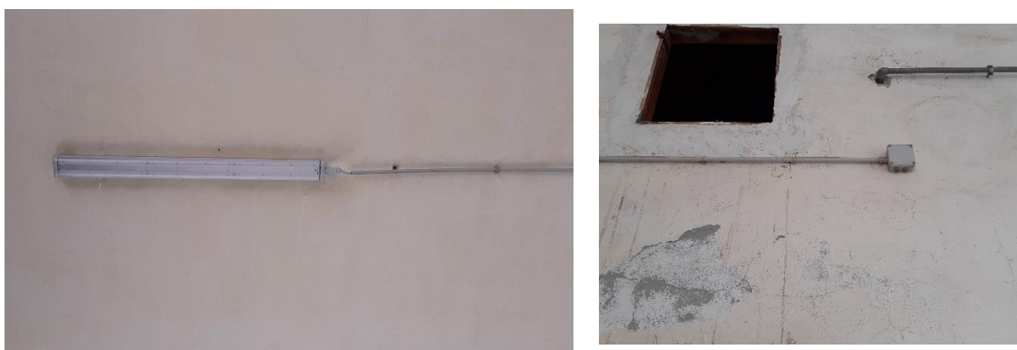
Figura 4: Estratti di impianto esistente
