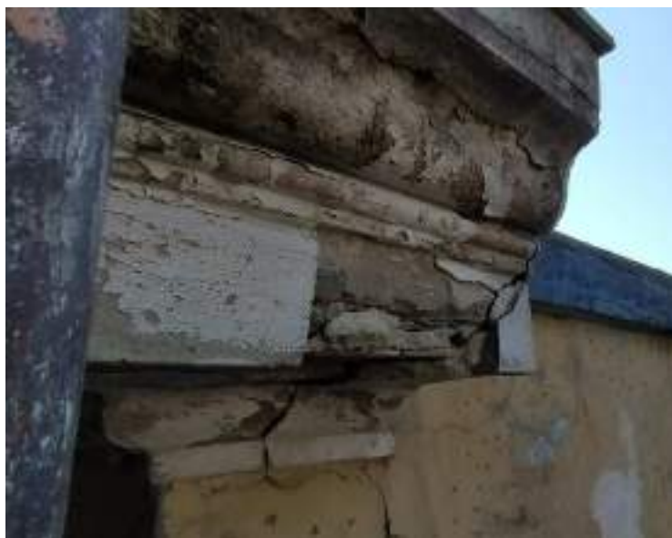
Foto 4: Dettaglio puntuale Cornicione ala di Levante
