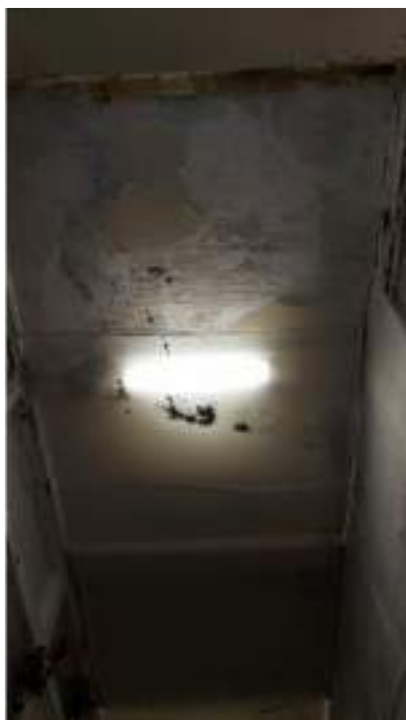
Fig. 14 – Reti anticaduta intonaco/posate sulle solette di copertura delle gallerie interne
