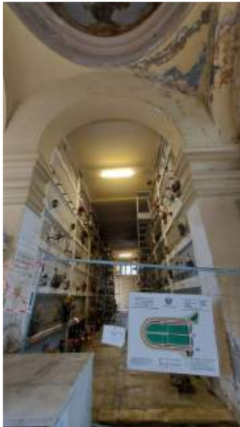
Fig. 9 – Galleria interna lato destro dell'ingresso del Cimitero degli Angeli attualmente non agibile
