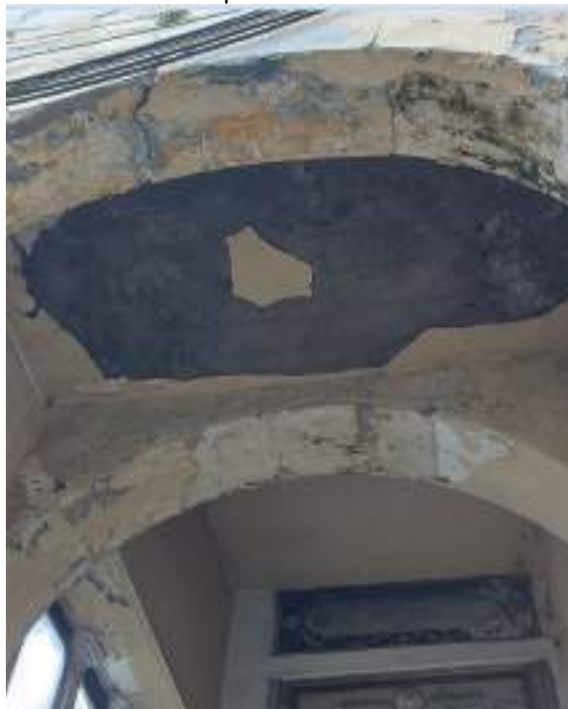
Fig. 13 – Intonaco in fase di distacco dai solai di copertura in c.a. e alcune fessurazioni sull'intonaco delle volte delle gallerie
