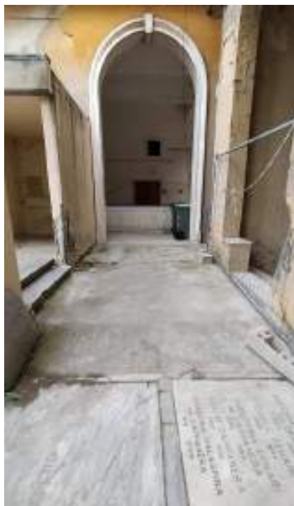
Foto 44. La pavimentazione in battuto di cemento in prossimità del corpo Ponente. In primissimo piano il marmo dell'Antico Portico, sullo sfondo i rivestimenti in travertino della galleria nuova.
