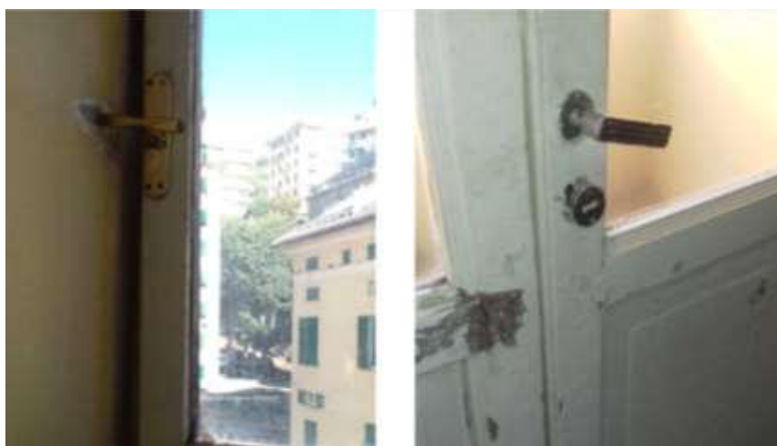
Figura 6 - Esempi di serramenti che necessitano di manutenzione
