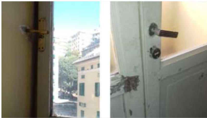
Figura 6 - Esempi di serramenti che necessitano di manutenzione
