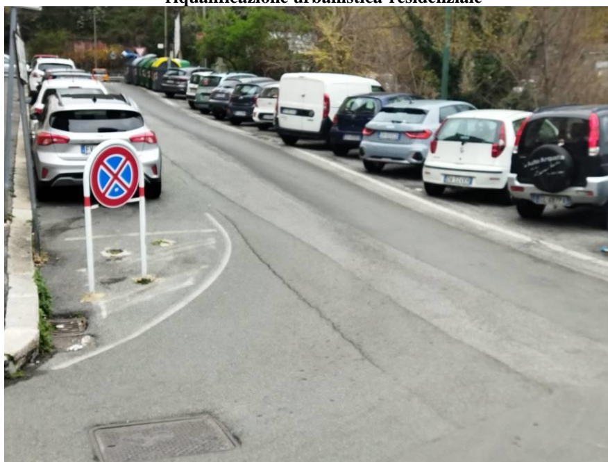
Foto 2: tratto iniziale di Via Gavoglio, angolo Via Gandin. Le acque scorrono libere in carreggiata e si riversano in scarpata
