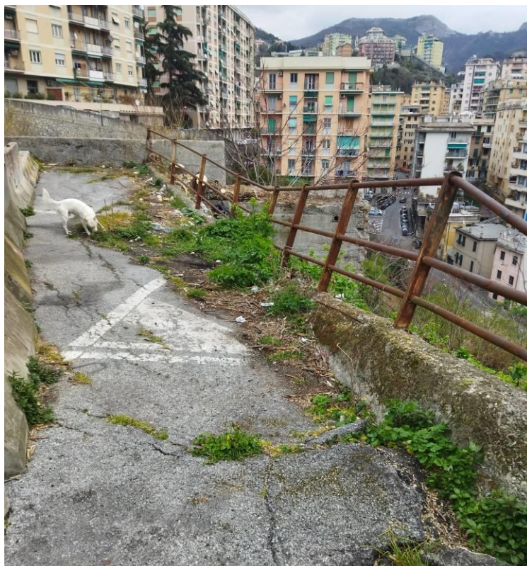
Foto 3: settore di cordolo in dissesto e marcato avvallamento del ciglio
