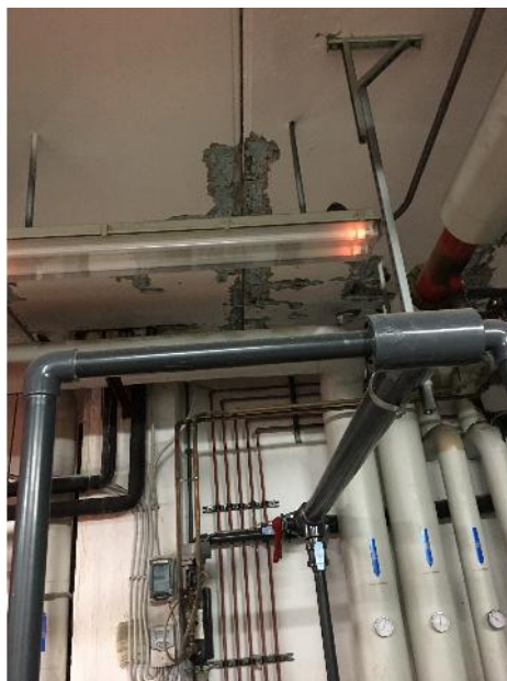
Copriferro degradato nella sala pompe
