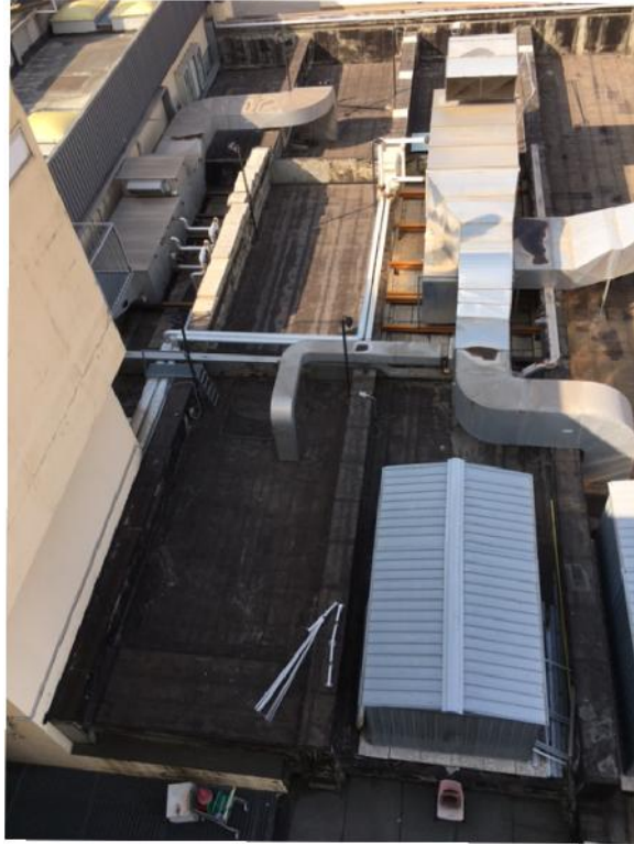
Presenza delle UTA su Area 1
