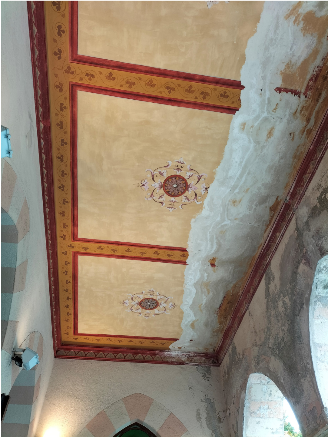
Foto n. 38- Piano primo: arcate e soffitto loggia: dovranno essere risanate e pitturate le pareti. L'intervento di restauro delle pitturazioni del soffitto verrà valutato in corso d'opera
