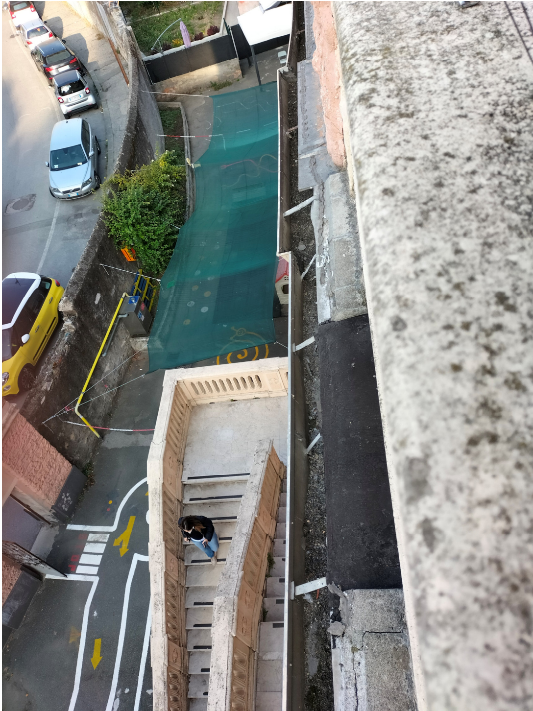
Foto n. 47 – Terrazzo secondo piano: dettaglio della gronda metallica in lamierino che dovrà essere sostituita e dettaglio del cornicione che deve essere restaurato
