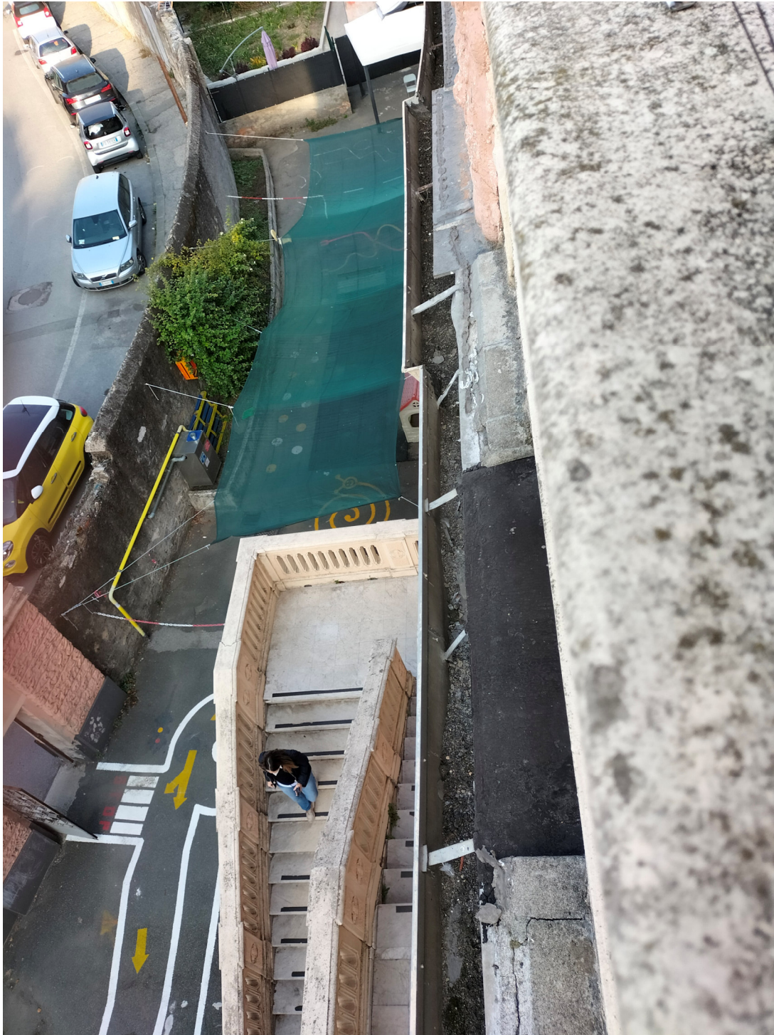
Foto n. 26 – Terrazzo secondo piano: dettaglio della gronda metallica in lamierino che dovrà essere pulita e riparata e dettaglio del cornicione che deve essere restaurato
