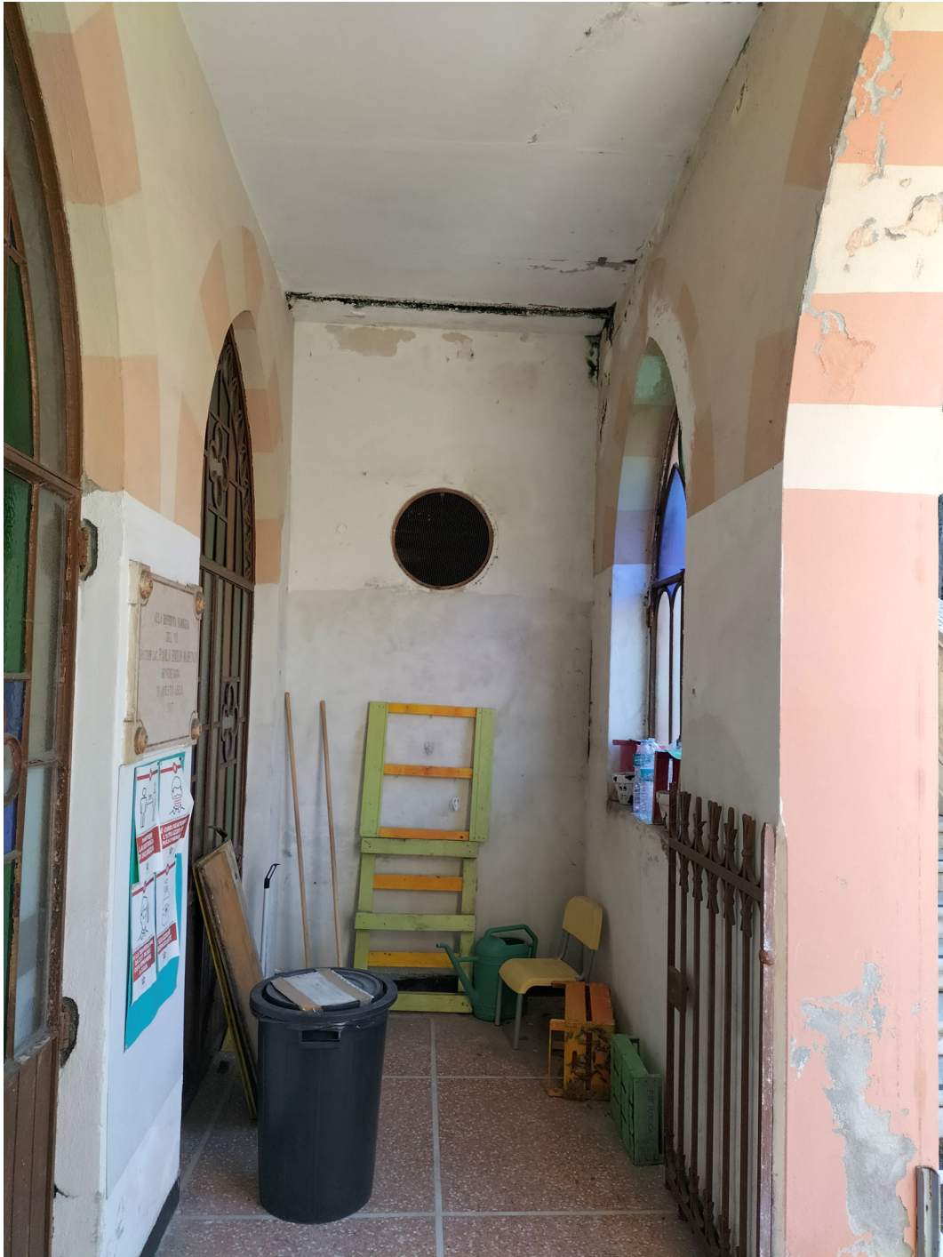
Foto n. 28 – Portico di ingresso piano terreno: dovranno essere risanati gli intonaci e le pitture di pareti e soffitti
