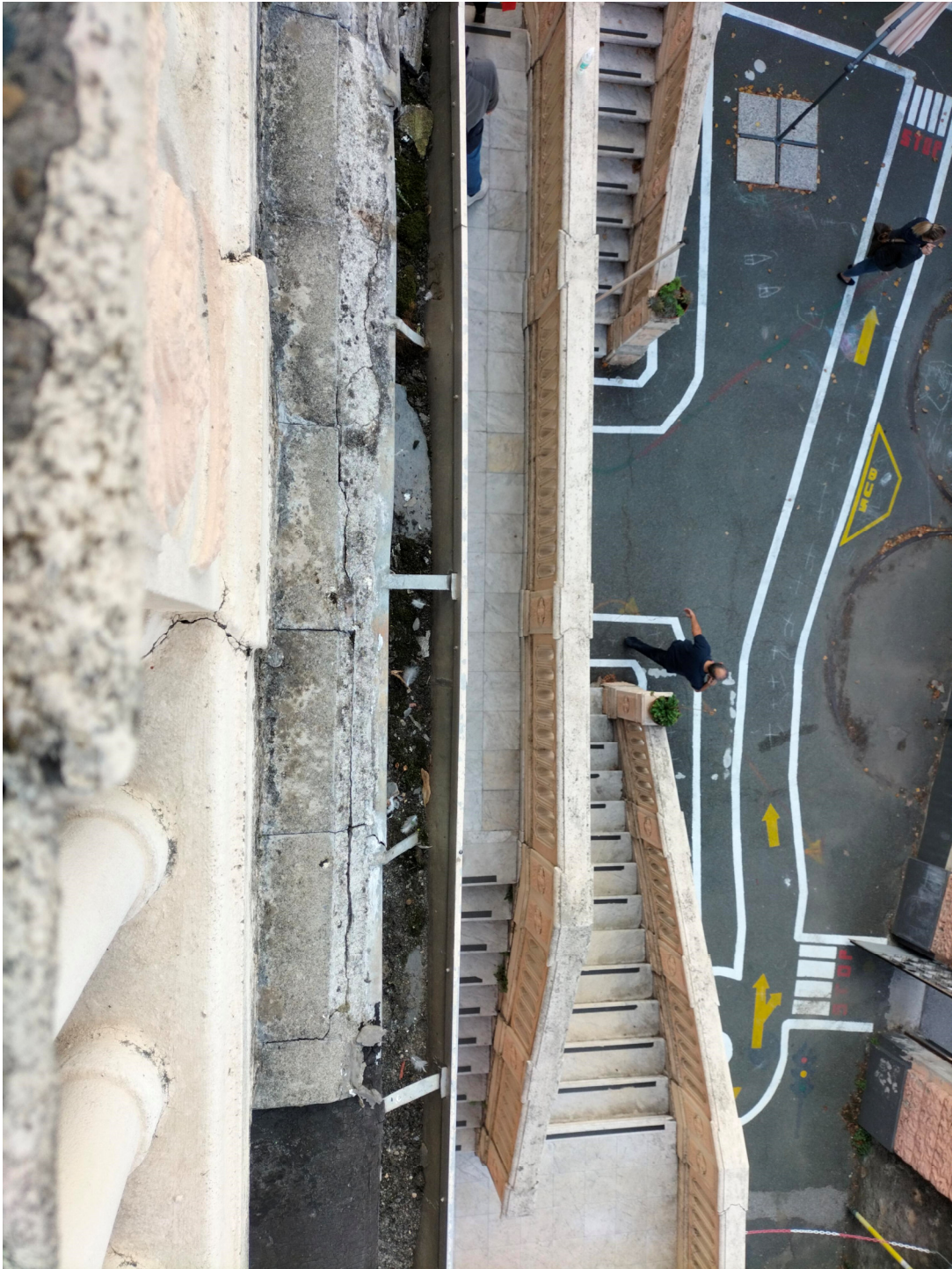
Foto n. 46 - Terrazzo secondo piano: dettaglio della gronda metallica in lamierino che dovrà essere sostituita e dettaglio del cornicione che deve essere restaurato
