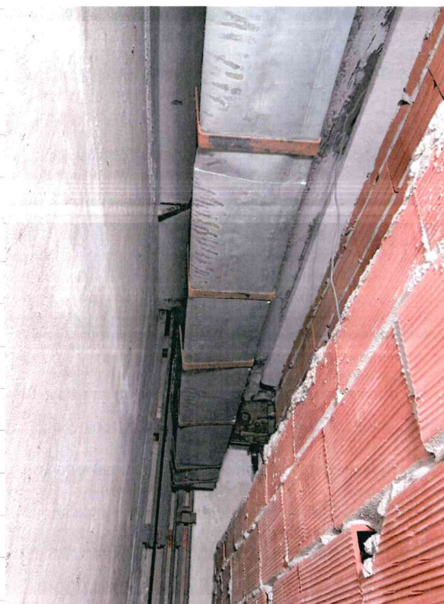
Dettaglio sistema saliscendi vetrate mobili emerso nel locale seminterrato del museo, sono visibili le coppie di binari per lo scorrimento delle vetrate verso il basso
