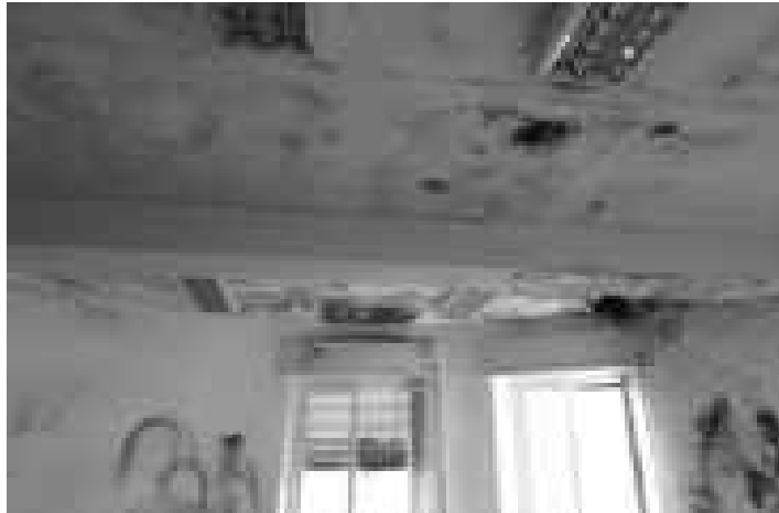
Foto25: Locale a piano primo con evidenti segni di infiltrazioni diffuse a parete e soffitto
