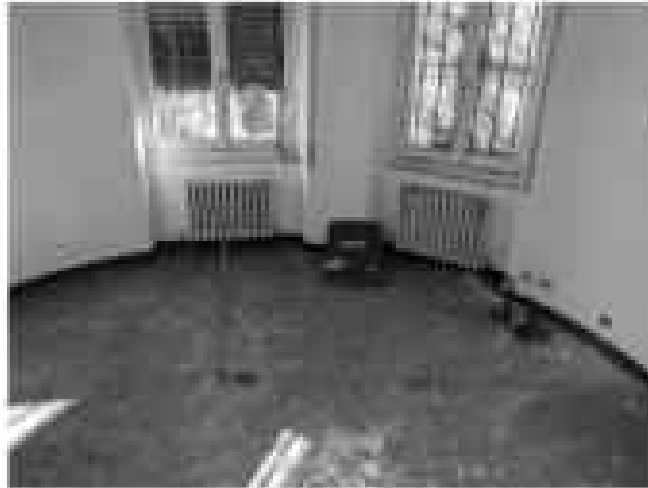
Foto18: Posizione del saggio eseguito a pavimento (R3), nella zona della lunetta anteriore
