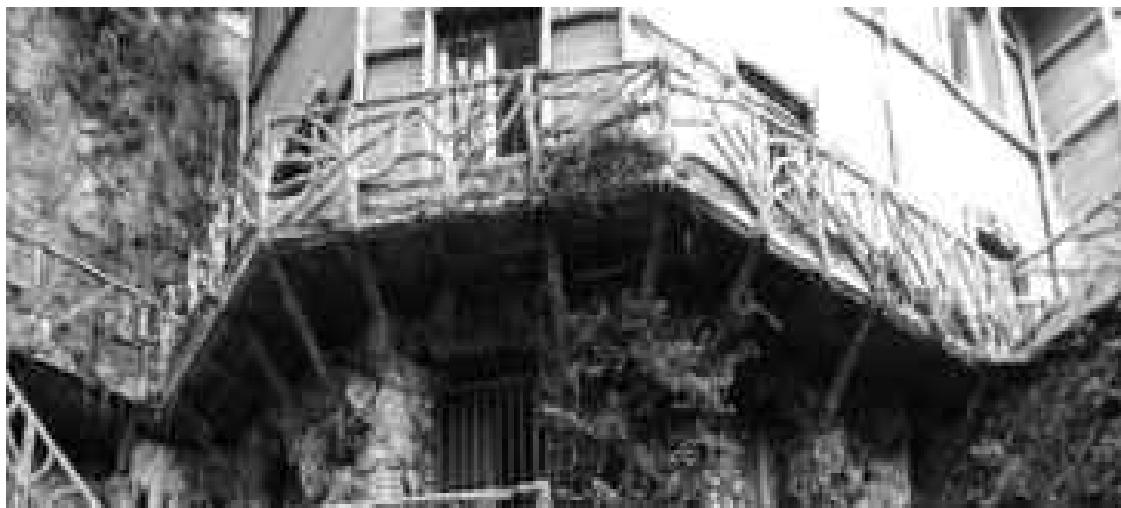
Foto38: Vista dal basso del ballatoio esterno a sbalzo con il cls dei puntoni sgretolato ed acciaio in pessime condizioni di conservazione
