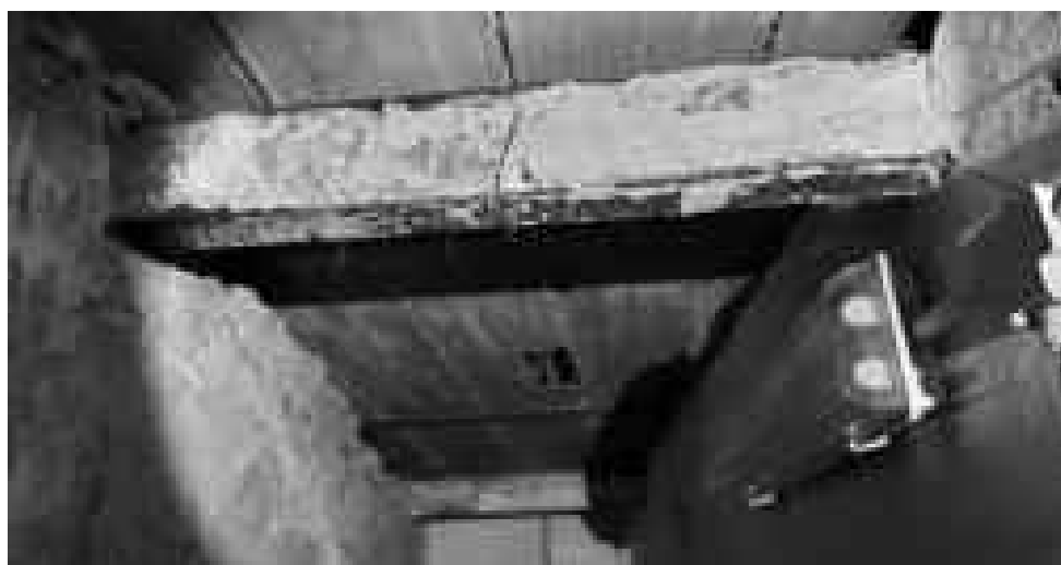
Foto10: Solaio sopra la scaletta di accesso con modesto sfondellamento
