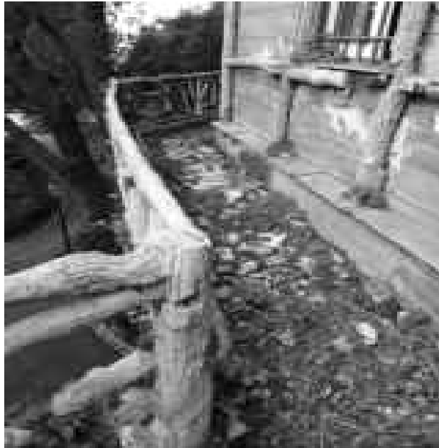
Foto37: Ballatoio esterno a sbalzo fortemente degradato nella struttura di sostegno
