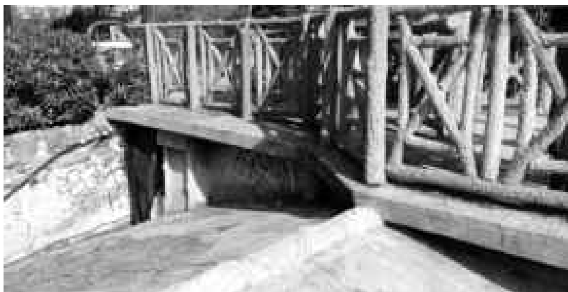
Foto48 e 48bis: Dettagli della soletta piana con il belvedere e delle falde di copertura con superficie di finitura rigata e con inserti effetto legno
