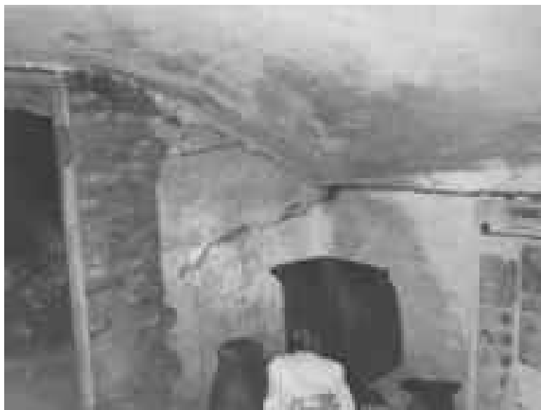
Foto 12: Foto delle numerose lesioni riscontrate
