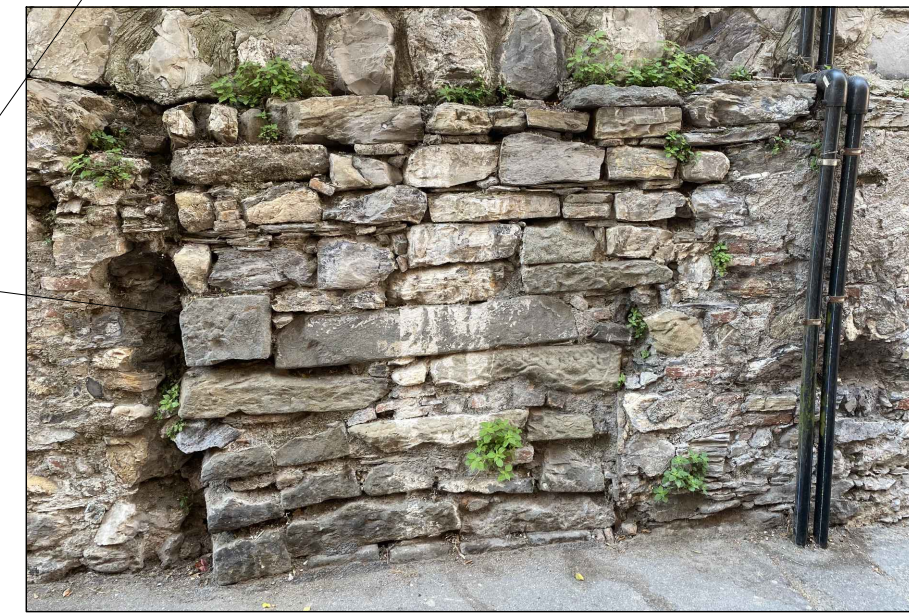
discontinuità fra le diverse murature
