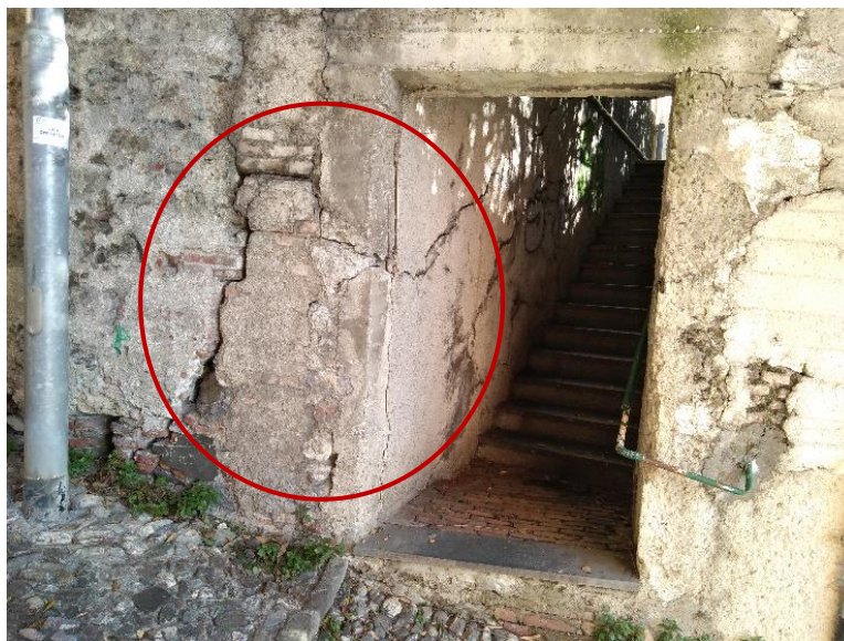
Foto 13: Vista della precedente lesione a lato del varco su salita della Montagnola ora risanato ma da verificare per il trattamento superficiale
