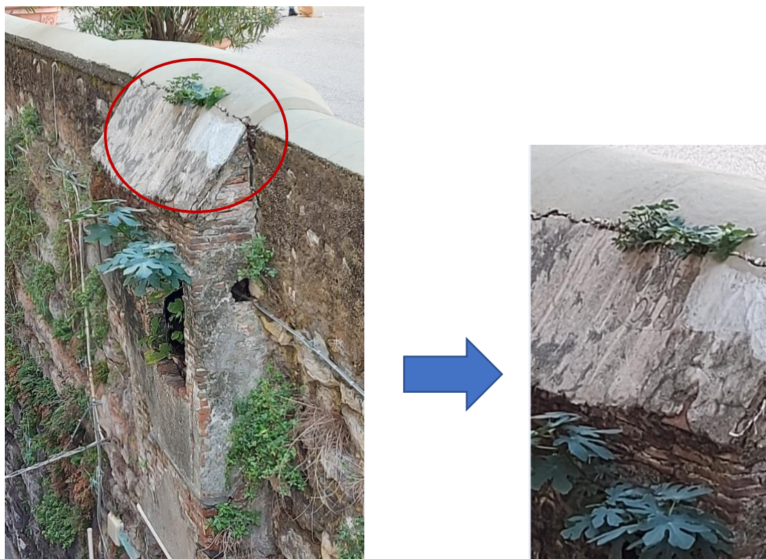
Foto 9: Vista laterale dell'aggetto e scollamento della parte superiore
