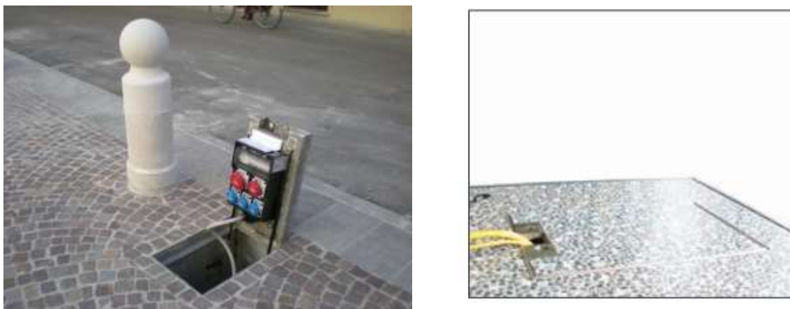
Figura 15 – Pozzetto prese in posizione aperta ed esempio indicativo quando chiuso con passaggio all'esterno dei cavi garantito (Fonte: GIFAS)
