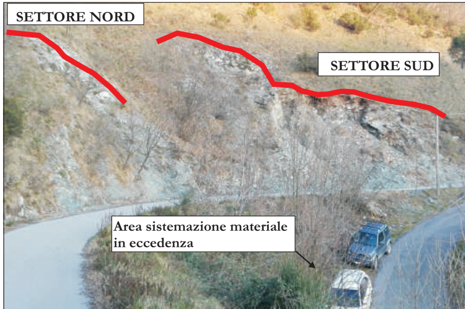
FOTO 1: Panoramica del dissesto 1 vista da Salita Tuvio
