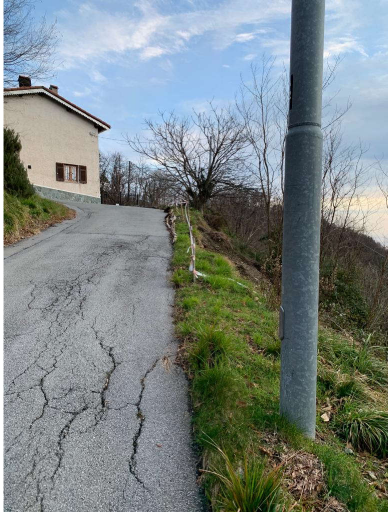
Foto 1 – frana da via San Pietro ai Prati
