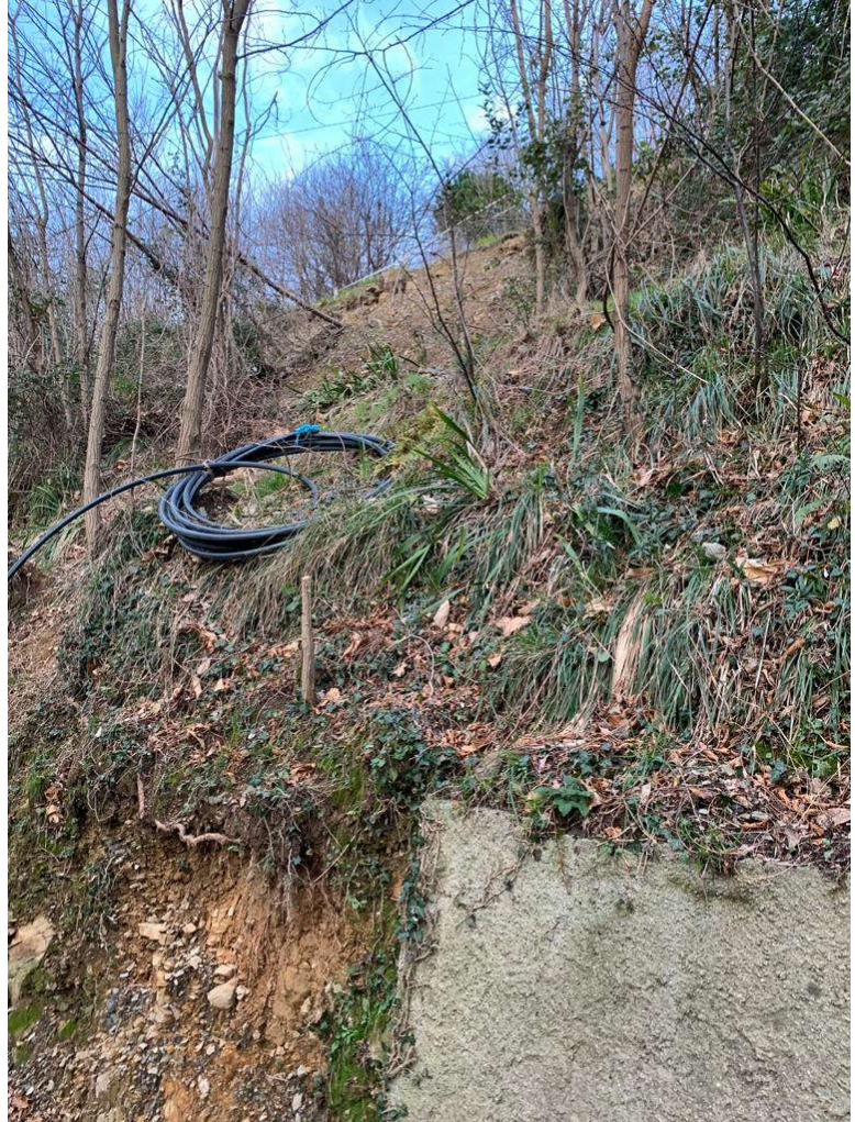
Foto 5 - frana da via San Pietro ai Prati
