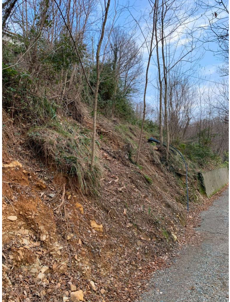
Foto 6 - frana da via San Pietro ai Prati
