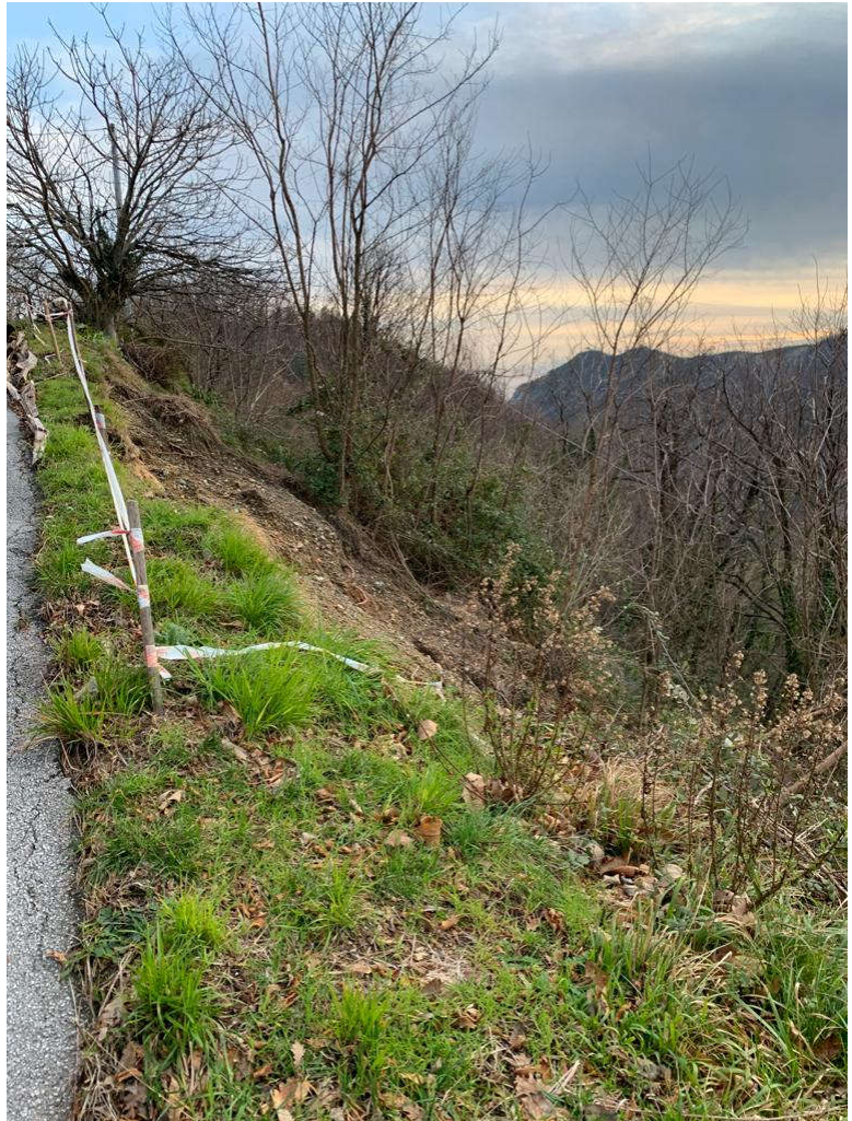
Foto 2 – frana da via San Pietro ai Prati
