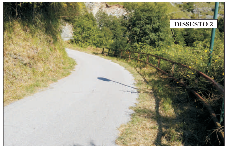
FOTO 8: Particolare del tratto di Salita Tuvio oggetto di realizzazione di dosso in terra sul lato valle per il convogliamento acque meteoriche lungo strada
