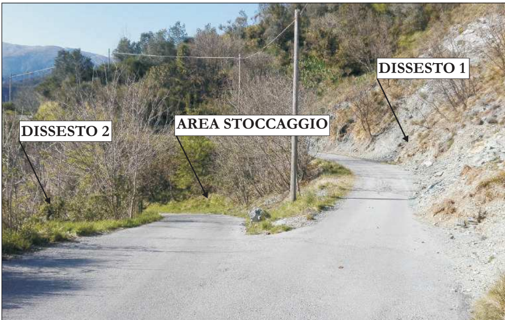
FOTO 3: Panoramica dissesto 1 -2 e area di stoccaggio
