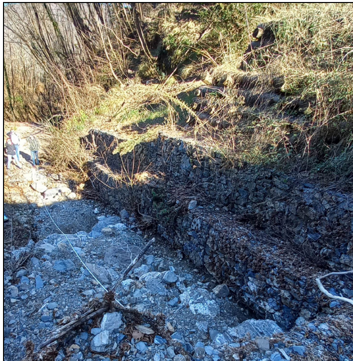
Foto 2: principio di sottoescavazione dei gabbioni tra le progressive P5 e P11
