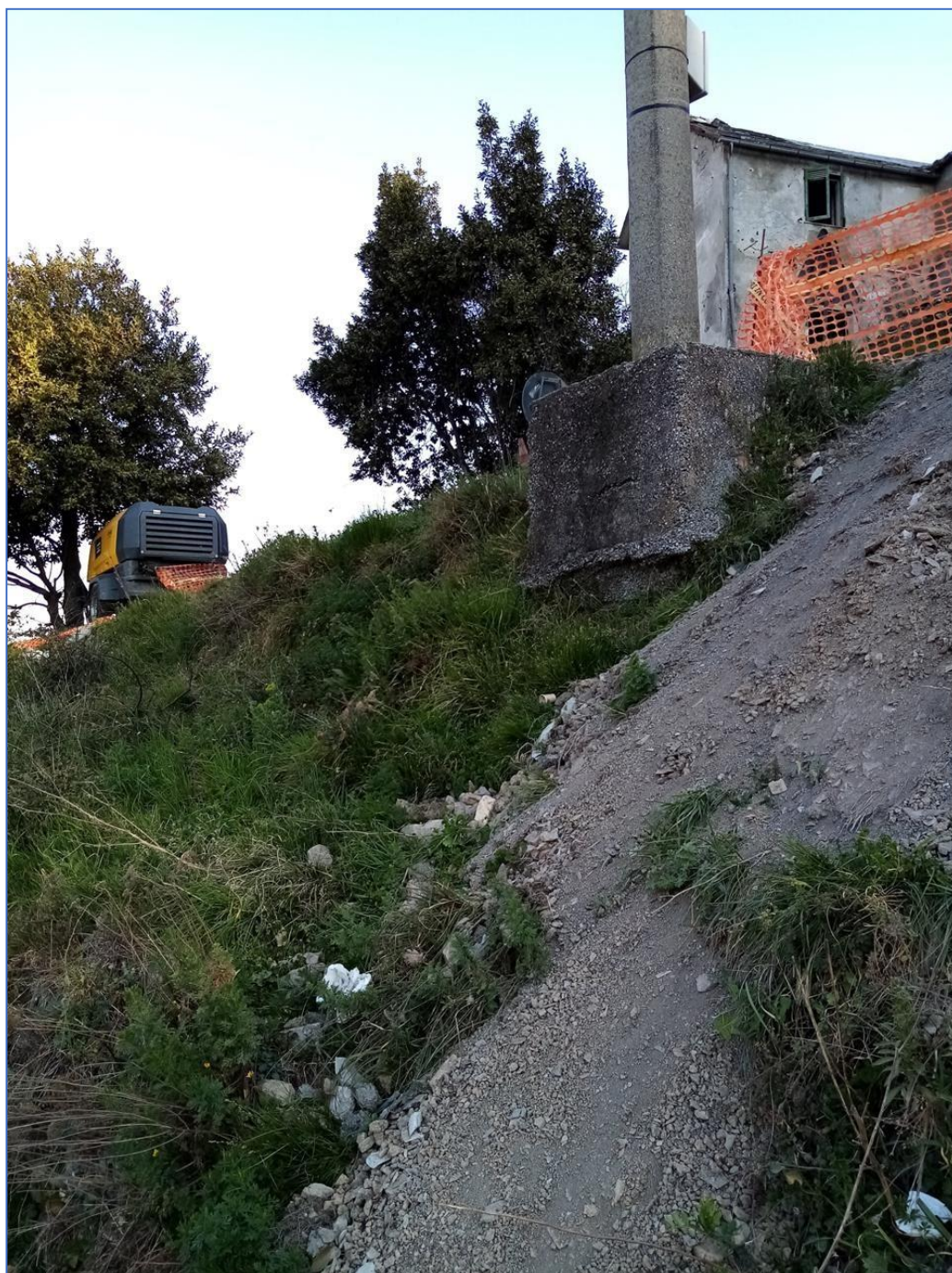
Figura 1 - Plinto del palo utenze con inizio sottoescavazione
