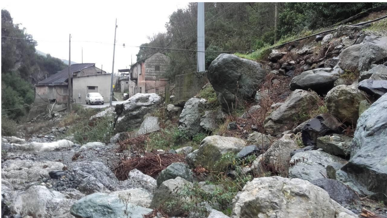
Figura 5: Tratto di sponda destra vista dall'alveo. Da notare l'inflessione della strada e la situazione dissestata dell'arginatura.
