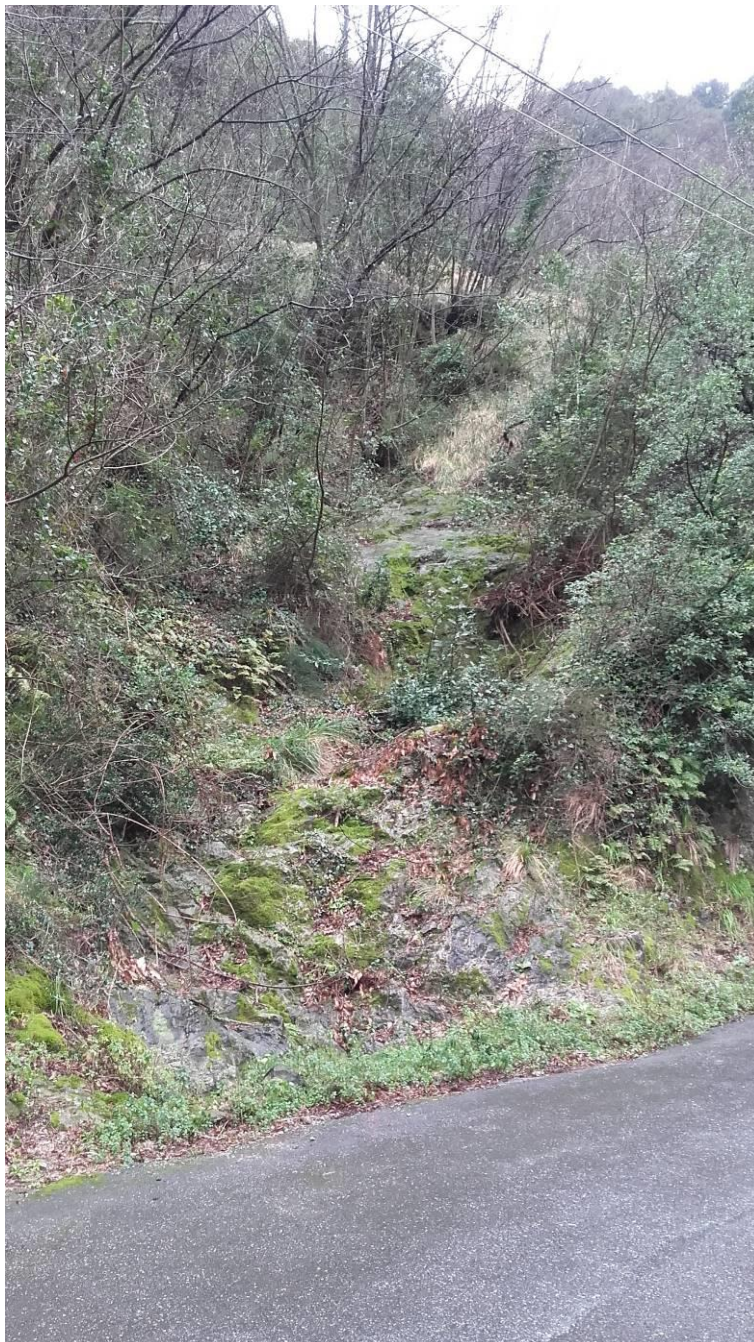
Figura 11: Versante in roccia a monte della Via Gneo che scarica acqua sulla strada durante gli eventi piovosi.
