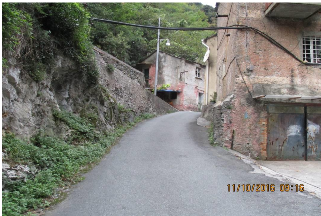
Figura 9: mancanza di regimazione lungo Via Gneo.
