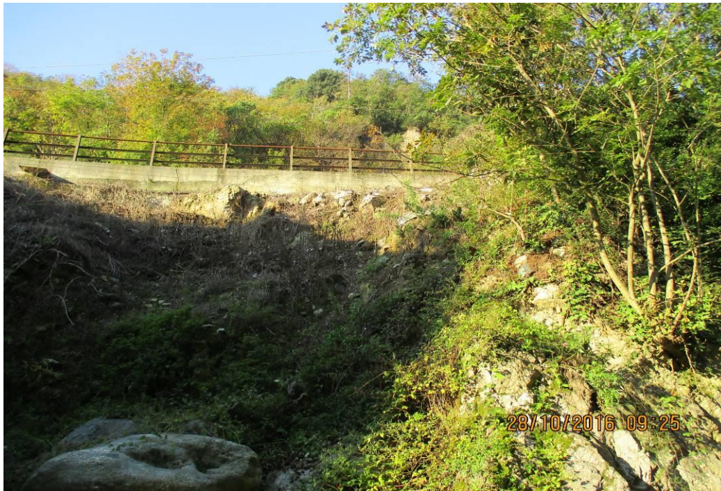
Figura 6: nicchia di dissesto sponda destra con evidenti fenomeni erosivi.
