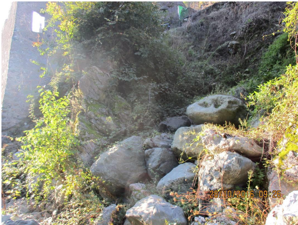
Figura 7: massi accatastati al piede del versante in erosione
