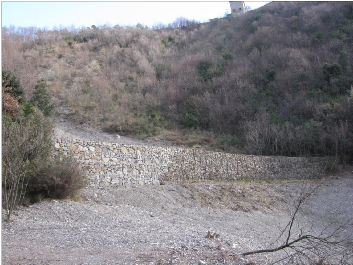
Figura 13 La briglia superiore realizzata in gabbioni in pietrame recentemente ripristinata dalla Società Italcementi
