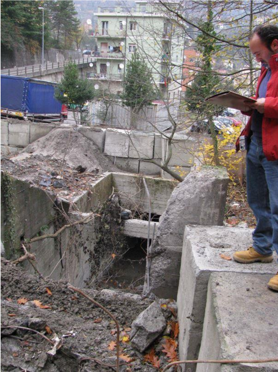
Figura 15: il ponticello crollato immediatamente a monte del tombino del rio tra l'inizio della pista sterrata che risale la valletta Brumà e Via Solimano
