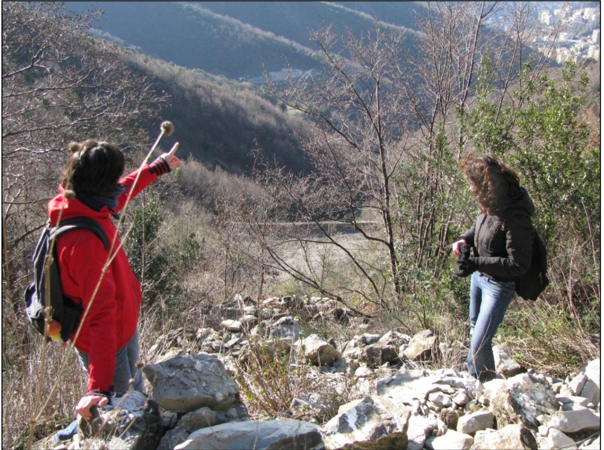
Figura 15 Zona precedente vista dall'alto verso il fondovalle: si notano i blocchi lapidei instabili
