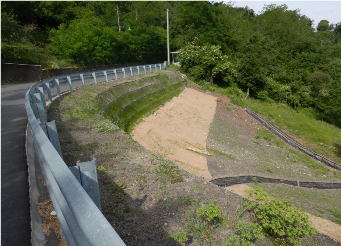
Figura 29: esempio di intervento con terre rinforzate eseguito dalla Direzione Idrogeologia e Geotecnica, Espropri e Vallate del Comune di Genova
