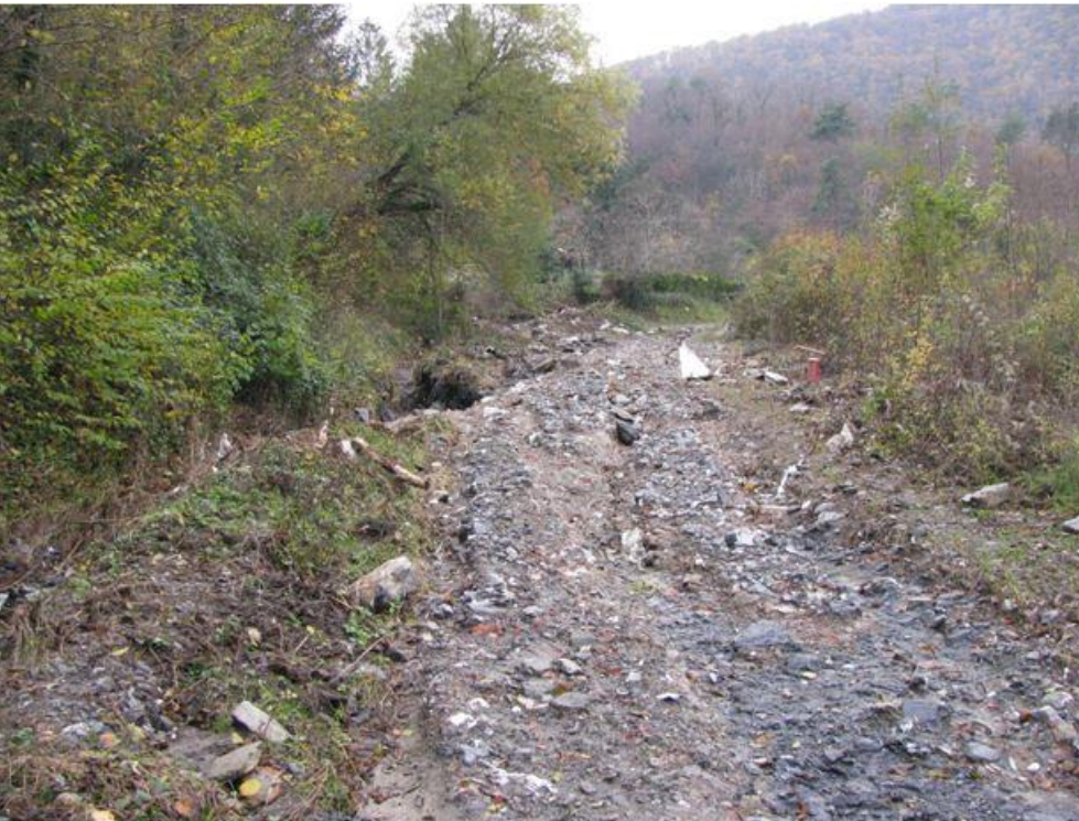
Figura 18: alcune foto del tratto mediano superiore sempre interessato da solchi di erosione superficiale
