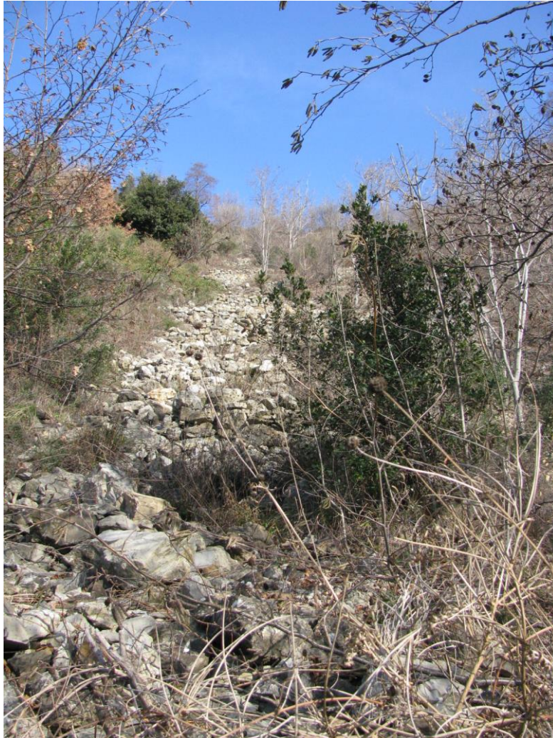
Figura 63 A monte della briglia superiore in gabbioni, anticamente erano state realizzate delle briglie in pietrame a salire verso la cava; nel tempo queste sono in gran parte collassate e attualmente costituiscono accumuli instabili che, in occasione di precipitazioni considerevoli, sono mobilizzati e danno luogo a frane in roccia.
