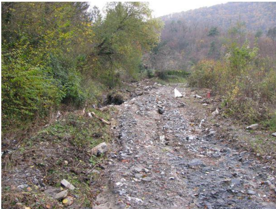
Figura 11: alcune foto del tratto mediano superiore sempre interessato da solchi di erosione superficiale
