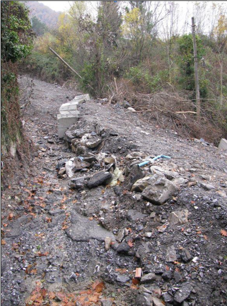
Figura 16: il primo tratto della pista sterrata che risale la valletta Brumà danneggiata dalle acque di scorrimento superficiale.
