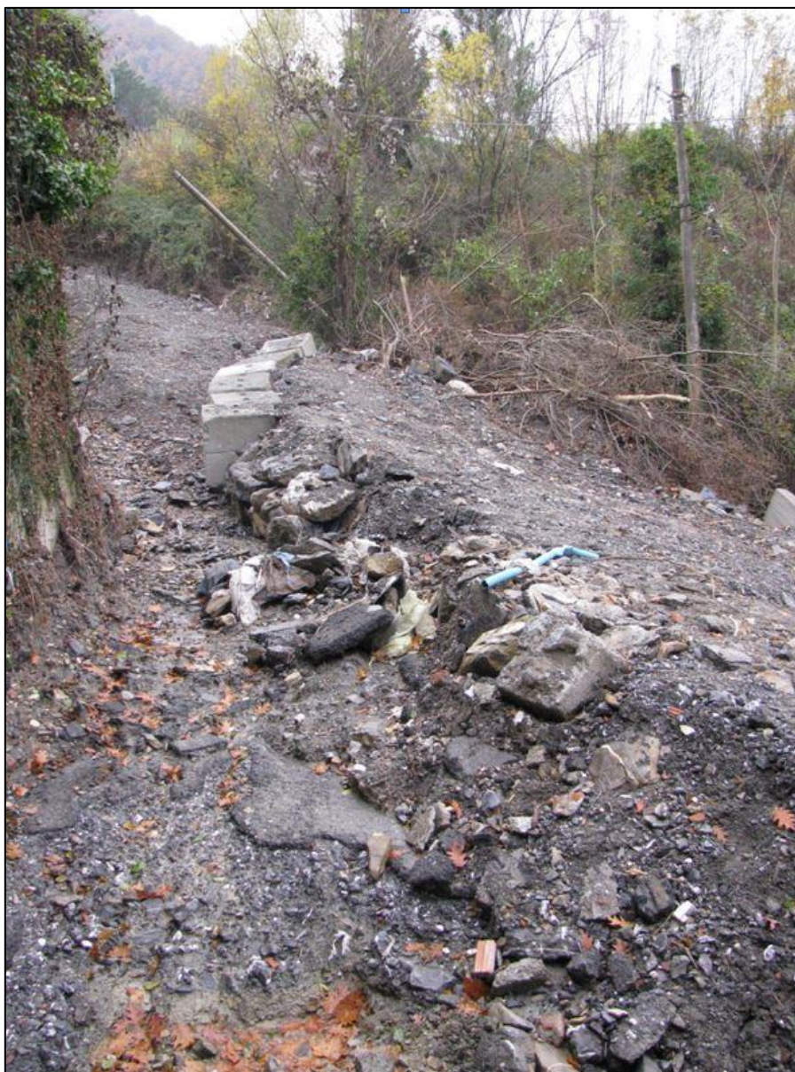
Figura 9: il primo tratto della pista sterrata che risale la valletta Brumà danneggiata dalle acque di scorrimento superficiale.
