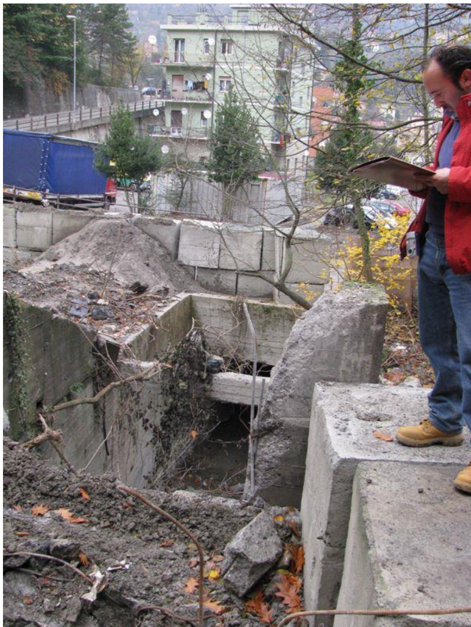
Figura 8: il ponticello crollato immediatamente a monte del tombino del rio tra l'inizio della pista sterrata che risale la valletta Brumà e Via Solimano.
